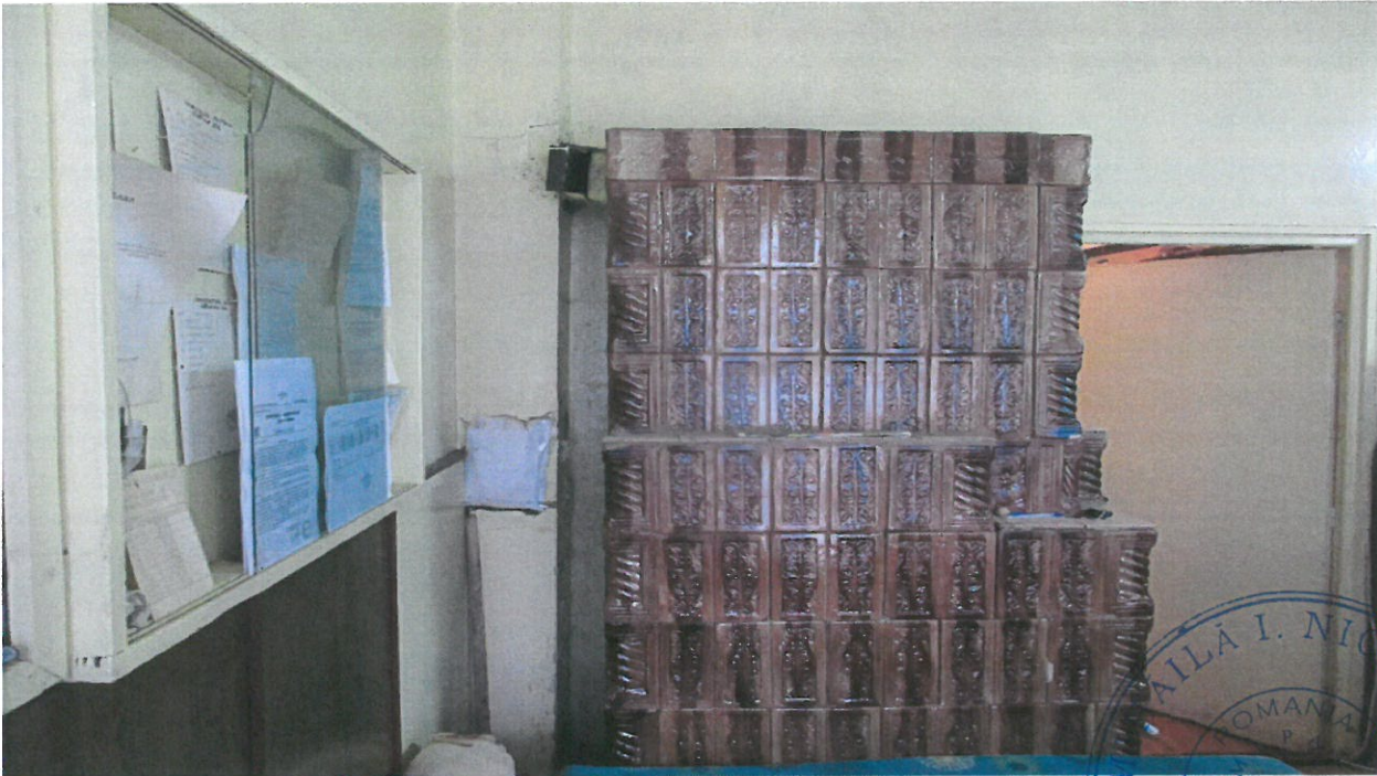
Fisuri în tencuială
