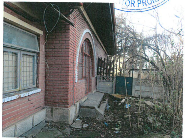
Foto 38 - degradari pe partea laterala a cladirii
