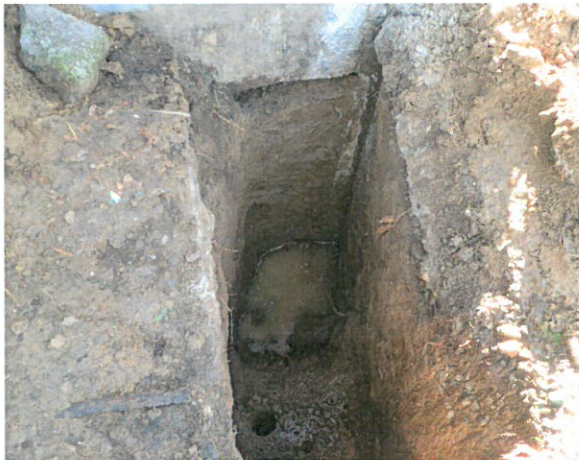
Foto 13 - vedere PVC 05-cu infiltratii de apa
