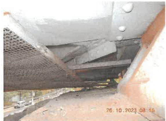
8. Vedere banchetă de rezemare culee. Plasa de protecție de la intradosul tablierului este ruginită. Elementele de fixare a acesteia de contravântuirea inferioară sunt desprinse.
