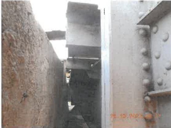
13. Detaliu zid de gardă culei (beton segregat, muchii ciobite, carbonatări)
