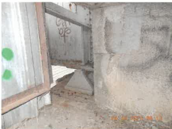
5. Vedere aparat de reazem fix. Vopsea de protecție exfoliată la talpa grinzii, pete de rugină. Betonul din zidurile întoarse ale culeei este degradat: carbonatări, segregări.
