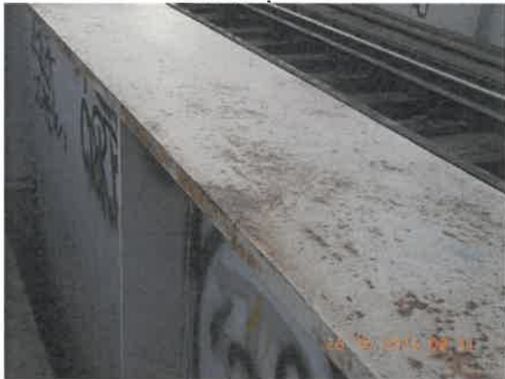
57. Suprafețe afectate de coroziune la talpa superioară a grinzii cu inimă plină.
