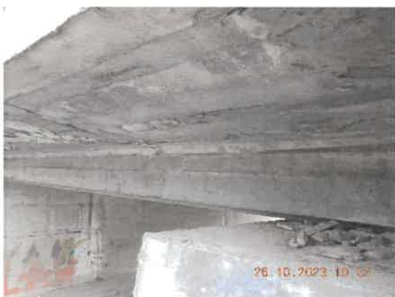
39. Beton exfoliat, segregat, în consola de trotuar. La intrados sunt prezente urme ale infiltrațiilor de apă.
