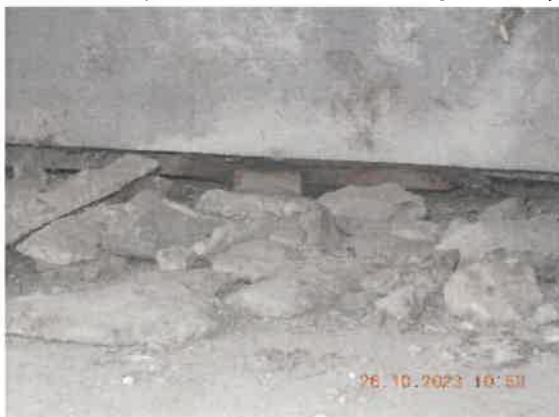
41. Bancheta de rezemare a culeei este acoperită cu bucăți de beton dislocat. Aparatele de reazem sunt afectate de coroziune.
