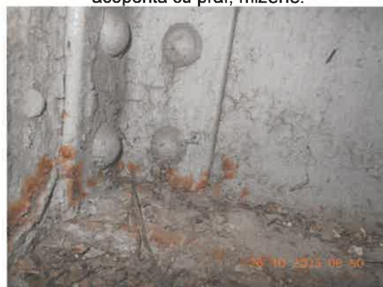
46. Coroziune avansată la îmbinarea între lonjeron și antretoază, cu reducerea grosimilor tablelor.
