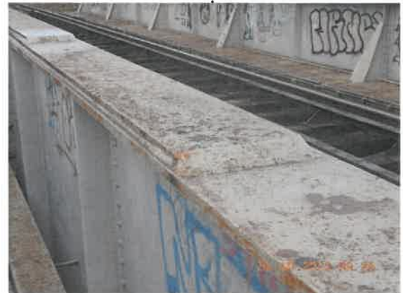
58. Suprafețe afectate de coroziune la talpa superioară a grinzii cu inimă plină, la nivelul celor 3 platbande
