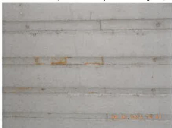
29. Infiltrații și coroziune la intradosul grinzilor metalice înglobate în beton.
