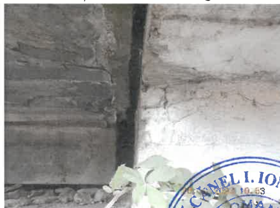
42. Beton exfoliat, segregat în consola de trotuar. Infiltrații în zona zidului de gardă. Armături la vedere și afectate de coroziune în consola trotuarului.
