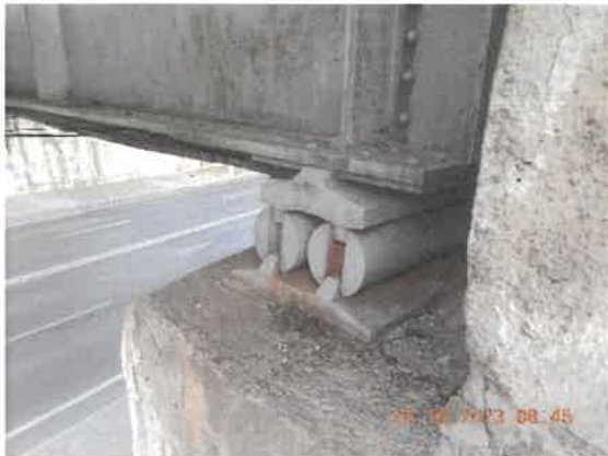
37. Vedere aparat de reazem mobil. Refularea plăcilor de plumb. Plăcile inferioare sunt afectate de coroziune. În zona panoului de capăt al grinzii inima acesteia este afectată de coroziune.
