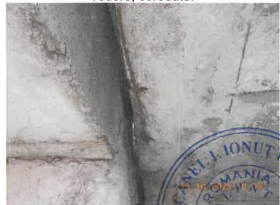
12. Armături fără strat de acoperire, afectate de coroziune. Beton segregat în zidul de gardă.
