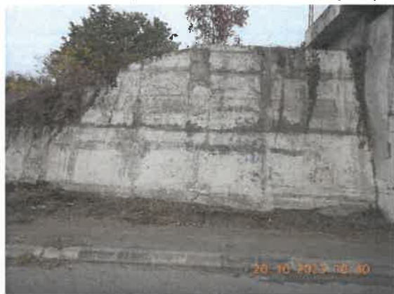
27. Degradări ale betonului din aripi: segregări, carbonatări. Aripile sunt acoperite de vegetație.
