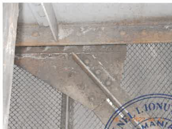
34. Detaliu guseu la nivelul contravânturii inferioare. Guseul și cornierele sunt afectate de coroziune și sunt acoperite cu mizerie.
