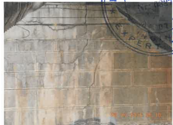
12. Vedere către culeea Giurgiu Frontieră. Fisuri și crăpături orizontale și verticale în cămășuiala elevației culeei. Crăpături ale banchetei cuzineților.
