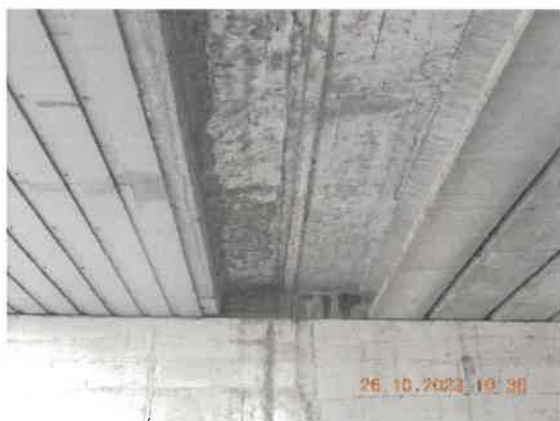
21. Infiltrații la consola trotuarului. Degradări ale betonului, armături la vedere și corodate.
