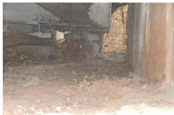
44. Vedere aparat de reazem mobil. Rulourile și plăcile aparatului de reazem sunt afectate de coroziune. Talpa inferioară a antretoazei prezintă zone cu coroziune accentuată. Bancheta culeei este acoperită cu praf, mizerie.
