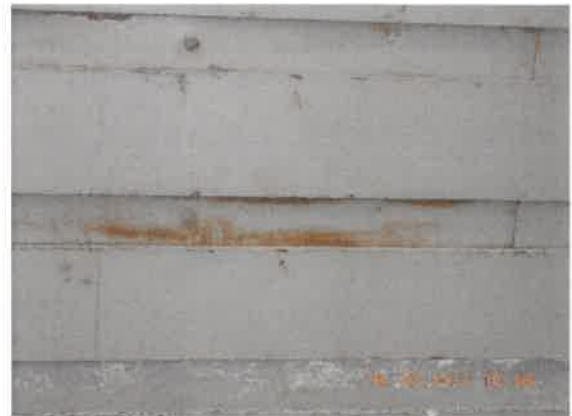
34. Infiltrații și coroziune la intradosul grinzilor metalice înglobate în beton.
