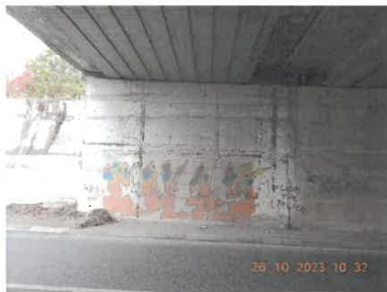
20. Betonul din elevația culei prezintă carbonatări și fisuri. Betonul din consola trotuarului este exfoliat.
