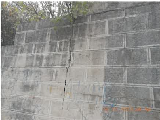
51. Fisuri și crăpături în betonul din cămășuiala elevației culeei și a zidurilor de sprijin
