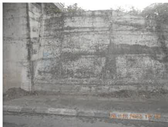
26. Degradări ale betonului din aripi: segregări, carbonatări. Aripile sunt acoperite de vegetație.
