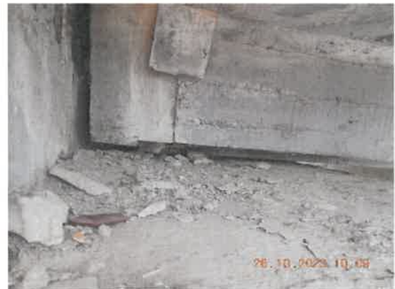
10. Betonul din bancheta de rezemare prezintă segregări. Muchiile sunt ciobite. Betonul din zidul de gardă este dislocat pe alocuri, armăturile sunt la vedere, corodate.
