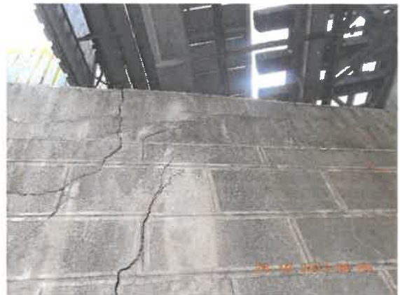
50. Fisuri și crăpături în betonul din cămășuiala elevației
