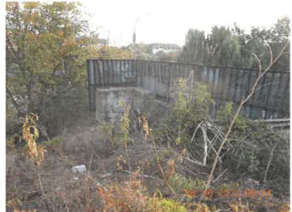
2. Vedere culee București. Vegetație crescută în spatele zidului de gardă. Carbonatări, muchii ciobite și armături la vedere și corodate
