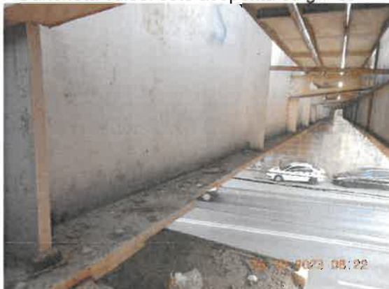
17. Vedere inimă și talpă inferioară grindă. Coroziune accentuată la inima grinzii cu afectarea grosimilor pieselor, depuneri de praf și mizerie pe talpa inferioară, pete de rugină atât la talpă cât și la inimă.
