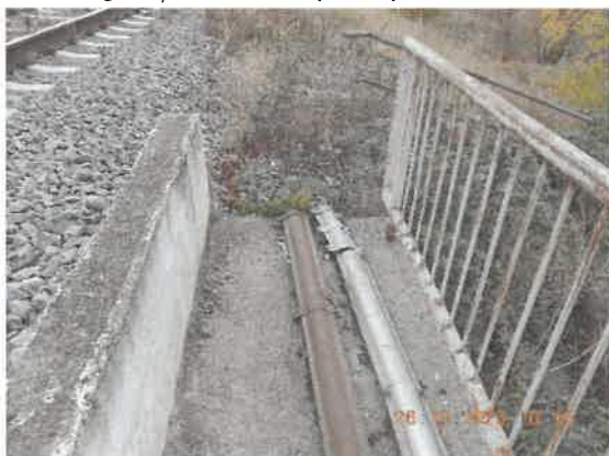
17. Betonul din opritorii prezintă segregări, muchii ciobite. Parapetul metalic este afectat de coroziune.
