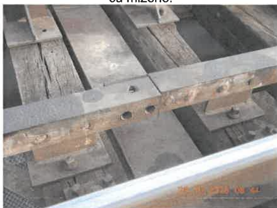
35. Deficiențe de prindere ale contrașinelor pe pod, lipsa elementelor de fixare.
