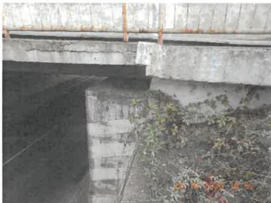
37. Beton segregat în zidurile întoarse ale culeei.
