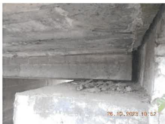
40. Beton exfoliat, segregat în consola de trotuar. Infiltrații în zona zidului de gardă.
