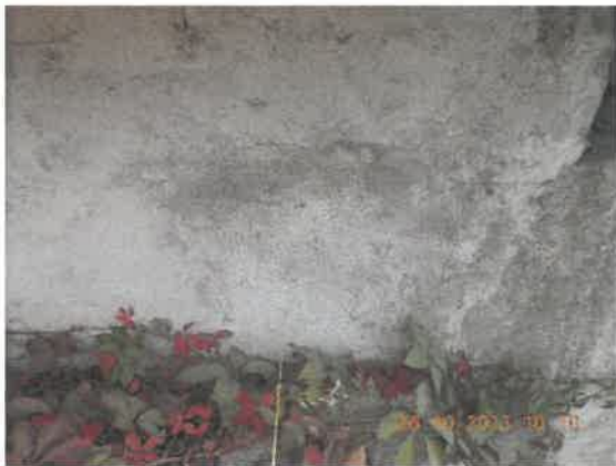
13. Fisuri în zidul întors al culeii. Vegetație crescută în zona aripilor.
