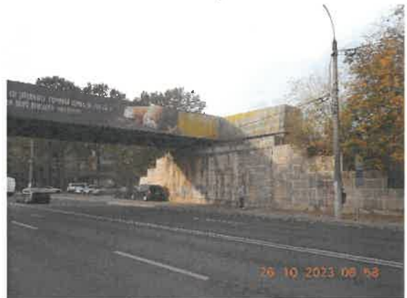
52. Segregări și carbonatări ale betonului, pete maronii.
