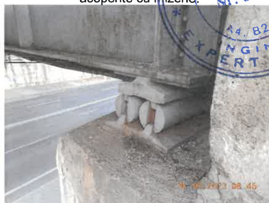
36. Vedere aparat de reazem mobil. Refularea plăcilor de plumb. Plăcile inferioare sunt afectate de coroziune. În zona panoului de capăt al grinzii inima acesteia este afectată de coroziune.
