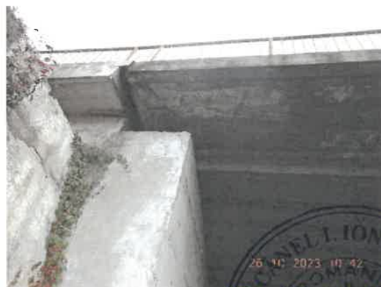
30. Degradări ale betonului în consola trotuarului: carbonatări, infiltrații.
