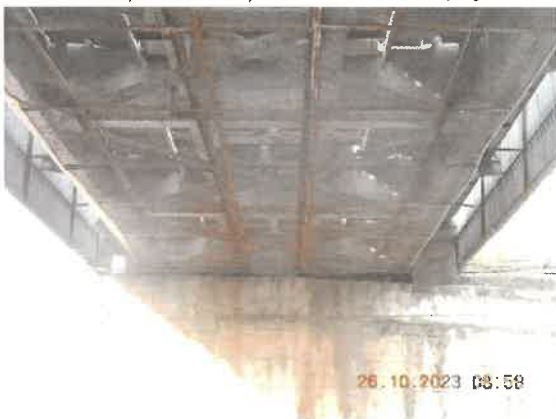
53. Plasa de protecție la intradosul tablierului este afectată sever de coroziune.
