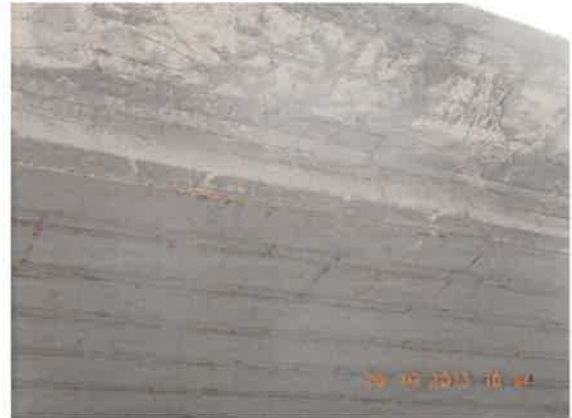
32. Infiltrații și coroziune la intradosul grinzilor metalice înglobate în beton.
