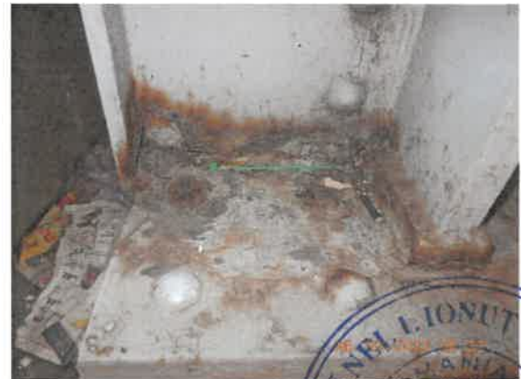
16. Vedere aparat de reazem fix. Coroziune accentuată la inima grinzii și rigidizarea de capăt în zona reazemului, cu afectarea grosimilor pieselor.
