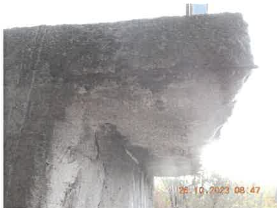
43. Consola de trotuar a zidului întors de la culee este degradată. La partea inferioară betonul este dislocat, armături sunt la vedere și sunt afectate de coroziune.
