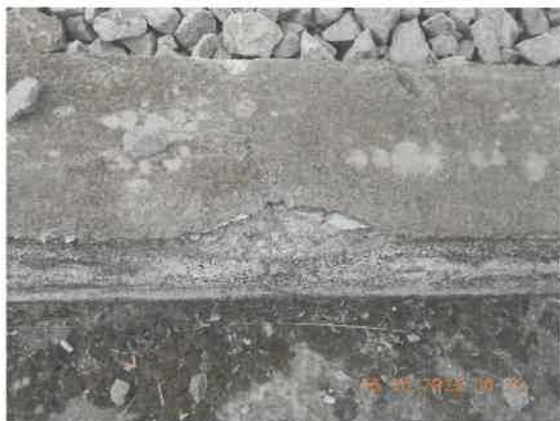
19. Beton dislocat din opritorul de piatră spartă.
