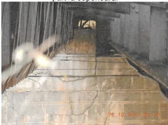
11. Vedere către culeea Giurgiu Frontieră. Fisuri și crăpături orizontale și verticale în cămășuiala elevației culeei. Crăpături ale banchetei cuzineților.
