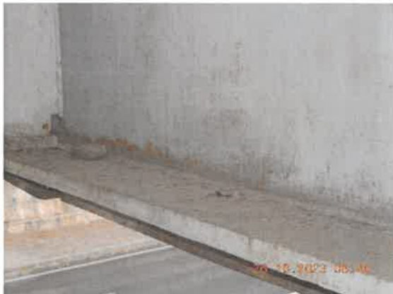
39. Vedere talpă inferioară a grinzii. Ca urmare a exfolierii vopselei de protecție zone extinse sunt afectate de coroziune.
