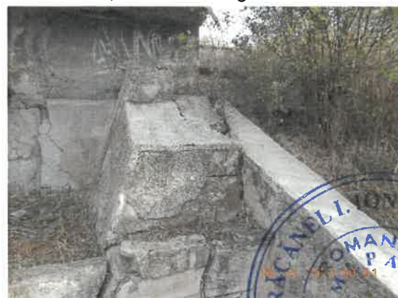
48. Beton degradat la zidul întors și la consola trotuarului: dislocări, segregări.
