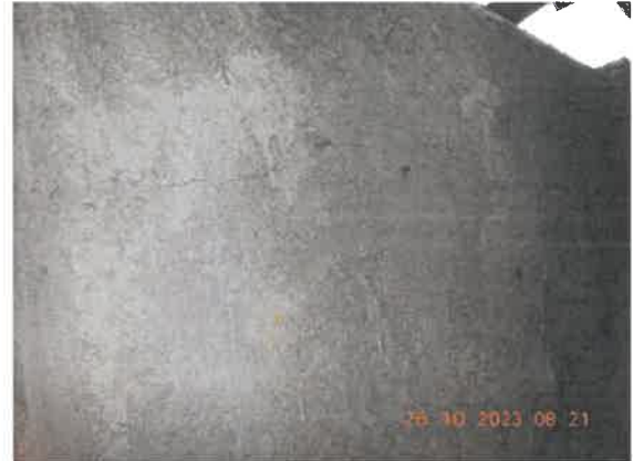
14. Detaliu zid de gardă culei (fisuri in beton, segregări)
