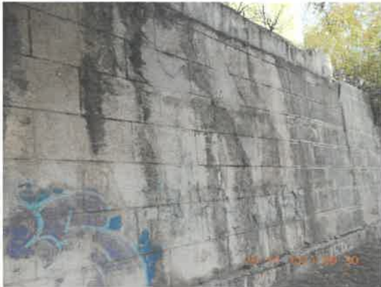
25. Fisuri orizontale și verticale în cămășuiala elevației și a zidurilor de beton. Muchii ciobite la nivelul banchetei de rezemare. Pe alocuri betonul este dislocat. Pete de culoare neagră pe elevație.
