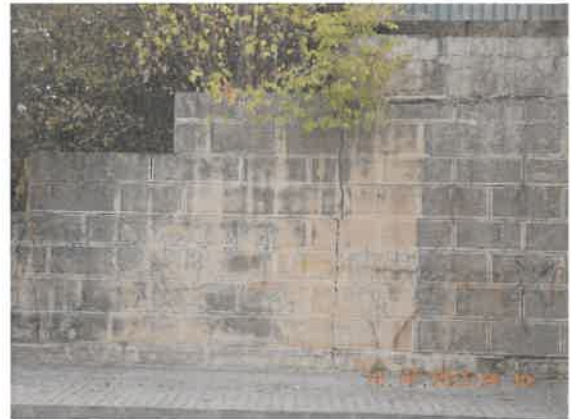
26. Fisuri orizontale și verticale în cămășuiala elevației și a zidurilor de beton. Muchii ciobite la nivelul banchetei de rezemare. Pe alocuri betonul este dislocat.
