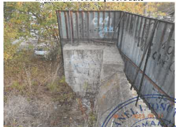
4. Culee București. Carbonatări, muchii ciobite și armături la vedere și corodate
