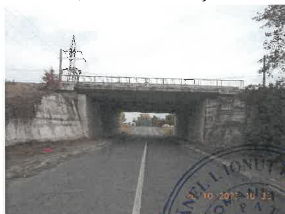
24. Degradări ale betonului din aripi: segregări, carbonatări. Aripile sunt acoperite de vegetație.
