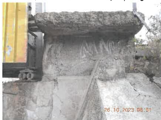
47. Beton degradat la zidul întors și la consola trotuarului: dislocări, segregări, armături la vedere.
