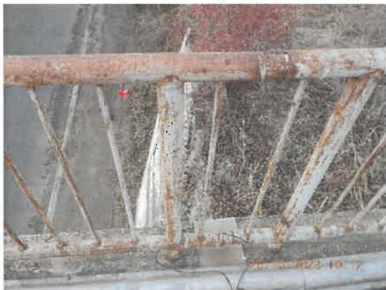
15. Parapetul metalic este afectat de coroziune. Vegetație crescută pe aripile culeelor.
