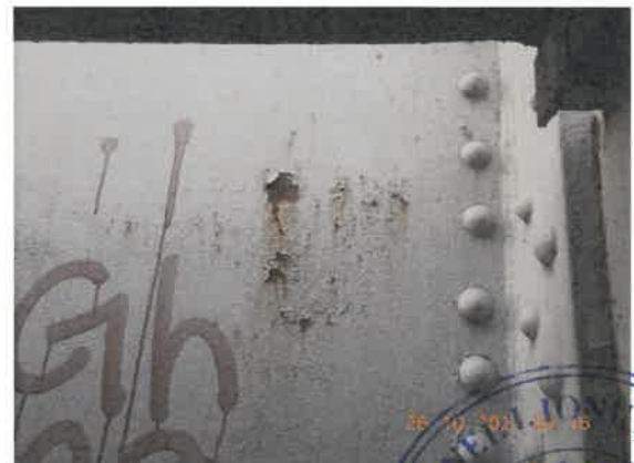
10. Vedere inimă grindă în zona de reazem. Vopsea de protecție exfoliată, pete de rugină.
