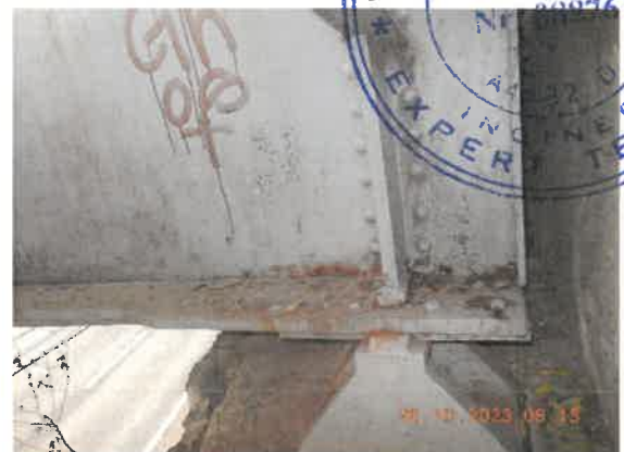
6. Vedere aparat de reazem fix. Vopsea de protecție exfoliată la talpa grinzii, pete de rugină. Muchii ciobite ale betonului la bancheta de rezemare a culeei.
