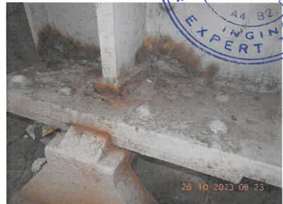
18. Vedere aparat de reazem fix. Coroziune accentuată la inima grinzii și rigidizarea de capăt în zona reazemului, cu afectarea grosimilor pieselor.
