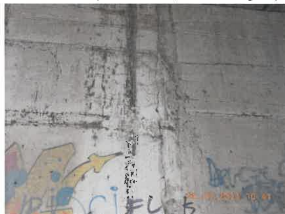
28. Betonul din elevația culei prezintă fisuri, carbonatări.
