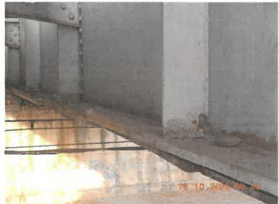
38. Vedere talpă inferioară a grinzii. Ca urmare a exfolierii vopselei de protecție zone extinse sunt afectate de coroziune, pe alocuri cu reducerea grosimii tablei.
