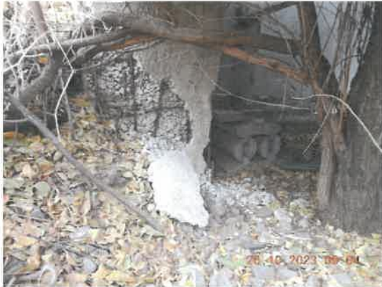
55. Beton degradat în zidul de gardă al culeei, armături la vedere și sever corodate. Copac crescut în zona banchetei și a trotuarului.
