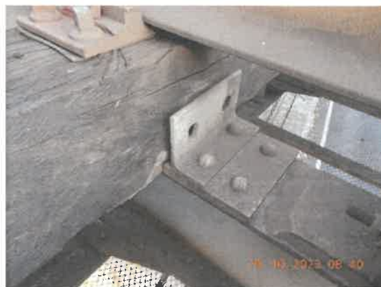
32. Fixarea traverselor pe talpa superioară a lonjeronilor este defectuoasă: lipsesc elementele de fixare.
