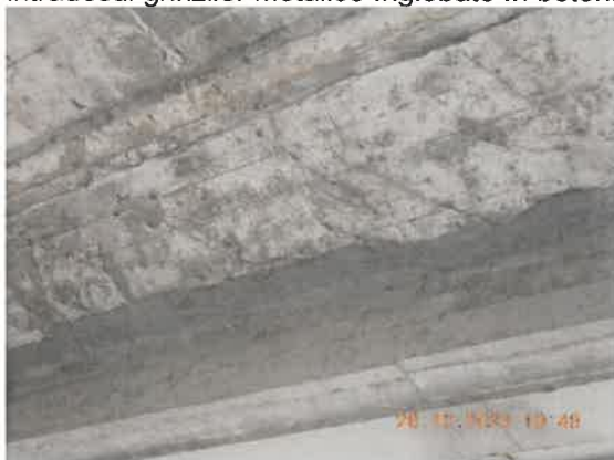
35. Segregări și carbonatări ale betonului din consola de trotuar.
