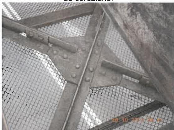
33. Vedere contravântuire inferioară. Guseul și cornierele sunt afectate de coroziune și sunt acoperite cu mizerie.
