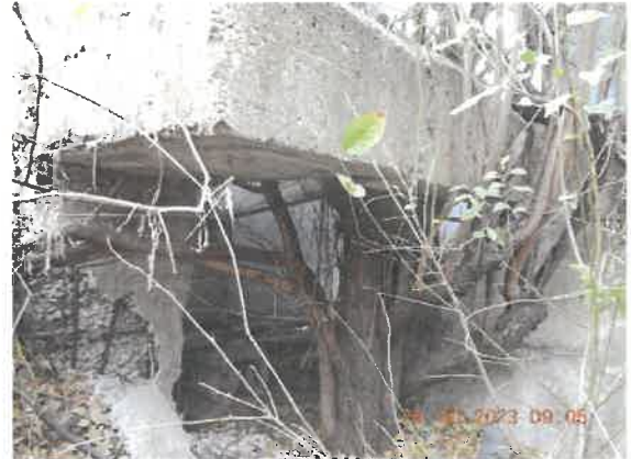
56. Beton degradat în zidul de gardă al culeei, armături la vedere și sever corodate. Copac crescut în zona banchetei și a trotuarului.
