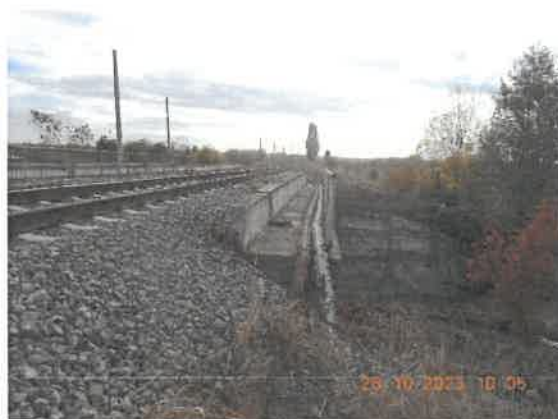
5. Betonul din opritorii de piatră spartă este segregat, cu muchii ciobite. În zona rostului de la culeea tabla de acoperire a rostului este degradată.
