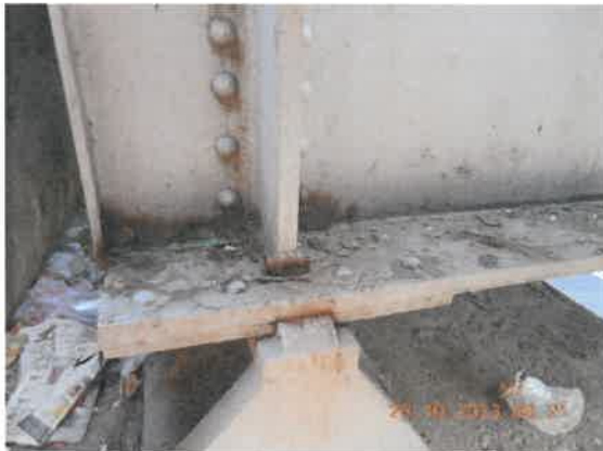
15. Vedere aparat de reazem fix. Coroziune accentuată la inima grinzii și rigidizarea de capăt în zona reazemului, cu afectarea grosimilor pieselor. Bancheta culei este acoperită cu gunoaie.
