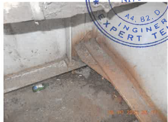
30. Vedere talpă lonjeron în zona banchetei de rezemare a culeei. Suprafețe extinse afectate de coroziune cu reducerea grosimilor tablelor.
