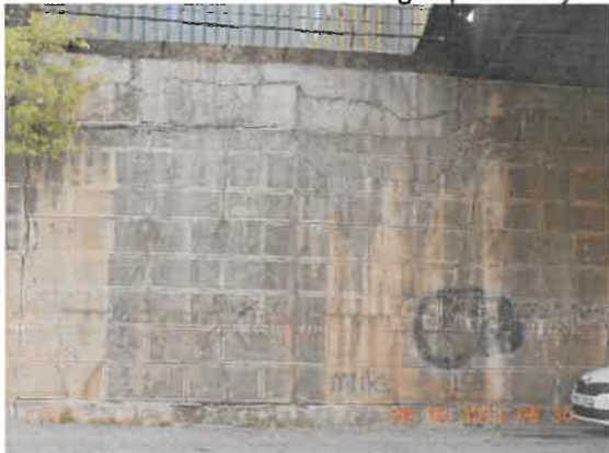
27. Fisuri orizontale și verticale în cămășuiala elevației și a zidurilor de beton. Muchii ciobite la nivelul banchetei de rezemare. Pe alocuri betonul este dislocat.
