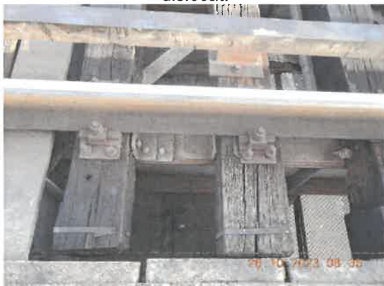
29. Traverse de lemn degradate, putrezite. Dispozitivele de fixare a șinei pe traverse sunt slăbite.
