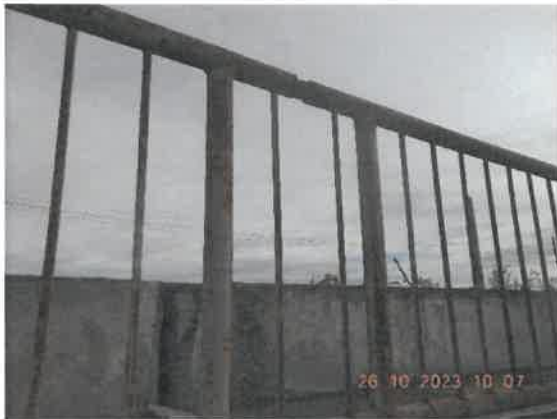
7. Parapetul metalic este afectat de coroziune.
