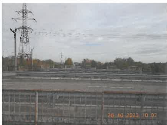
3. Parapetul metalic este afectat de coroziune.
