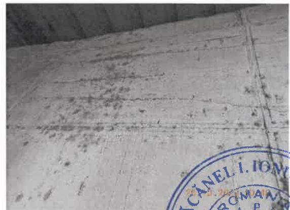
36. Segregări și fisuri ale betonului în elevația culeei. Pete de mușcați la suprafața elevației.
