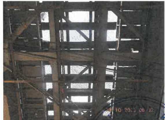
28. Vedere intrados tablier. Piasa de protecție este ruginită. Contravântuirea inferioară prezintă zone cu exfolieri la vopseaua de protecție și apariția ruginii.
