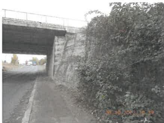
25. Degradări ale betonului din aripi: segregări, carbonatări. Aripile sunt acoperite de vegetație.
