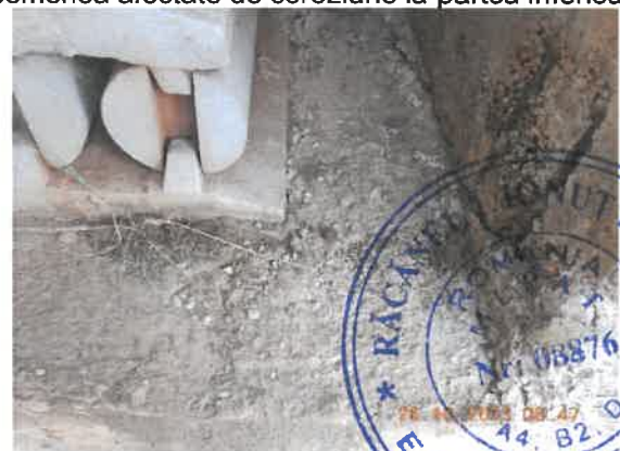
42. Vedere banchetă de rezemare culee, în zona aparatului de reazem mobil. Muchii ciobite, beton segregat, refularea plăcilor de plumb de la aparatul de reazem. Beton degradat în zidul de gardă al culeei, armături la vedere, corodate.
