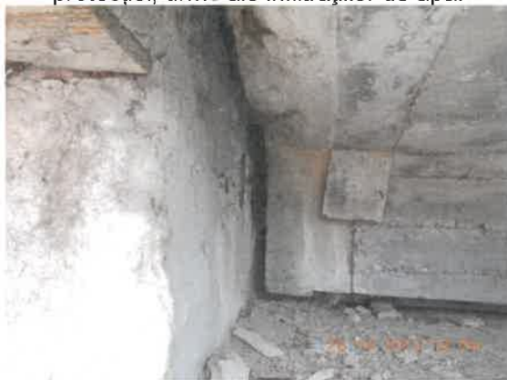
11. Betonul din bancheta de rezemare prezintă segregări. Muchiile sunt ciobite. Betonul din zidul de gardă este dislocat pe alocuri, armăturile sunt la vedere, corodate.
