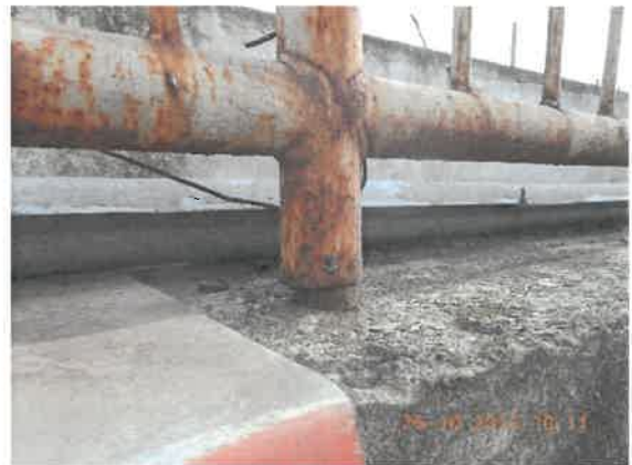
14. Parapet metalic degradat, afectat de coroziune. Lipsa elementelor de fixare a parapetului.
