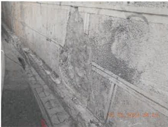
49. Dislocări ale betonului în culee, tencuială desprinsă.
