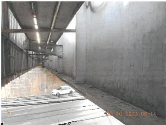
7. Vedere în lungul tablierului către București. Exfolieri ale vopselei de protecție la talpa inferioară a grinzii, depuneri de praf, pete de rugină. Plasa de protecție de la intradosul tablierului este desprinsă în anumite puncte.
