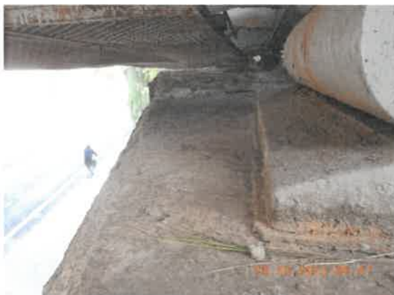
41. Vedere banchetă de rezemare culee, în zona aparatului de reazem mobil. Muchii ciobite, beton segregat, refularea plăcilor de plumb de la aparatul de reazem.
