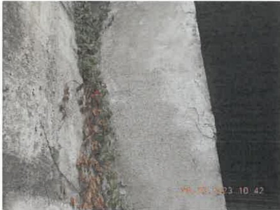
31. Segregări ale betonului din aripi și elevația culeei, muchii ciobite.
