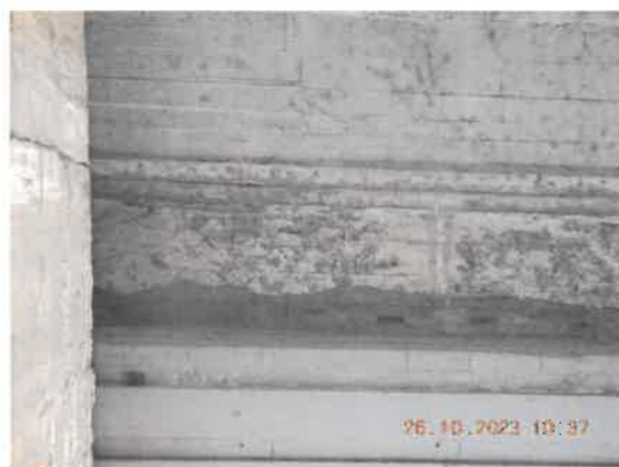
22. Infiltrații la consola trotuarului. Degradări ale betonului, armături la vedere și corodate.
