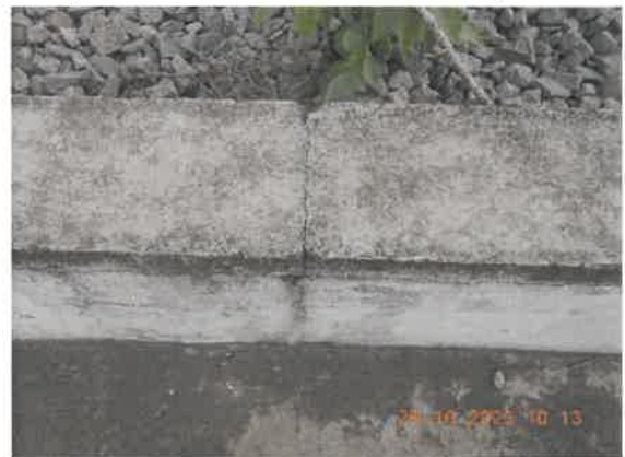
16. Opritorii de piatră spartă sunt fisurați.
