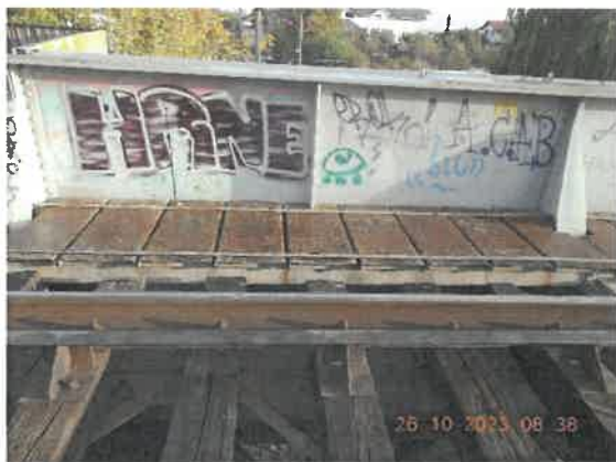
31. Apariția ruginei la talpa superioară a grinzii, în zona modificării secțiunii acesteia, la contactul între cele două platbande. Dulapii de trotuar sunt afectați de coroziune.
