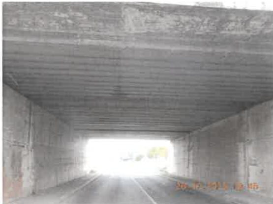
33. Betonul din elevația culeei este degradat prin carbonatare și segregare. Infiltrații și coroziune la intradosul grinzilor metalice înglobate în beton.
