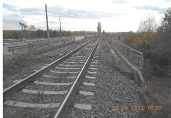
4. Parapetul metalic este afectat de coroziune. Betonul din opritorii de piatră spartă este segregat, cu muchii ciobite.
