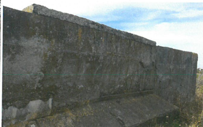
FOTO 9 Vedere timpan cu beton degradat, cu crăpături și fisuri
