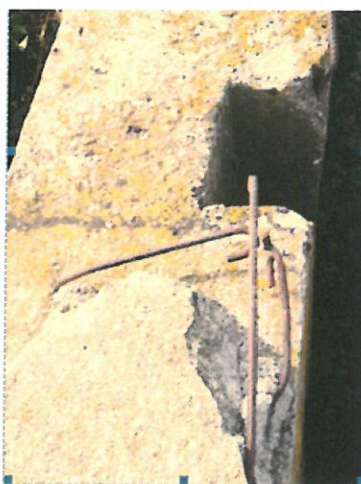
FOTO 11 Armături la vedere
