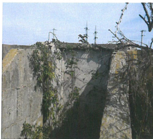
FOTO 10 Porțiuni din beton dislocate
