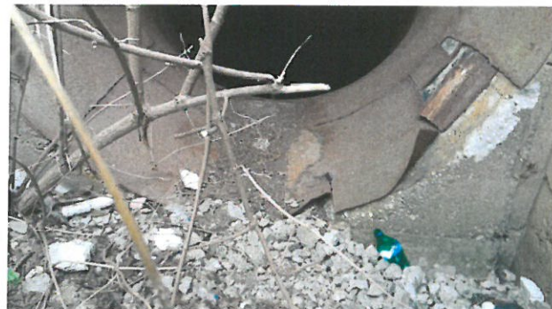
FOTO 7 Tabla deteriorată în tubul canalului
