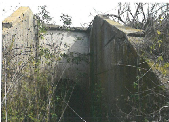
FOTO 2 Vedere intrare podeț. Aripi degradate, cu crăpături
