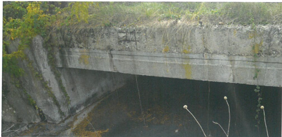
FOTO 4 - Eroziuni ale betonului grinzii de parapet aval
