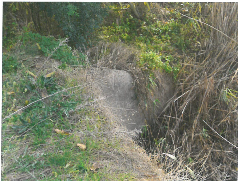
FOTO 7 – Aripile din beton invadate de vegetație
