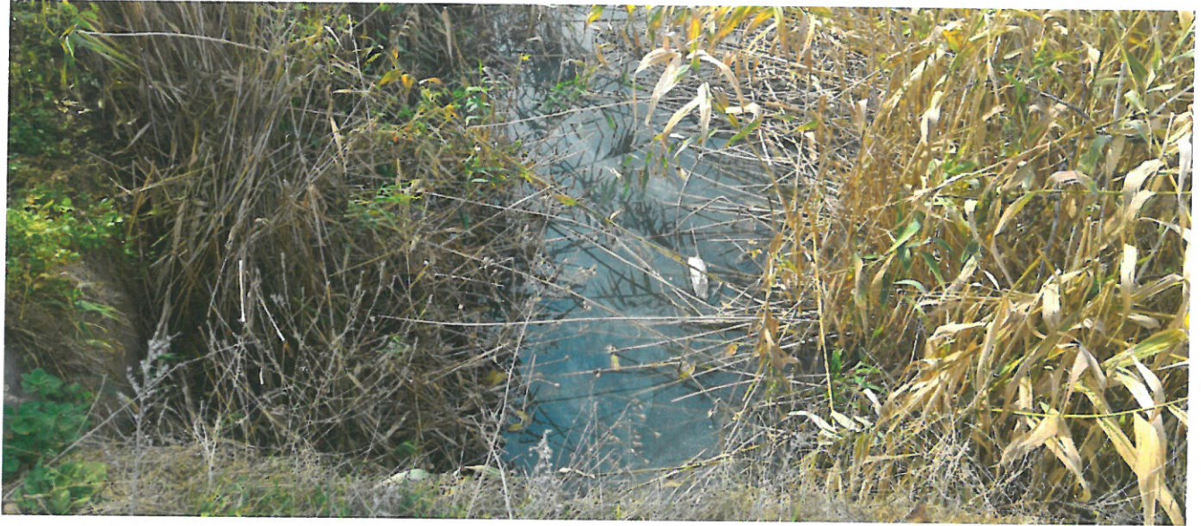
FOTO 8 - Albie neamenajată și colmatată cu depuneri și vegetație
