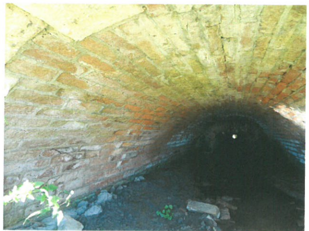
8. Vedere interior podeț dinspre aval (cărămizi degradate, colmatare podeț, etc)
