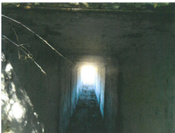
6. Vedere interior podet dinspre amonte (armătura descoperită, beton cu fisuri, pereu, etc)
