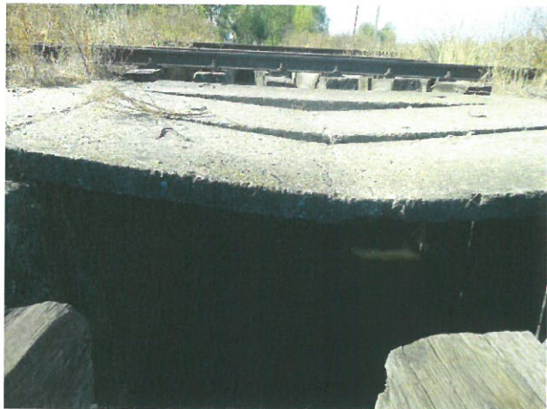
7. Vedere al doilea pachet de placi din beton dinspre aval (plăci degradate), albie
