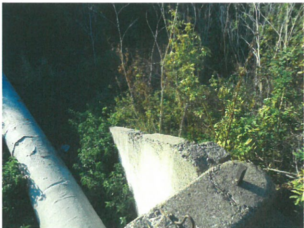
5. Vedere podet, spre amonte (degradarea aripilor prefabricate de tip A3 și a timpanului prefabricat tip T3)
