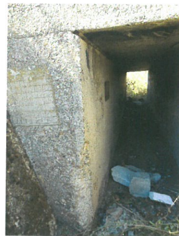
8. Vedere culee Giurgiu și intrados dală (beton cu crăpături, muchii degradate, beton segregat, etc.)
