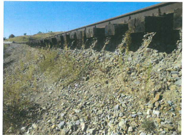
10. Terasament degradat în zona traverselor de lemn
