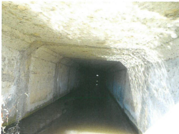
9. Vedere interior podeț dinspre aval (beton cu reparații, rost dintre tronsoane remediat, colmatare podeț, etc.)
