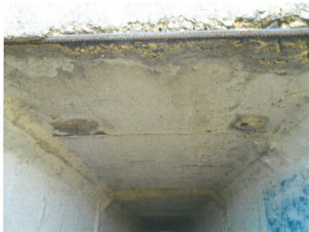
8. Degradare tronson prefabricat marginal C1 (armături descoperite și corodate, pete de rugină, crăpături, etc.)
