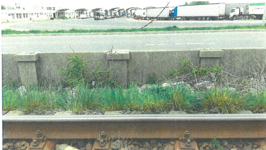
3. Vedere podeț spre aval. Podețul este în totalitate desființat.
