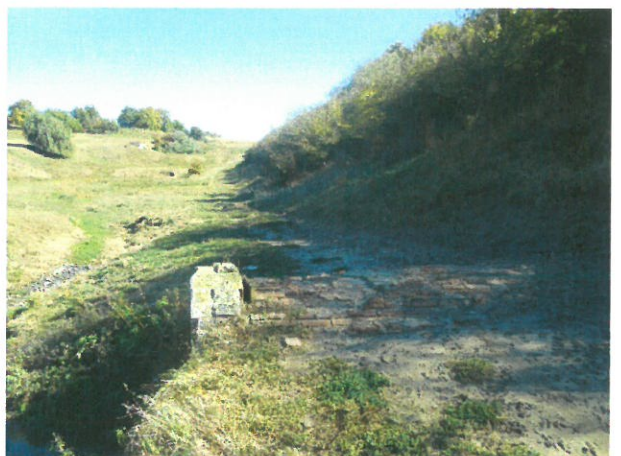
4. Vedere drum local de pământ; degradare boltă la partea superioară
