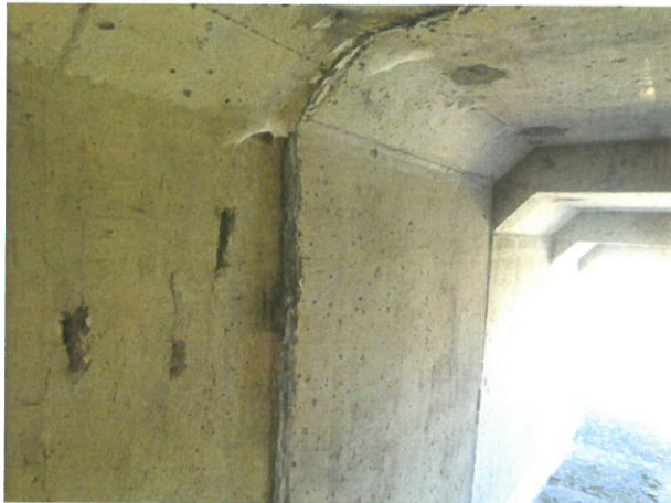
9. Degradări tronsoane prefabricate tip C2 (armături descoperite și corodate, mortarul de la rost degradat, mici fisuri, etc.)
