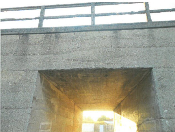
5. Vedere interior podet dinspre stânga (beton cu crăpături, segregări beton, parapet degradat, etc.)
