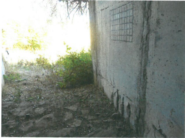
9. Degradări la baza tronsoanelor de prefabricate tip C2 (armături descoperite și corodate, etc.); pereu
