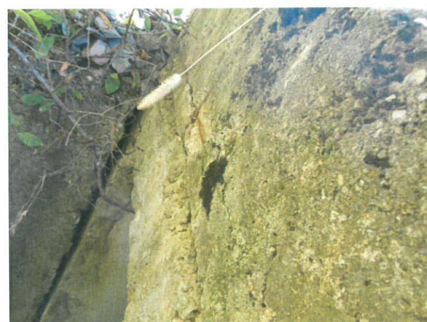
5. Vedere timpan prefabricat degradat, în amonte
