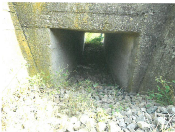
5. Detaliu intrare în podet dinspre amonte (beton segregat, crăpături, etc.)
