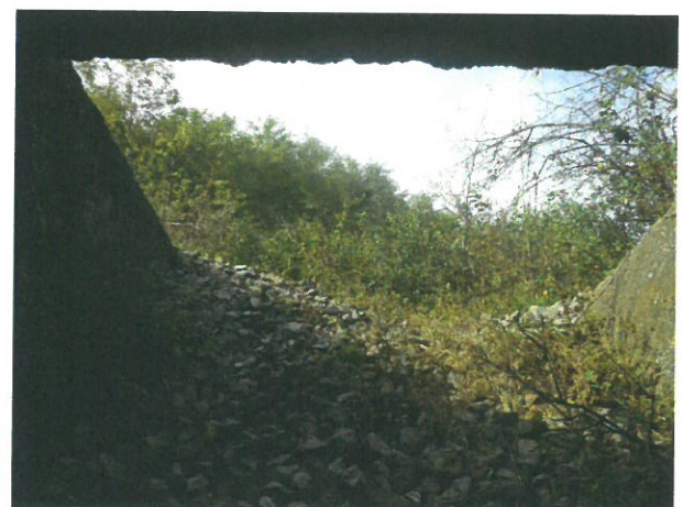
6. Vedere din interior podet spre ieșirea din amonte, colmatare cu piatră spartă
