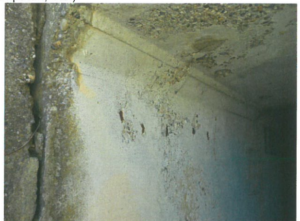
10. Degradări tronson marginal aval (crăpături, armături descoperite și corodate, beton segregat, etc.)
