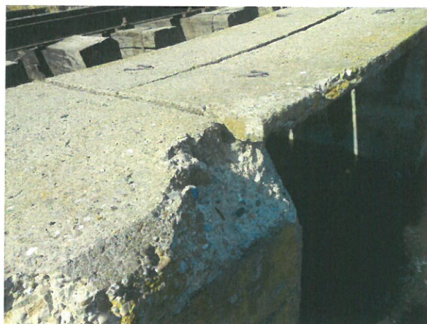
8. Vedere podeț din aval spre culeea București (beton spart, placă de beton degradată, etc.)
