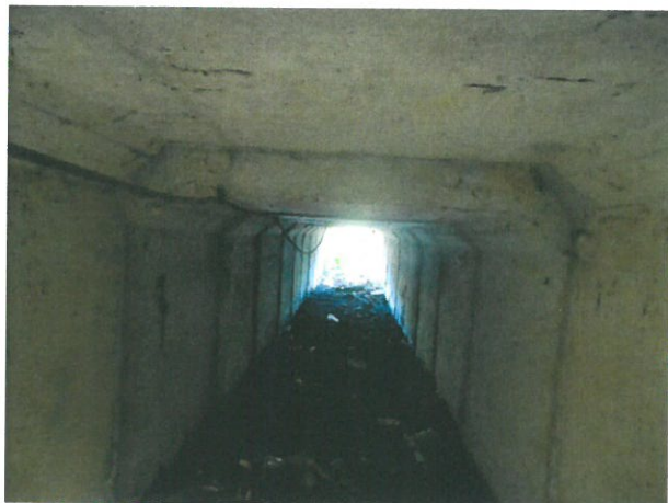
7. Vedere intrados elemente prefabricate, fisuri, beton degradat și armături la vedere
