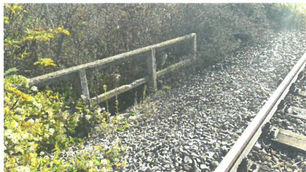
13. Vedere parapete din beton, degradat
