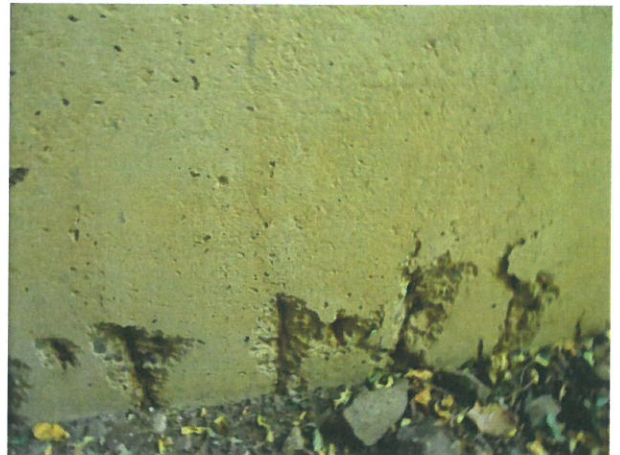
8. Beton degradat, fisuri și armături la vedere la partea inferioară a elementelor prefabricate
