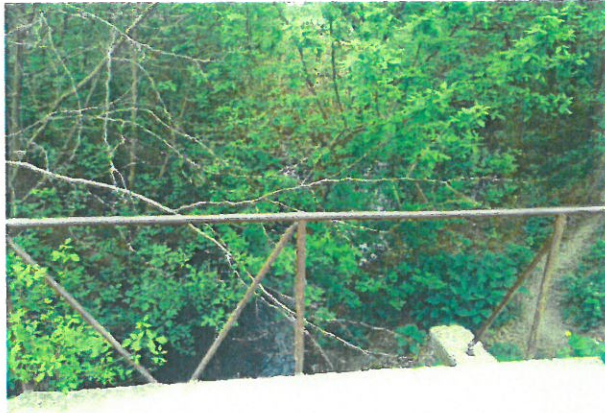
3. Vedere Amonte. Albie neamenajată și parțial colmatată
