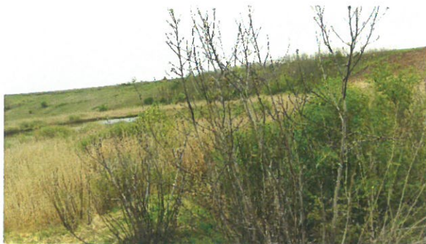
3. Vedere Amonte. Albie colmatată, intrare podet obturată
