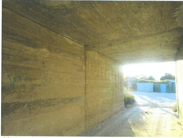
7. Vedere interior podeț dinspre stânga (strada degradată, beton cu crăpături și segregat, rosturi degradate, etc.)
