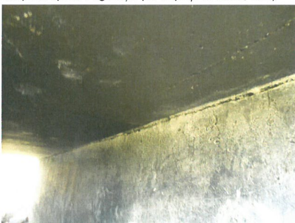
6. Vedere culee Giurgiu și intrados dală (beton cu crăpături, pete de carbonatare, beton segregat, etc.)
