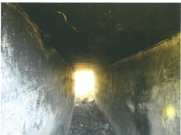
5. Vedere interior podet dinspre amonte (beton cu crăpături, porțiuni cu funingine pe intrados dală și culei, etc.)
