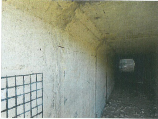
7. Vedere interior podeț dinspre aval (beton degradat, armături la vedere, pete de rugină datorită infiltrațiilor apei, colmatare ușoară, etc)
