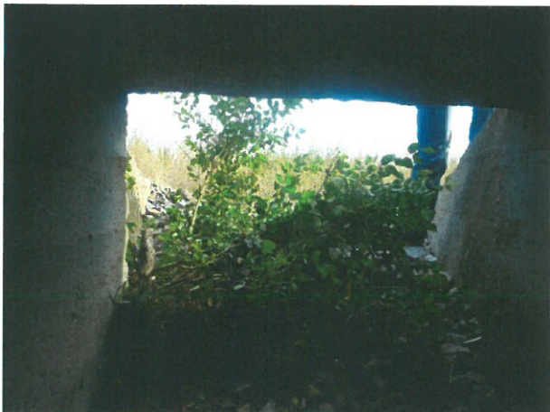
9. Vedere din interior podeț spre ieșirea din aval, colmatare cu piatră spartă
