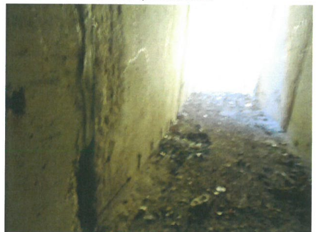
10. Beton degradat, fisuri și armături la vedere la rostul dintre elementele prefabricate
