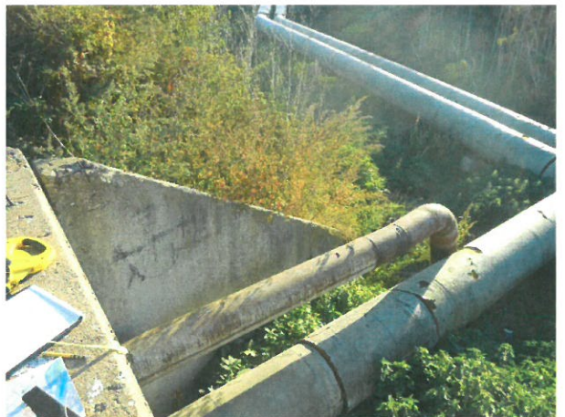
6. Vedere podet, spre amonte (degradarea aripilor prefabricate de tip A3 și armături la vedere)
