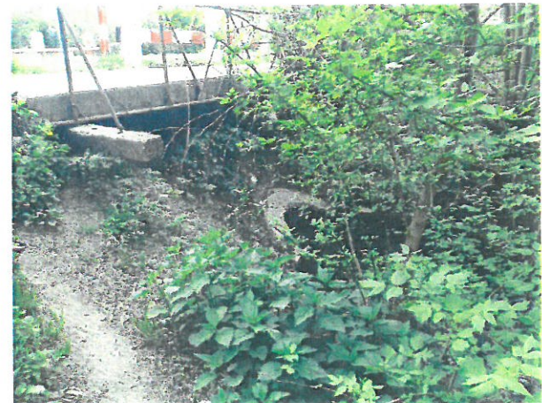
6. Vedere din amonte, lipsă timpan, trotuar pietoni
