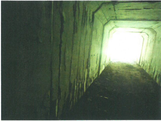
7. Fisuri, beton degradat și armături la vedere la partea inferioară a elementelor prefabricate
