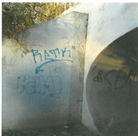
9. Vedere podet în aval (degradarea betonului la nivelul rostului dintre aripile prefabricate și timpan)
