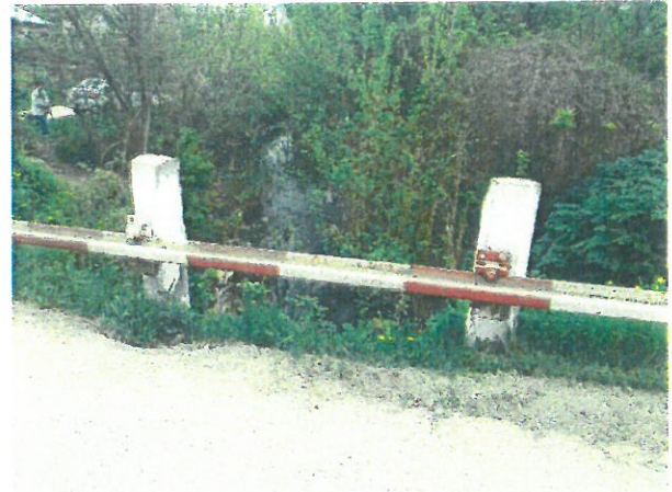
4. Vedere Aval. Albie neamenajată și parțial colmatată
