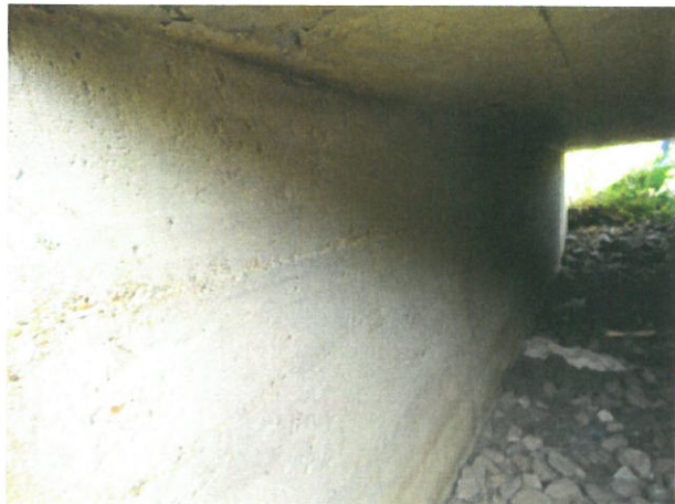
7. Vedere interior podeț spre aval, culee București – defecte (crăpături, zone cu segregări, etc.)
