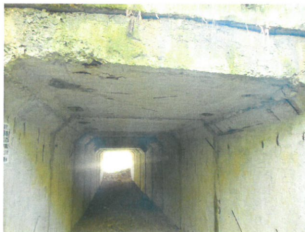
8. Vedere intrados cadre prefabricate cu beton degradat, fisuri și armături la vedere
