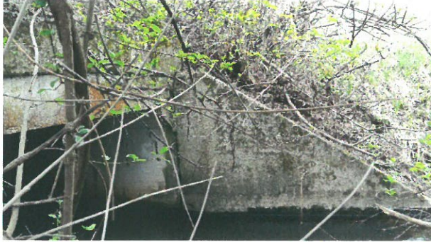
7. Vedere Aripa prefabricată, amonte, Giurgiu. Pete închise la culoare, pete de rugină pe dală și aripi
