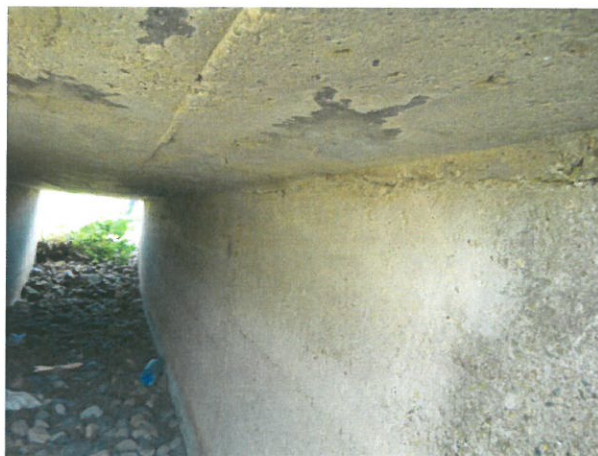
8. Vedere interior podeț spre aval, culee Giurgiu – defecte (pete de rugină și de carbonatare, crăpături, etc.)
