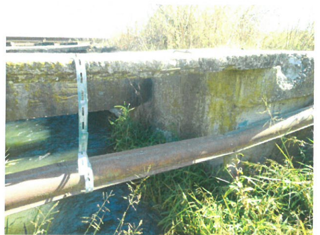
4. Vedere podet din amonte, culee și aripă Giurgiu, traseu cabluri (beton spart, placă de beton degradată, vegetație în albie, etc.)
