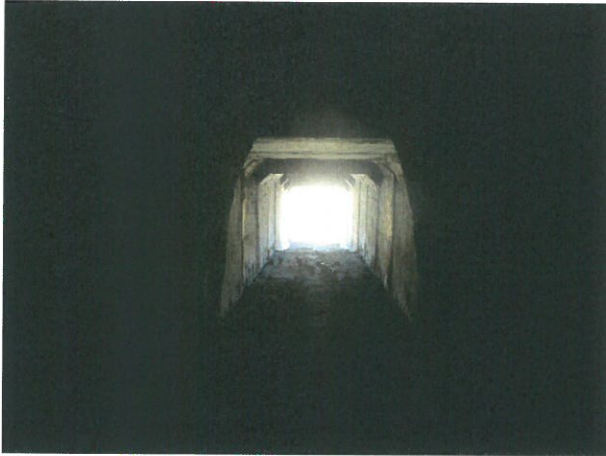
7. Vedere interior podeț dinspre amonte, trecerea de la ovaloid la cel din cadre prefabricate C2
