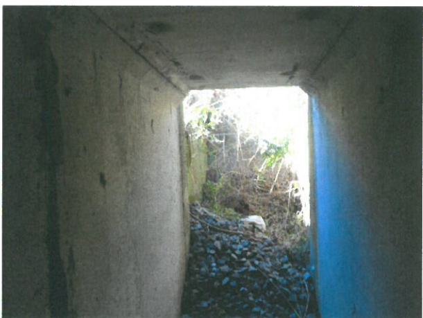
5. Vedere tronson marginal prefabricat C1 amonte (mortar între tronsoane degradat, pete de rugină la intrados, crăpături, etc.), cameră de cădere colmatată
