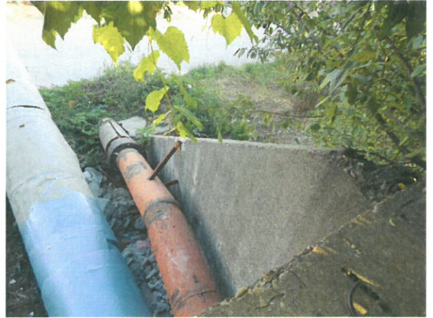
8. Vedere podeț, spre aval (degradarea aripilor prefabricate de tip A3 și armături la vedere)
