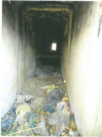
7. Vedere interior podeț dinspre amonte (beton cu fisuri, perete acoperit cu gunoaie, zone cu carbonatări, suprafețe cu funingine, etc)
