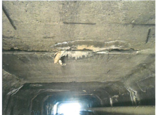
10. Vedere podeț din aval (degradarea betonului dintre rosturi și infiltrații ale apei)
