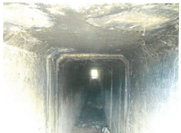
6. Vedere interior podet dinspre amonte (beton cu fisuri, mortar între tronsoane degradat, zone cu carbonatări, suprafețe cu funingine, etc.)
