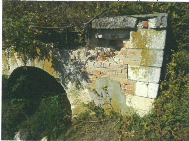
9. Timpan boltă degradat
