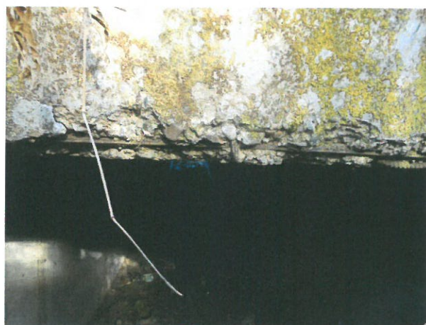
6. Elevație element prefabricat de capăt, fisuri, beton degradat și armături la vedere
