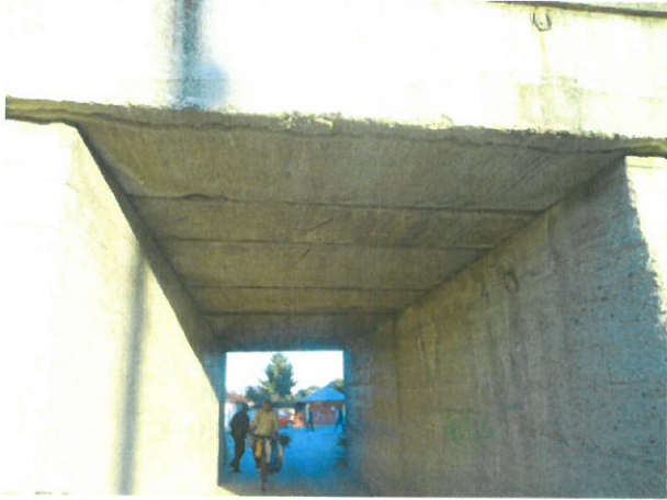
9. Vedere interior podeț dinspre dreapta (beton cu crăpături, segregări beton, etc.)
