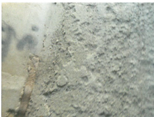
10. Degradarea betonului la nivelul rostului dintre aripile prefabricate și timpan
