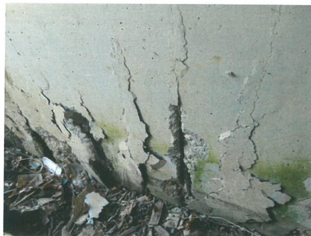
8. Fisuri, beton degradat și armături la vedere la partea inferioară a elementelor prefabricate
