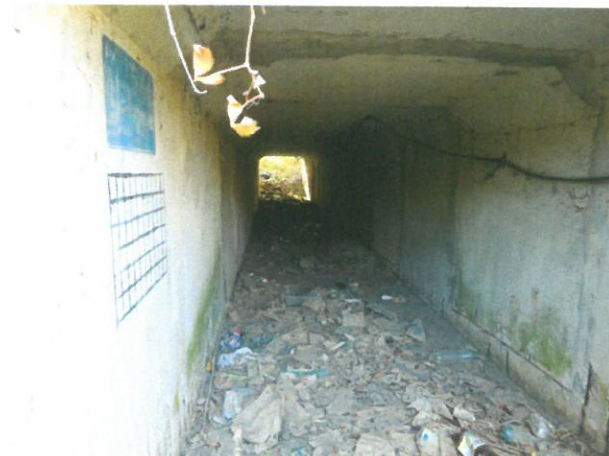
10. Beton degradat și armături la vedere în zona de îmbinare dintre elemente
