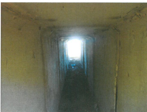
6. Vedere interior podet dinspre amonte (beton cu fisuri, mortar între tronsoane degradat, percu, etc)
