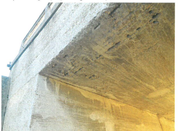
6. Vedere culee Giurgiu și intrados dală (beton cu crăpături, pete de carbonatare, beton segregat, armături descoperite, etc.)
