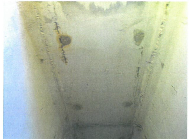
8. Degradare tronson prefabricat marginal C1 (armături descoperite și corodate, pete de rugină, crăpături, etc.)
