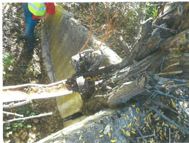
12. Aripă prefabricată deplasată
