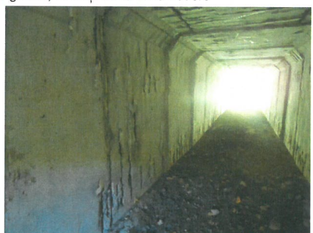
6. Fisuri, beton degradat și armături la vedere la partea inferioară a elementelor prefabricate
