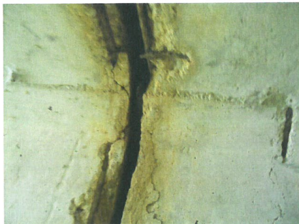
7. Beton degradat și armături la vedere în zona de îmbinare dintre elemente
