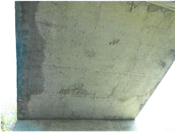
7. Vedere intrados dală (beton umed și ușor degradat, pete de rugină și de carbonatare, beton segregat, etc.)
