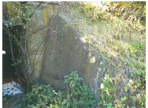
4. Degradări uşoare ale aripilor monolite, în aval
