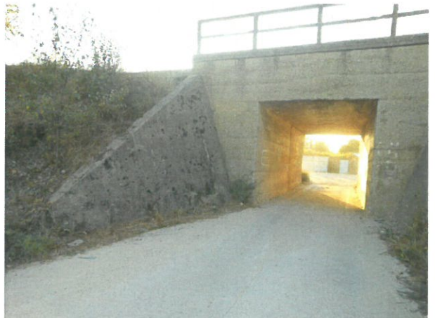
4. Vedere racordare cu terasamentul, din stânga, spre direcția Giurgiu (aripă degradată)
