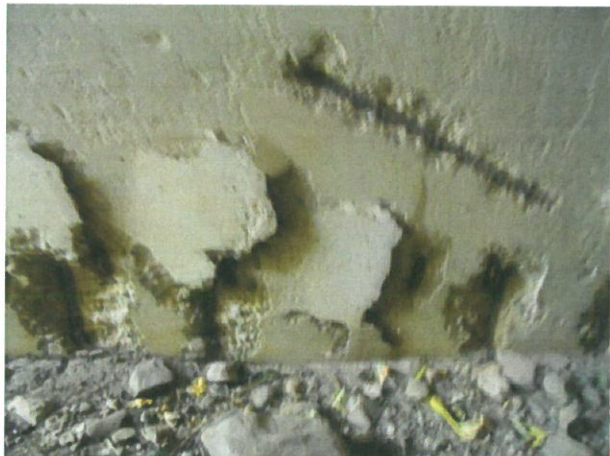
9. Beton degradat, fisuri și armături la vedere la partea inferioară a elementelor prefabricate
