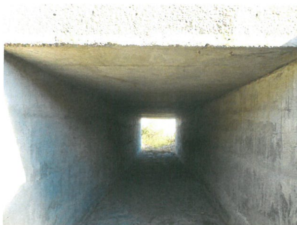
6. Vedere interior podet dinspre amonte (beton ușor degradat, pete de rugină și de carbonatare, beton segregat, pereu, etc.)
