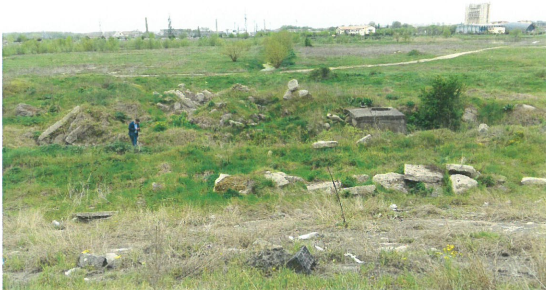
2. Vedere podet spre amonte. Albia este colmatată prin depunere de moloz și blocuri de beton provenite din demolări.
