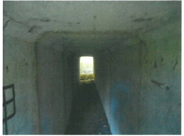
8. Vedere intrados cadre prefabricate cu beton degradat, fisuri și armături la vedere
