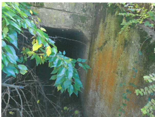
5. Vedere tronson marginal prefabricat tip C2, lisă și aripă tip A2 (terasament direcția Giurgiu)
