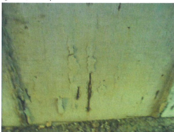
10. Fisuri, beton degradat și armături la vedere la partea inferioară a elementelor prefabricate
