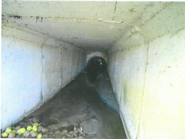
7. Vedere interior podeț dinspre amonte (beton prefabricate C2 ușor degradat, mortar dintre prefabricate degradat, colmatare podeț, etc.)
