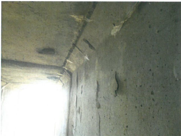
9. Degradări tronsoane prefabricate tip C1 (zone umede la intradosul prefabricatelor, mortarul de la rost degradat, fisuri, etc.)
