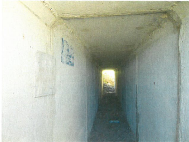
7. Vedere interior podeț dinspre aval (mortar dintre prefabricate degradat, pete de rugină, etc)
