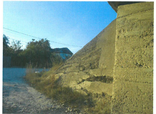
10. Vedere racordare cu terasamentul, din dreapta, spre direcția București (aripă degradată)
