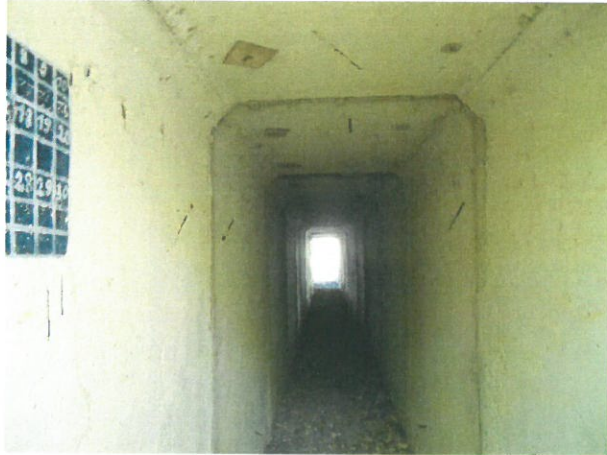
7. Vedere intrados podeț, fisuri și armături la vedere
