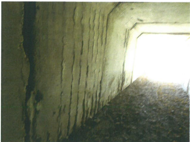
9. Fisuri, beton degradat și armături la vedere la partea inferioară a elementelor prefabricate
