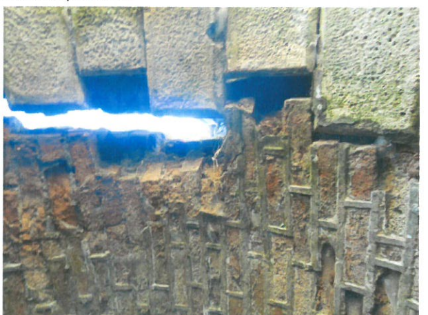
6. Boltă degradată în zona cheii, la conexiunea dintre moloanele marginale și partea de cărămizi, cărămizi degradate
