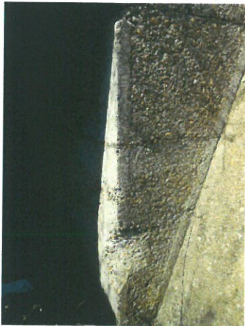
9. Vedere culee București (muchii degradate, beton segregat, etc.)
