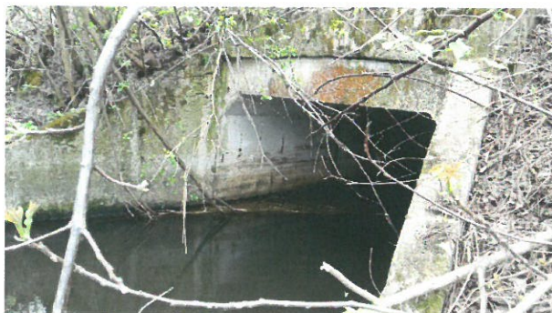
5. Elevație podet prefabricat tip C2. Urme de rugină și pete închise la culoare pe dală și aripi
