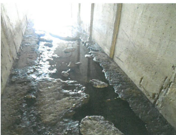
6. Prelu de beton degradat
