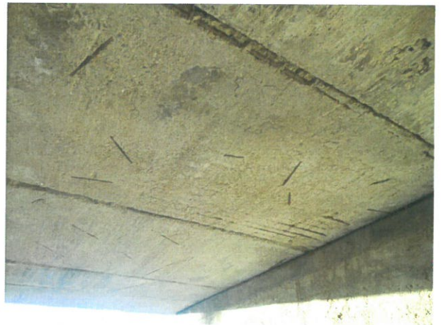
8. Vedere intrados dale prefabricate (beton cu crăpături, rosturi degradate, armături descoperite, etc.)
