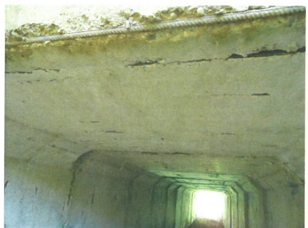
4. Vedere intrados cadre prefabricate cu beton degradat, fisuri și armături la vedere
