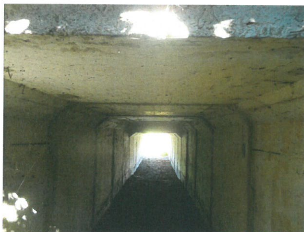
6. Vedere interior podet dinspre amonte (beton degradat, armături la vedere, pete de rugină datorită infiltrațiilor apei, colmatare ușoară, etc)
