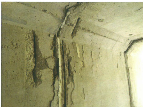
10. Beton degradat și armături la vedere în zona de îmbinare dintre elemente
