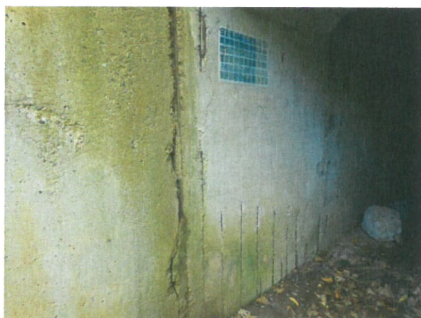
5. Fisuri, beton degradat și armături la vedere la partea inferioară a elementelor prefabricate
