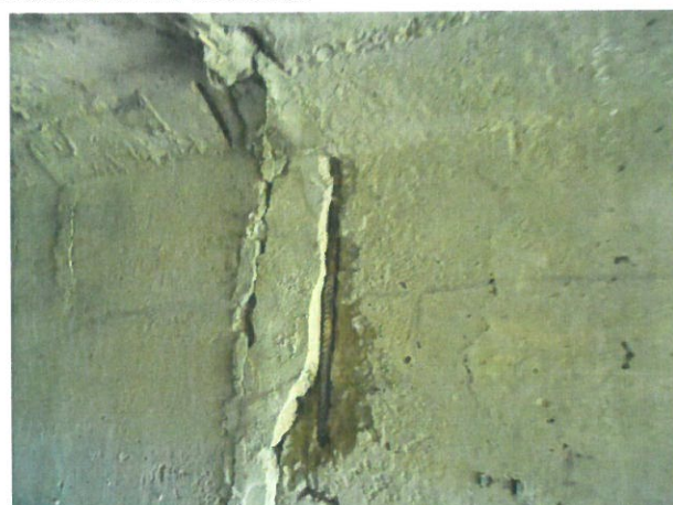
9. Beton degradat și armături la vedere în zona de îmbinare dintre elemente
