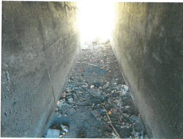
7. Vedere interior podeț dinspre amonte (albie ușor colmatată, beton cu crăpături și segregat la culei, etc.)
