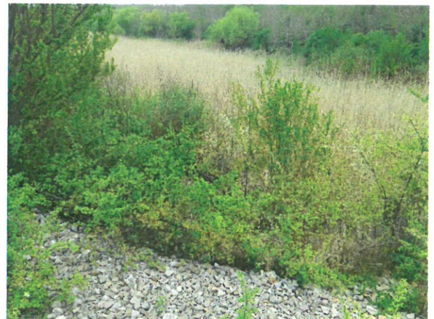
4. Vedere Aval. Ieșire podet obturată
