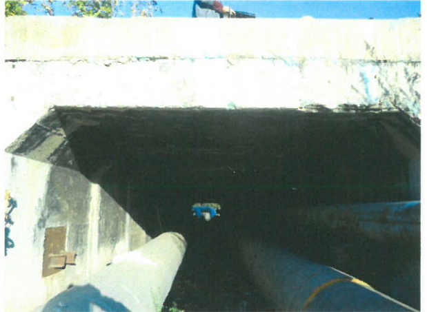
4. Vedere podet, din amonte (degradarea betonului din prefabricatul C3 de capăt și armături la vedere)
