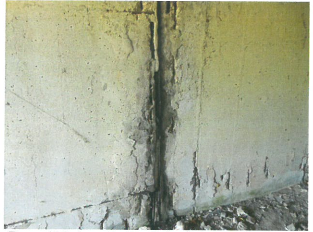
8. Degradări ale rosturilor dintre tronsoanele de prefabricate tip C2 (armături descoperite și corodate, mortarul dintre prefabricate degradat, etc.)
