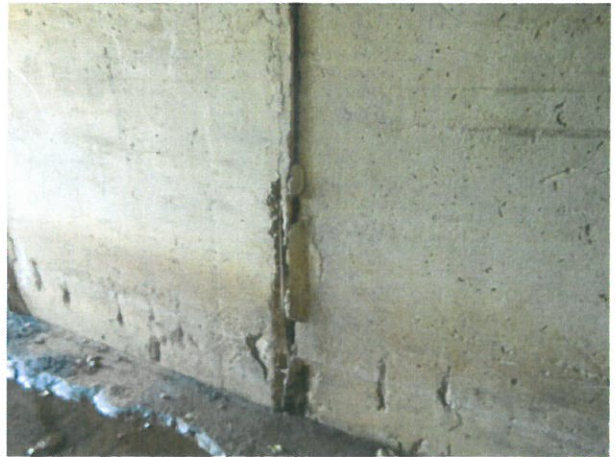
8. Fisuri, beton degradat și armături la vedere la partea inferioară a elementelor prefabricate
