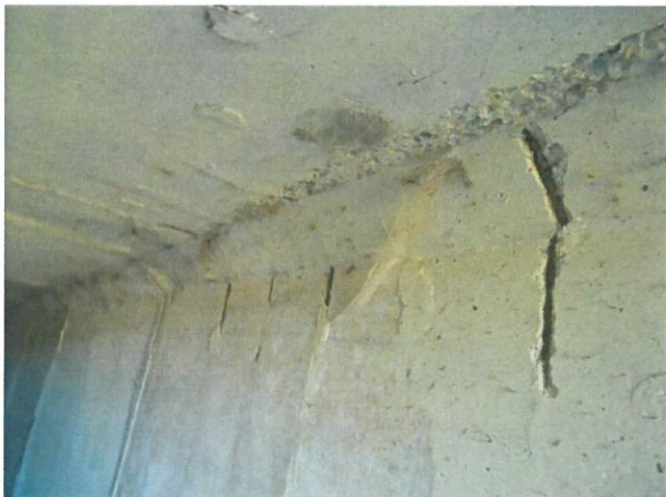
9. Degradări tronsoane prefabricate tip C1 (armături descoperite și corodate, mortarul de la rost degradat, mici fisuri, etc.)
