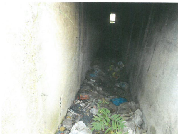
5. Vedere interior podet dinspre amonte (beton cu fisuri, percu acoperit cu gunoarie, etc)
