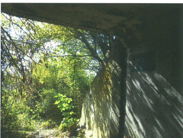
12. Aripă prefabricată, în aval, Giurgiu, deplasată
