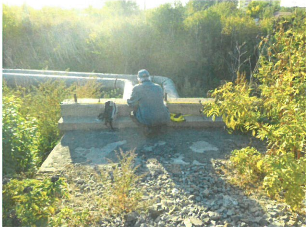
3. Vedere podet, spre amonte (degradarea hidroizolației)
