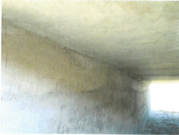
7. Vedere interior spre culeea București (beton ușor degradat și cu segregări, pete de rugină și de carbonatare, etc.)
