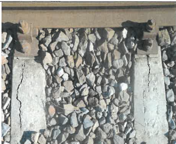
Traverse de beton fisurate pe zona prinderii sau longitudinal
