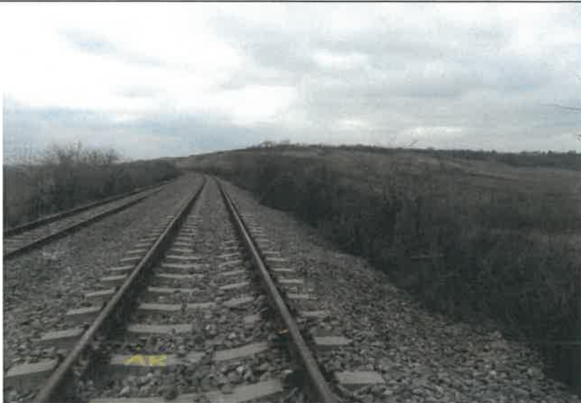
Zona de instabilitate km 53+550 - km 54+050
