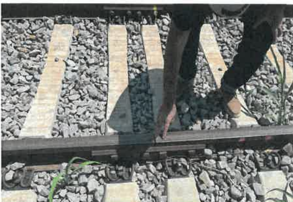
Exfolieri și știrbituri pe suprafața de rulare
