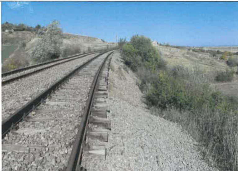
Zona de instabilitate km 54+050 – km 54+650
