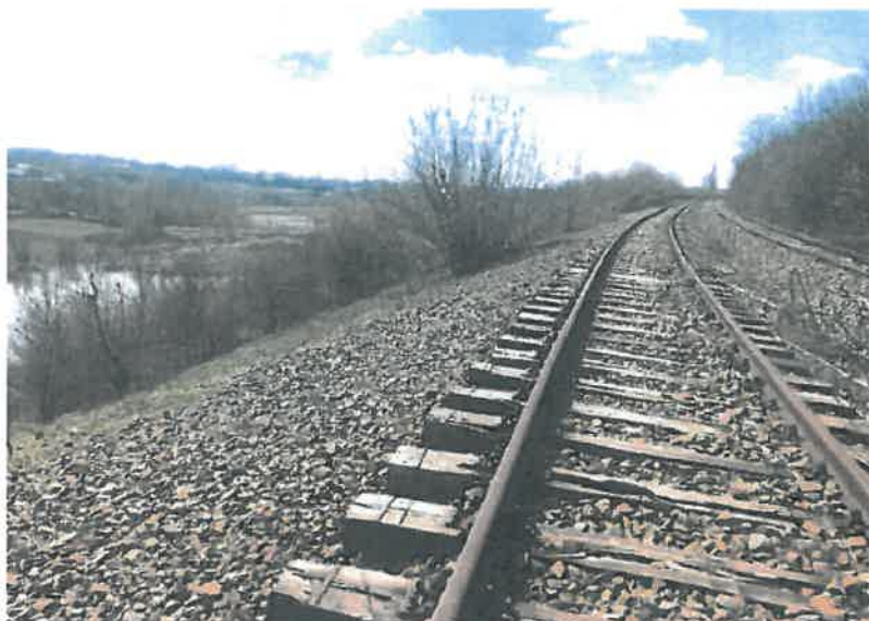
Zona de instabilitate km 33+725 - km 34+075
