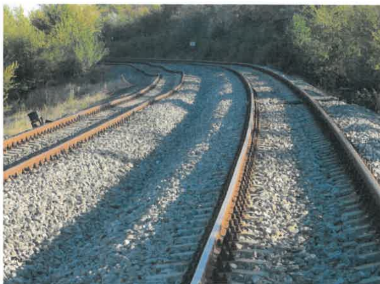
Zona de instabilitate km 51+900 - km 52+300
