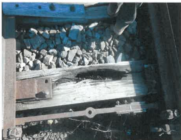
Traversa din lemn ruptă pe zona aparatelor de cale.
