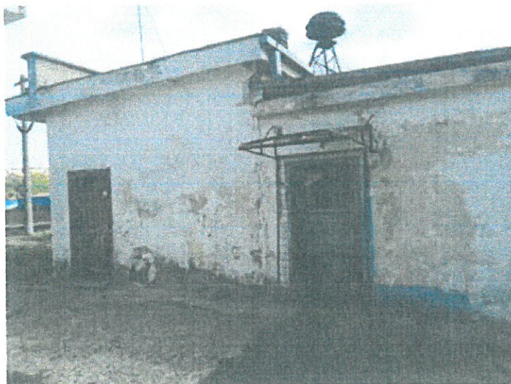
Acoperișul placă din beton tip terasă - Fisuri ale aticului
