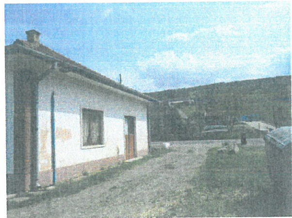
Desprinderi ale tencuielilor exterioare
