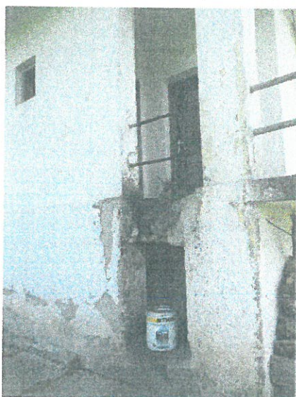
Tencuieli cu infiltrații
