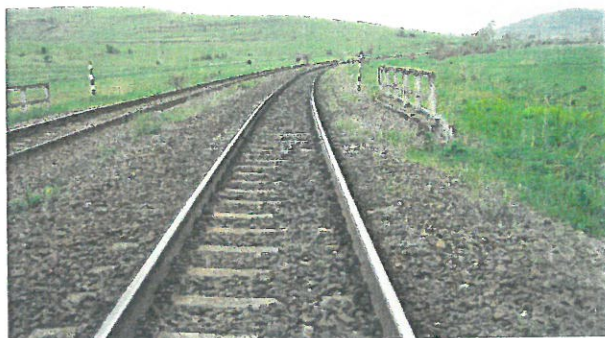
1.Calea și tipul traverselor pe Firul I
