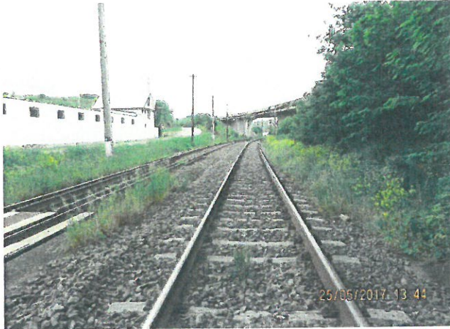
1.Calea și tipul traverselor pe Firul I
