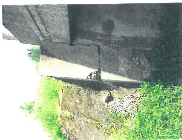
17. Zidul de sprijin amonte fracturat
