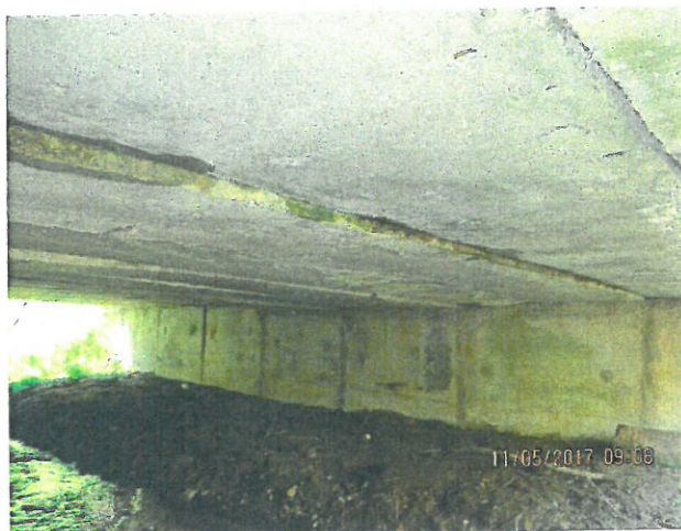
8. Vedere intrados dală cu infiltrații
