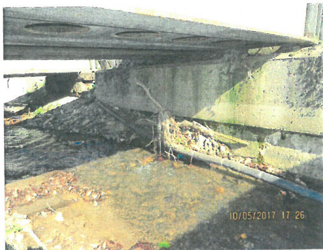
7. Pozarea cablului care trece pe sub pod (în albie)
