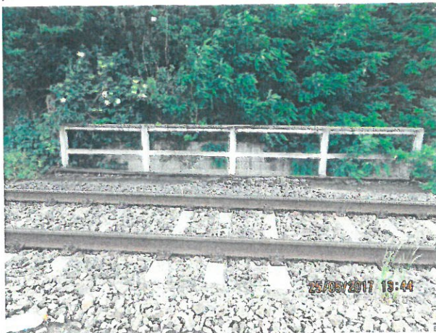
5.Lipsa traverselor pe pod, pe Firul I
