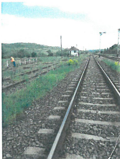
1. Calea și tipul traverselor pe Firul I
