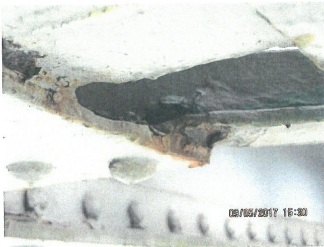
3. Coroziune în zona prinderii antretoazei de talpa grinzii principale
