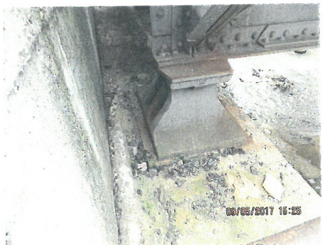
18. Aparat de reazem fix pe culeea Cluj
