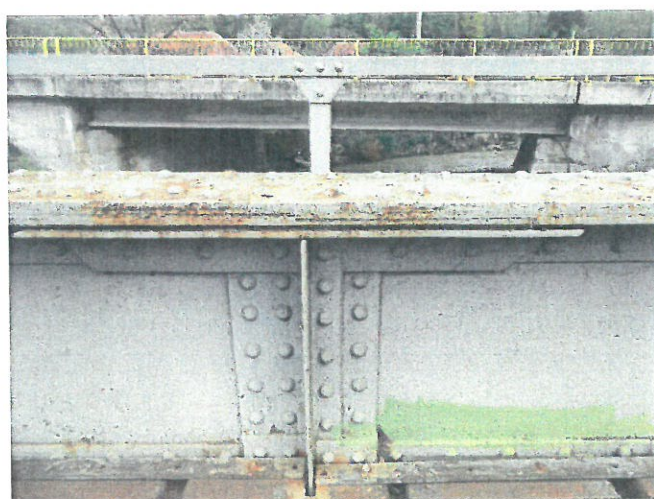
17. Rostul de montaj afectat de rugină
