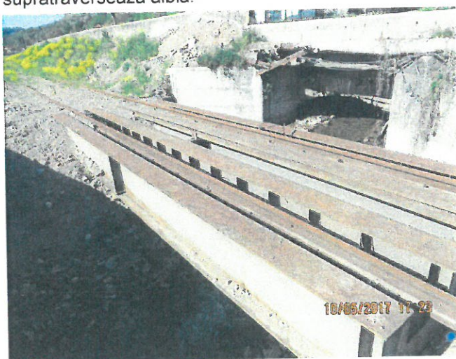
5. Vedere pod de pe linia de racord și pod de șosea amonte
