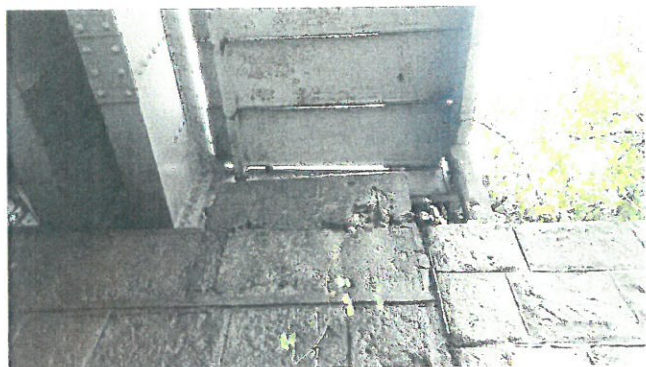
19. Bancheta cuzineților și opritor antiseismic Culeea Cluj Napoca
