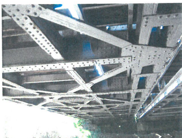
5. Vedere intrados tablier metalic G.Z.C.J - nituit, pe Firul I
