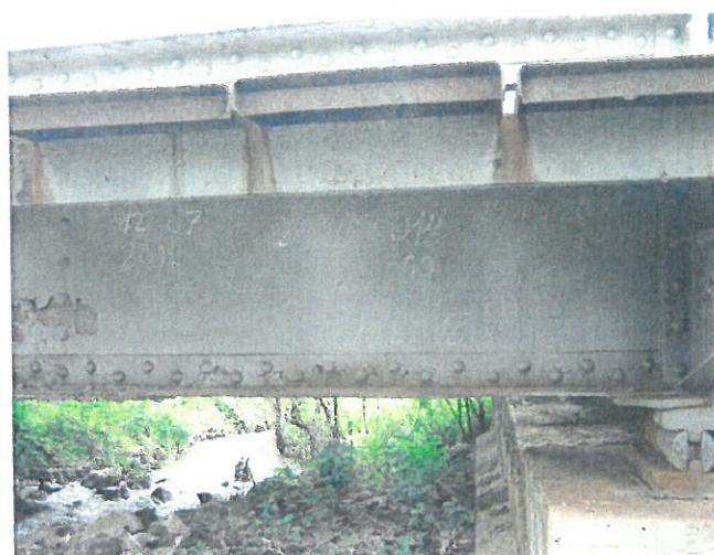
10. Elevație grindă cu protecția anticorozivă degradată
