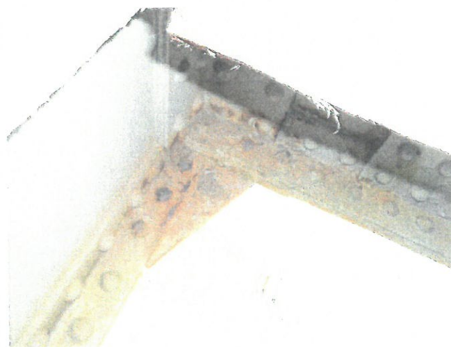
18. Panou de capăt afectat de coroziune
