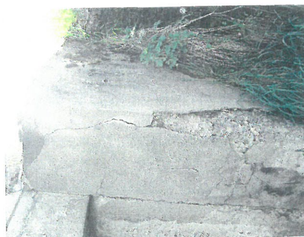
18. Beton degradat la zidul de sprijin
