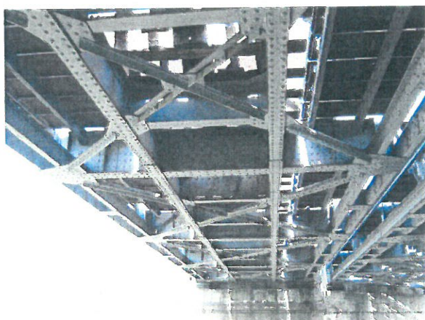
5. Vedere intrados tablier metalic G.Z.C.J - nituit, pe Firul I
