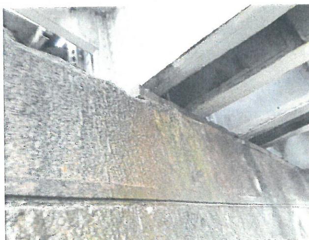
24. Bancheta cuzineților degradată la Pila 4
