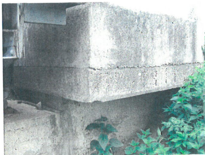
11. Zid întors, cuzinet și zid de gardă cu segregări
