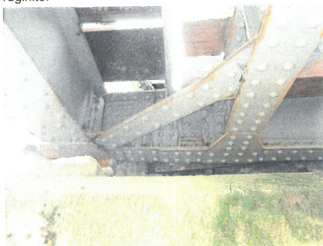
11. Contravântuire și guseu orizontal afectat de rugină
