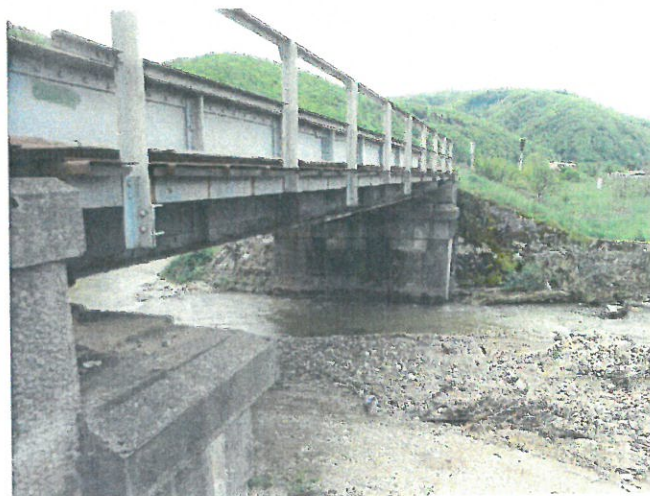
4. Vedere din amonte, spre aval albia sinuoasă cu tendința de afuiere a culeei
