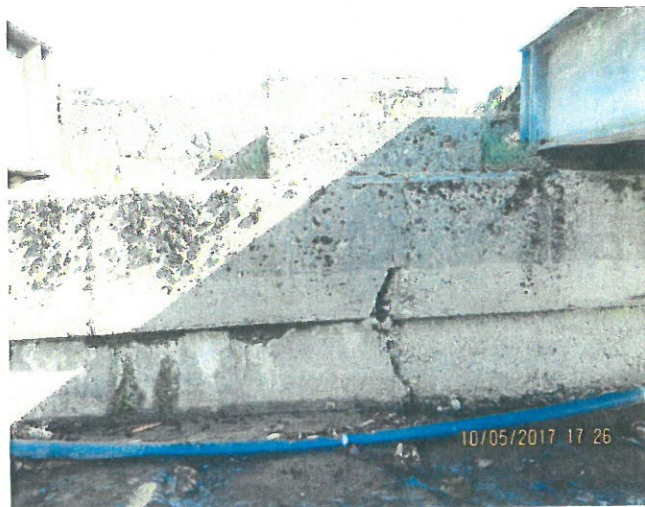
8. Vedere Culee Cluj cu elevație fracturată
