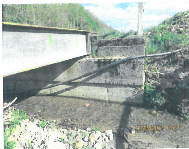
12. Lipsa trotuare și parapet la pod
