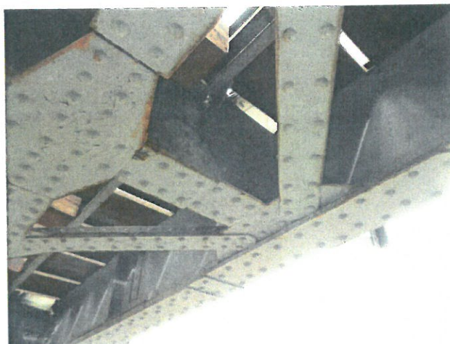
9. Vedere la partea inferioară, piesele metalice parțial ruginite.
