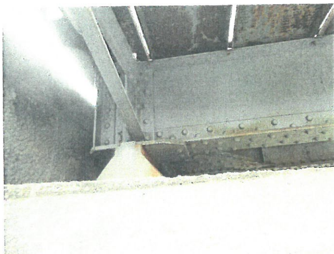
7. Aparat de reazem fix pe Culeea Cluj
