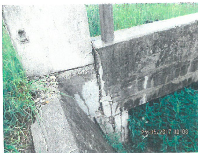
12. Beton degradat în zona zidului de gardă al culeei
