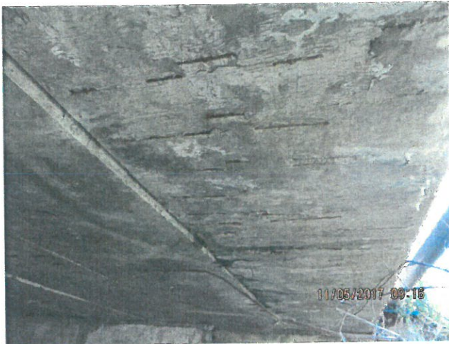
15. Armătură la vedere și scurgeri de calcită
