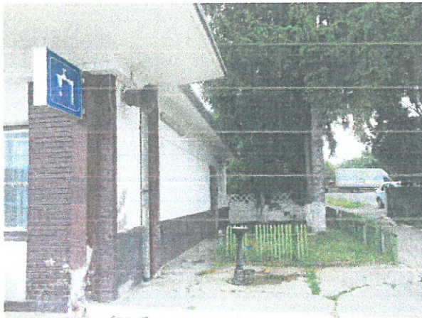
Tencuieli cu infiltrații
