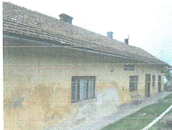
Desprinderi ale tencuielilor exterioare
