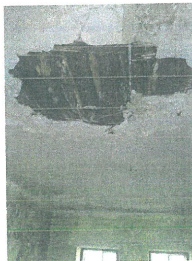
Crăpături ale tencuiei, exfolieri
