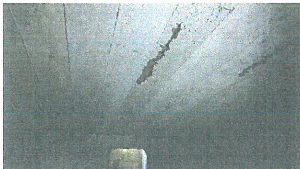
Infiltrații în zona planșeului
