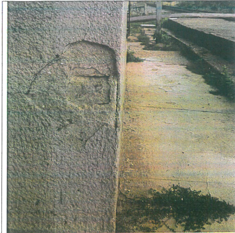
Trotuare perimetrare fisurate.
