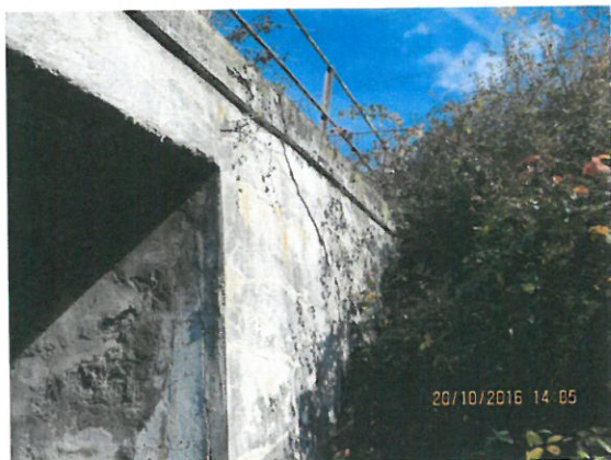
11. Vedere culee degradată podeț
