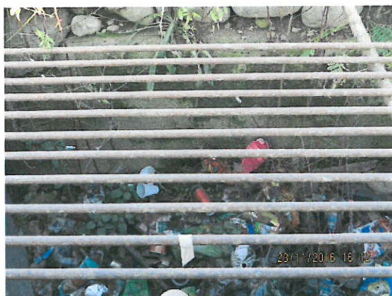
9. Colmatare cu deșeuri a căminului aval
