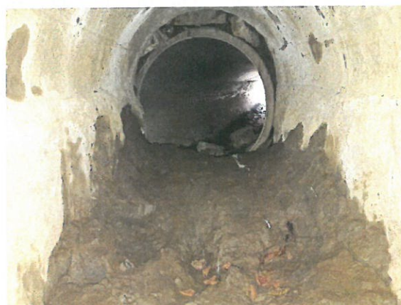
8. Vedere colmatare în aval.
