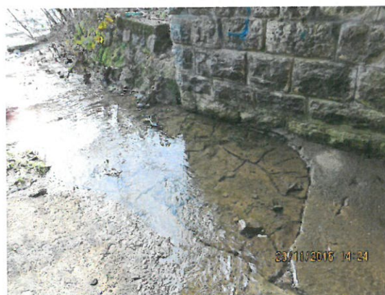
12. Degradare pereu de beton
