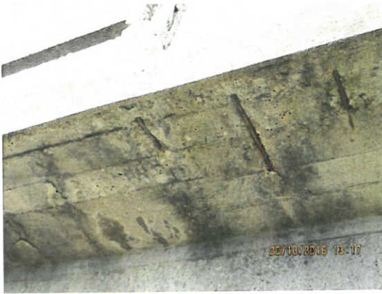
7. Vedere armături descoperite dală prefabricată
