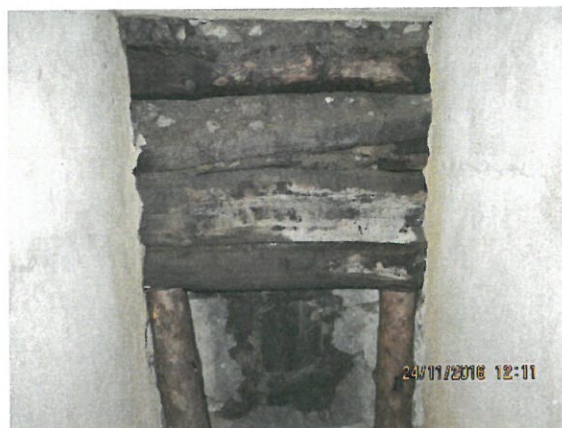
8. Vedere podeț înfundat.
