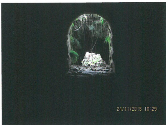
7. Prăbușire dală de piatră
