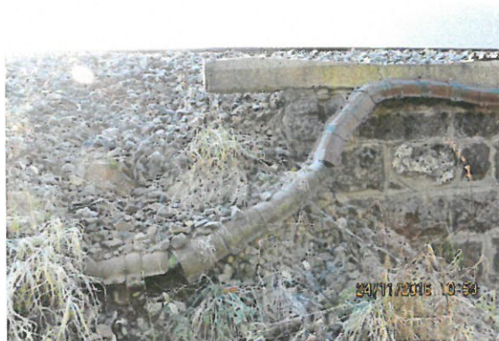
10. Vedere cabluri pe timpan amonte.
