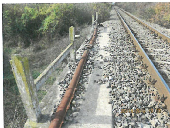
3. Vedere timpan, cabluri și parapet degradat amonte
