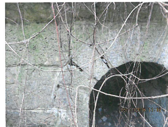
6. Mortar de ciment degradat amonte.
