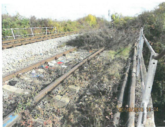
2. Vedere c.f. nefuncțională
