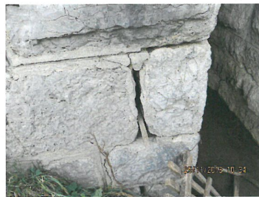
10. Mortrar de ciment degradat.
