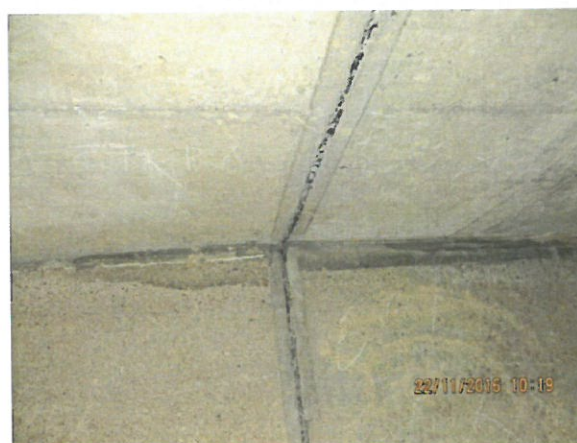
12. Detaliu intrados - rost
