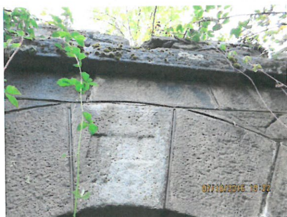
11. Vedere timpan degradat aval
