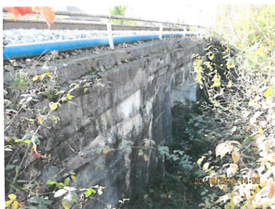
5. Vedere elevație degradată amonte
