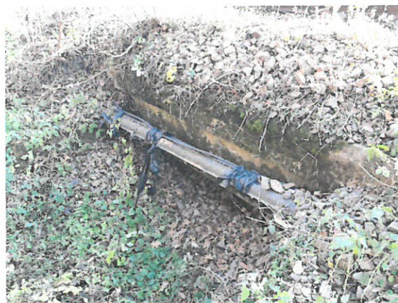
5. Racordarea cu terasamentul amonte, culee Cluj.
