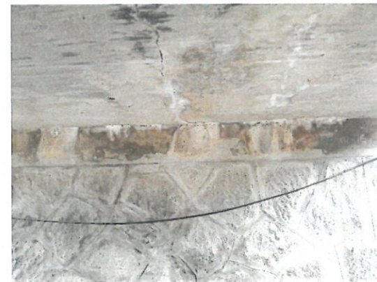
12. Vedere fisură și infiltrații dală.
