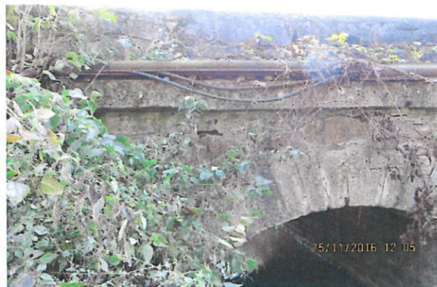
4.Vedere podet amonte, teacă cabluri.
