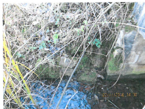
12. Detaliu racordare mal stâng amonte
