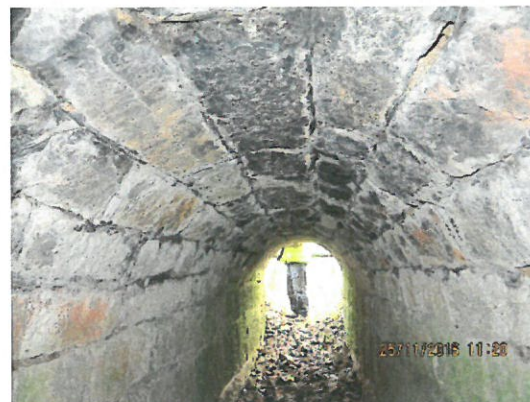
8. Mortar de ciment degradat în podeț.
