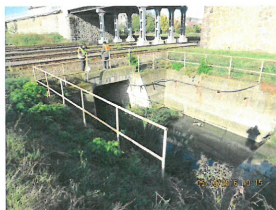
5. Vedere cameră de colectare ape amonte
