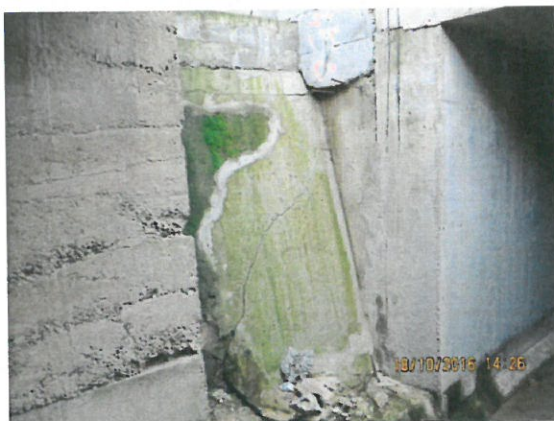
5. Vedere zid de sprijin fisurat amonte
