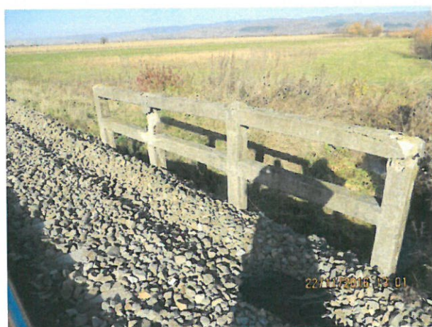
11. Parapet degradat aval
