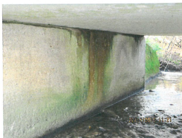
11. Detaliu infiltrații culee spre amonte
