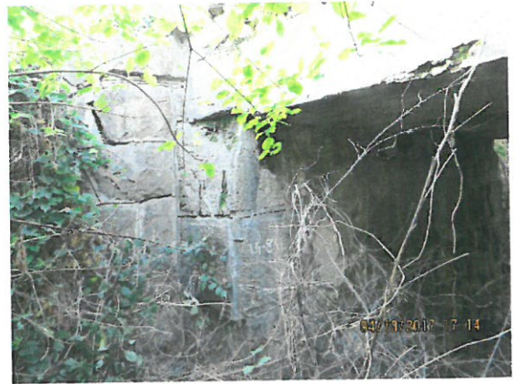
8. Vedere dală și timpan degradate aval
