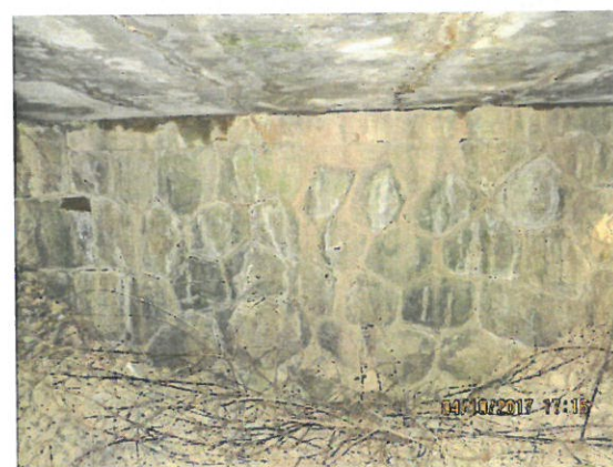
5. Vedere interior podeț dală degradată și infiltrații apă
