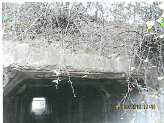
11. Vedere beton degradat aval
