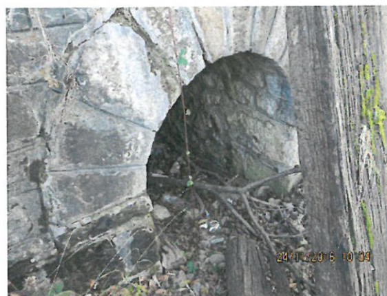
12. Colmatare cu piatră spartă și deșeuri a albiei aval
