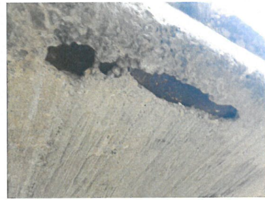
10. Vedere strat de acoperire profil metalic căzut .
