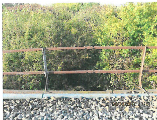
2. Vedere timpan, cabluri și parapet degradat amonte
