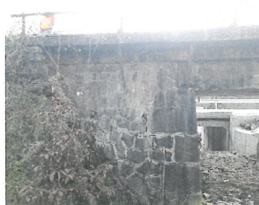
6. Racordarea cu terasamentul amonte, culee Cluj.
