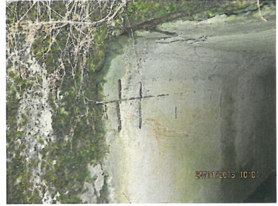
8. Vedere armatură la vedere.
