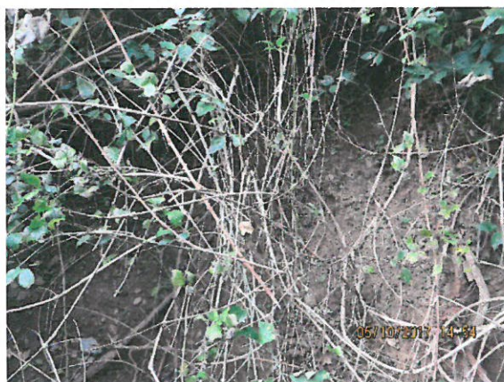
5. Racordarea cu terasamentul amonte, culee Cluj.
