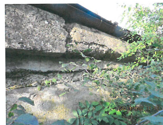
6. Vedere timpan și dală degradate aval
