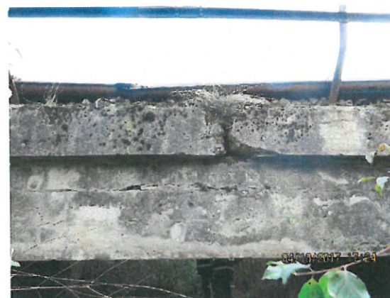
4. Vedere dală și timpan degradate amonte
