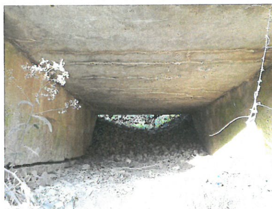
8. Vedere vedere infiltrații dală.
