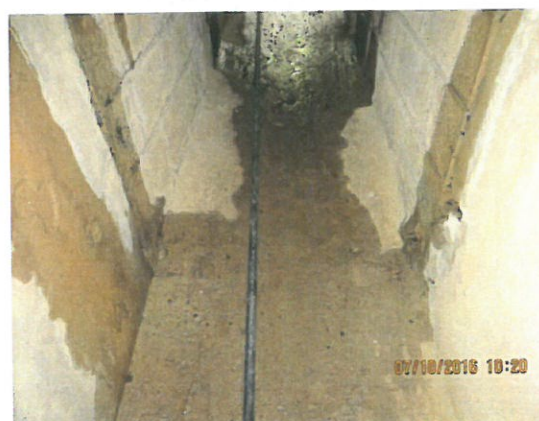
12. Vedere infiltrații de apă interior podeț din beton
