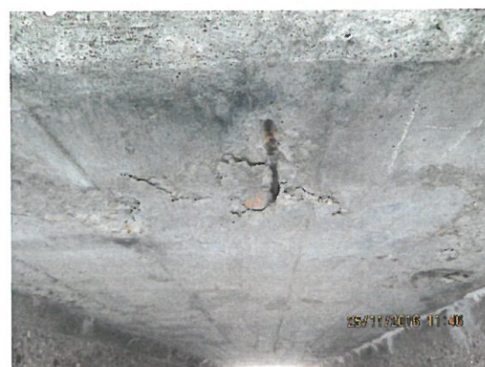
5. Armătură la vedere în dala la intrarea din amonte.
