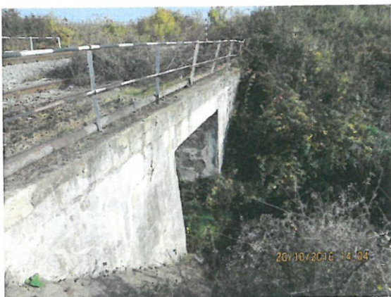
7. Vedere elevație degradată aval
