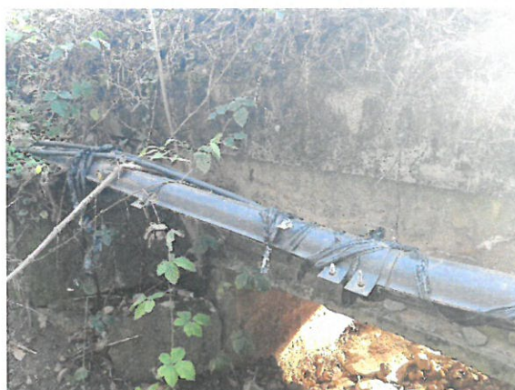
5. Vedere cabluri amonte Cluj.
