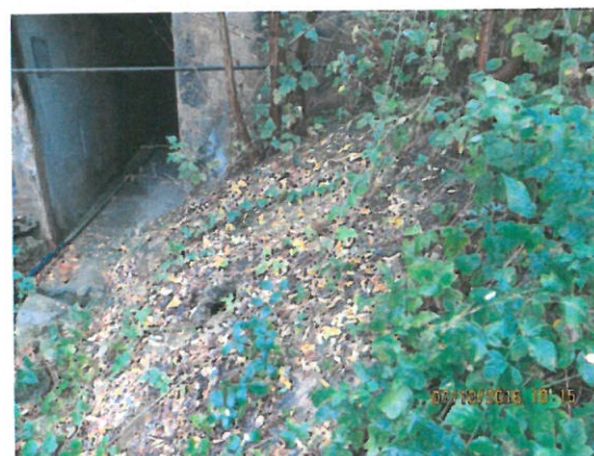
10. Vedere zid de sprijin aval și pereu degradat
