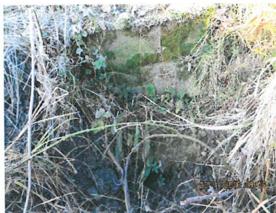
4. Vedere timpan amonte colmatat cu vegetație
