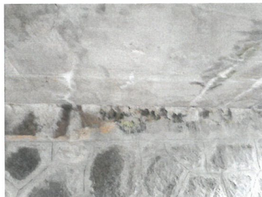
11. Vedere infiltrații între dală și banchetă.
