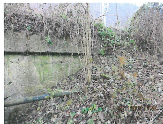
10. Vedere sfert de con degradat.
