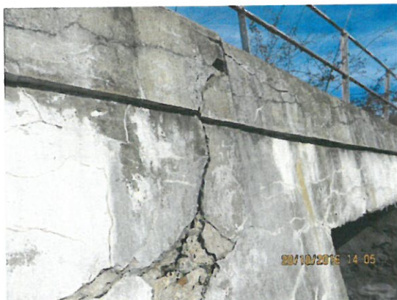
9. Vedere elevație degradată
