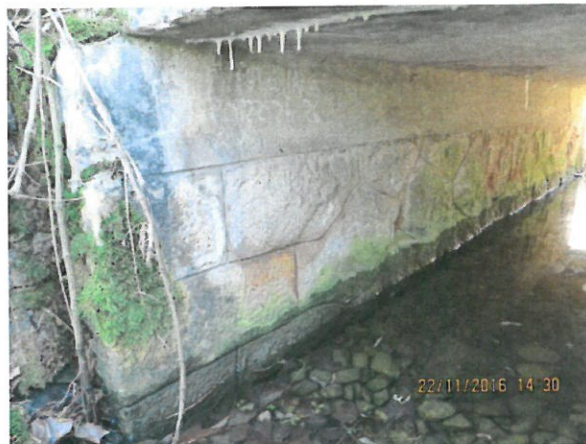
8. Infiltrații Culee stânga din amonte
