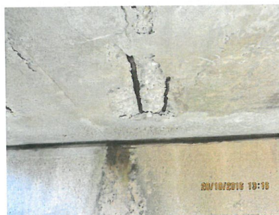
6. Vedere armături descoperite dală prefabricată
