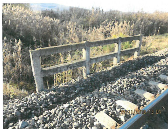
12. Parapet degradat amonte
