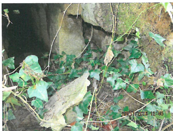
7. Degradare elevație pilă
