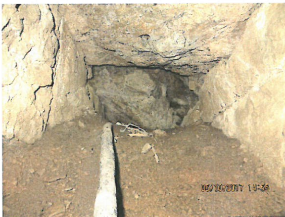
7. Vedere interior podeț cu dală prăbușită.
