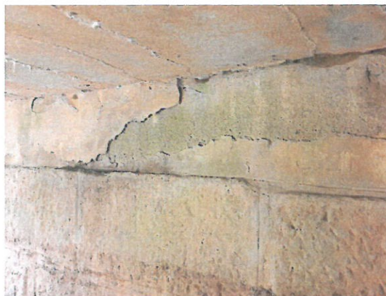
8. Vedere vedere infiltrații dală.
