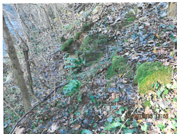
10. Colmatarea în totalitate a timpanului aval
