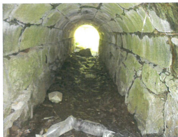
6. Vedere interior podeț dinspre amonte- degradări (moloane sparte, carbonatări, infiltrații, colmatare, etc.)
