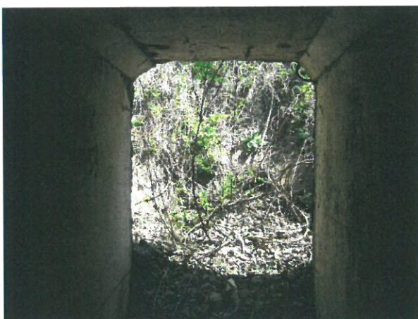
11. Colmatare cu piatră spartă și vegetație a camerei de cădere din amonte
