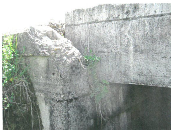
5. Vedere zid întors din amonte degradat
