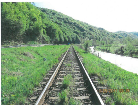
1. Șina și prinderea acesteia de traverse (vedere în direcția Cluj); Râul Crișul Repede
