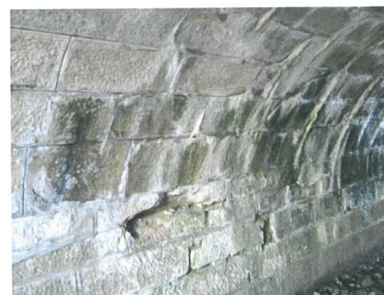
6.Vedere intrados degradat podeț boltit
