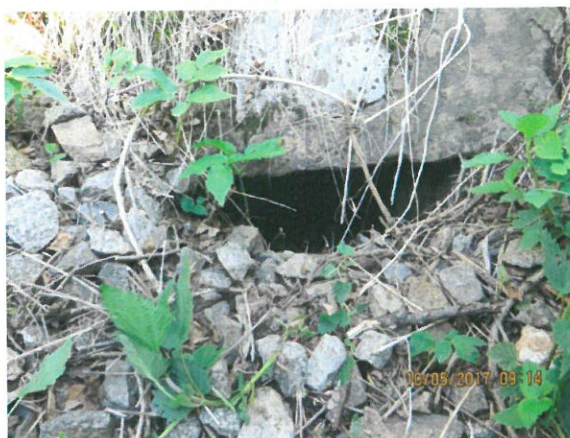
10. Vedere detaliu podeț din aval - degradări (colmatare albie și podeț)
