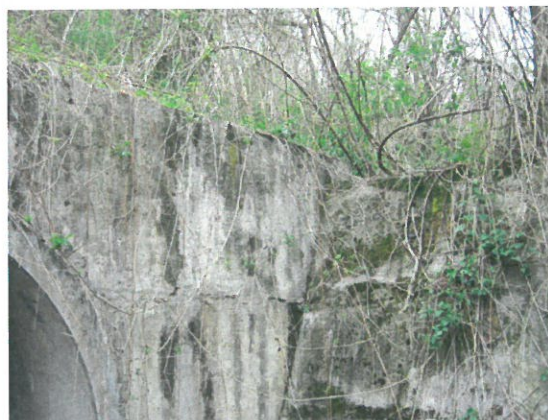
8. Vedere elevație ușor degradată podeț din aval
