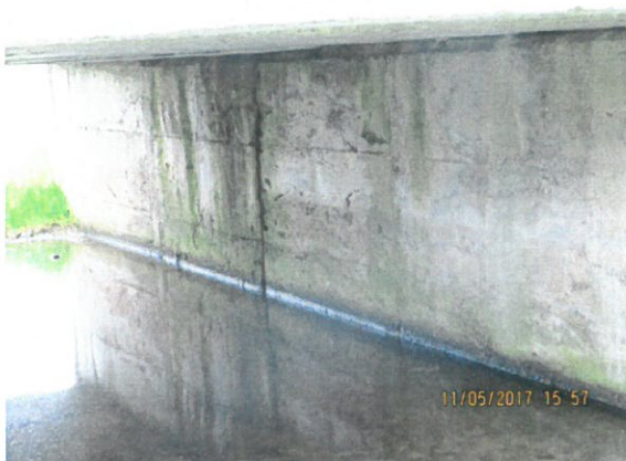
7. Infiltrații Culee dreapta din amonte
