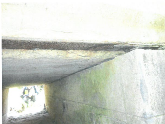
7. Vedere intrados dală amonte si culee Oradea – degradări (grindă metalică marginală descoperită și corodată, crăpături beton, carbonatări etc.)
