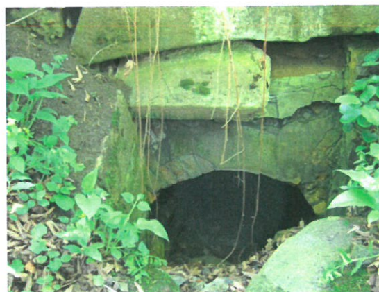
6. Vedere elevație degradată aval
