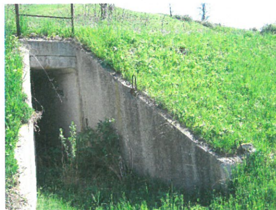
10. Exfolierea betonului aripii aval
