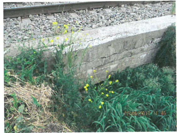
8.Vedere dală degradată aval
