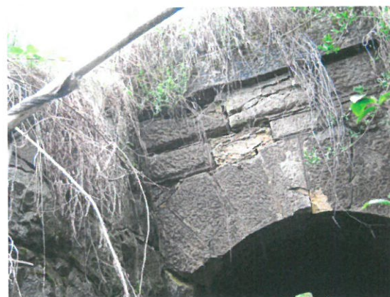
5. Vedere timpan degradat
