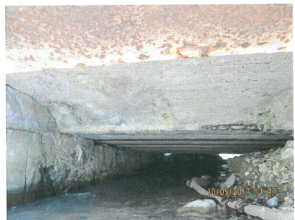
6. Vedere intrados dală, și elevație culee Oradea – degradări (carbonatări, eroziune la baza culeei) și colmatarea podețului
