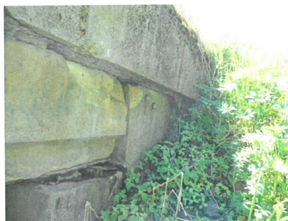
6. Vedere detaliu banchetă culee Oradea amonte - degradări (beton dală desprins)
