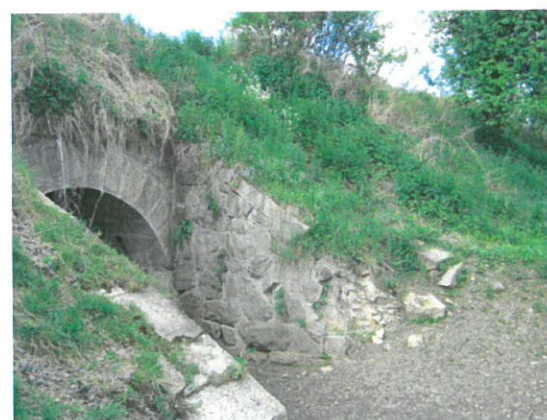
4.Vedere aripă degradată amonte
