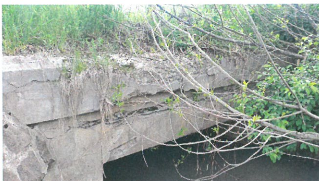
8. Degradări ale suprafeței betonului timpanului amonte
