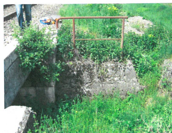
6.Vedere aripă degradată amonte
