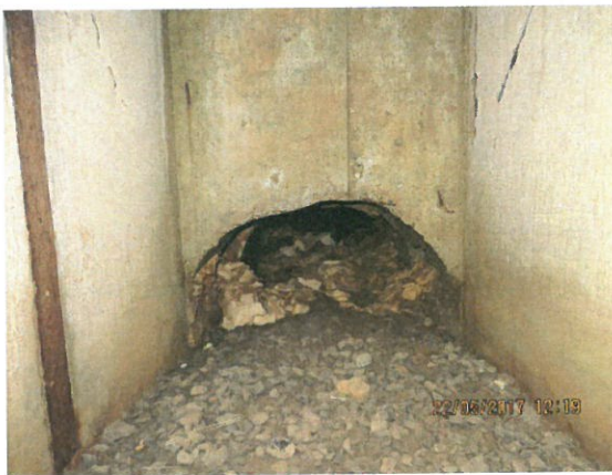
9. Vedere podeț boltit colmatat din interiorul podețului prefabricat
