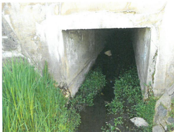
9. Vedere podeț dinspre amonte – degradări (faiențări, crăpături, carbonatări, desprinderi beton, etc.)
