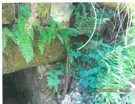
6. Vedere culee Oradea (amonte); moloane degradate timpan
