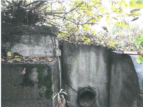
7. Degradări ale betonului de la partea superioară a aripii aval dreapta
