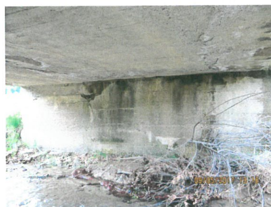
5. Vedere degradări intrados dală beton și infrastructură
