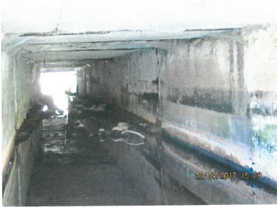
7. Infiltrații de apă în interiorul podețului
