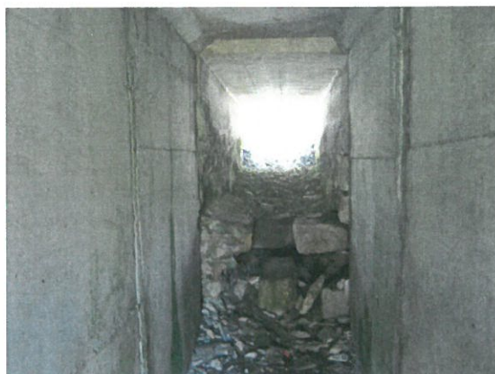
7.Vedere pereu zidărie de piatră degradat
