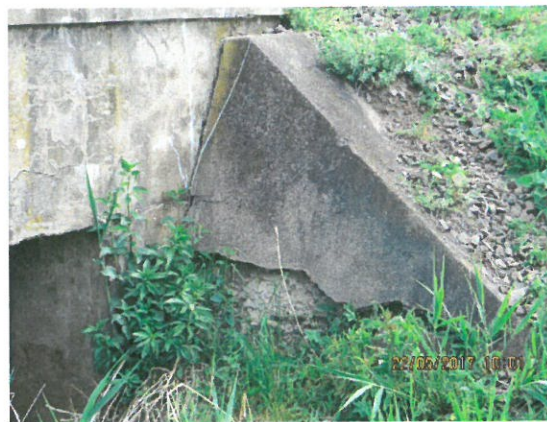
10. Vedere aripă degradată dreapta aval
