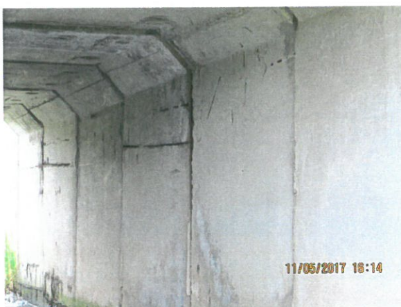
11. Detaliu beton degradat interior podeț
