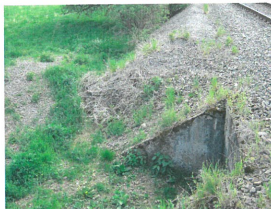
8. Vedere aripă ușor degradată stânga aval
