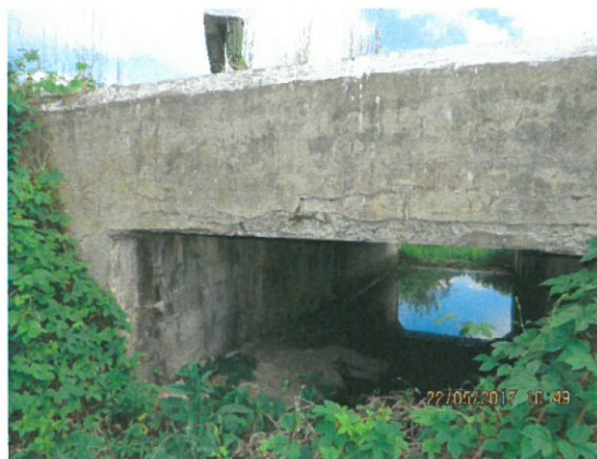
10. Vedere timpan degradat aval
