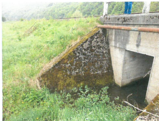
3. Vedere înălțime liberă amonte podet (infiltrații apă)
