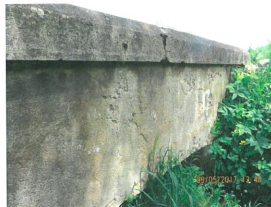
4. Vedere intrados și stagnare apă interior podeț
