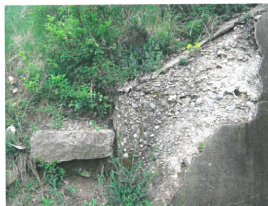
6. Vedere aripa aval degradată
