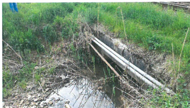
9. Degradări ale suprafeței betonului timpanului aval
