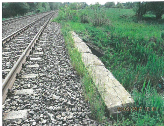
8.Vedere timpan degradat aval
