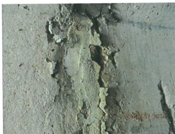
5. Vedere interior degradat podeț dinspre amonte
