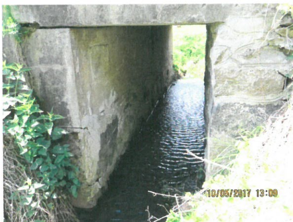
5.Vedere culee Cluj, din amonte, cu degradarea zidăriei din piatră, în zona albiei
