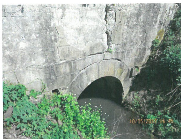
8. Vedere din aval spre podeț – timpan crăpat
