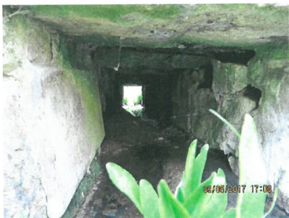
7. Vedere podeț interior dinspre amonte – degradări (carbonatări, dislocări moloane, eroziune la bază, etc)
