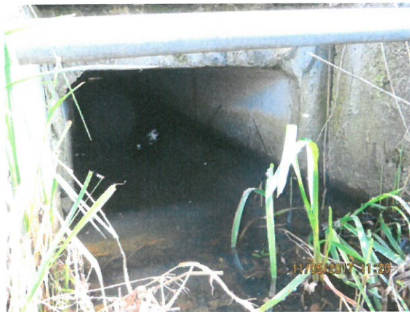
9. Interior podeț din aval – armătură dezvelită
