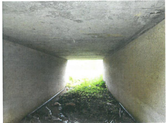
8. Vedere interior podeț – degradări (armătură vizibilă, carbonatări, etc.)
