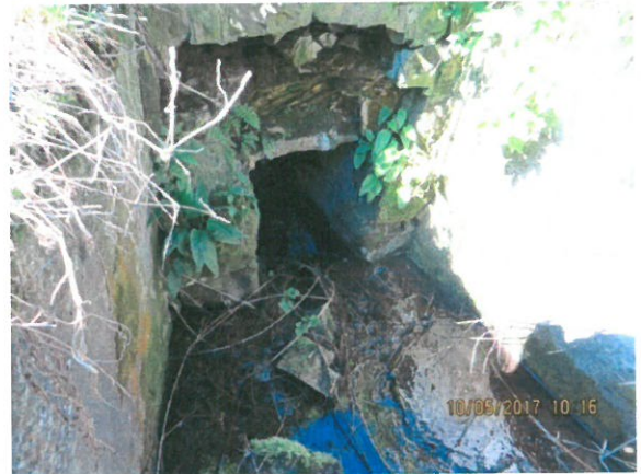
4. Vedere timpan (dinspre amonte) – degradări (distrugere bază timpan și dală marginală, colmatare albie, ziduri de sprijin cu vegetație, crăpături, infiltrații și pete de rugină)
