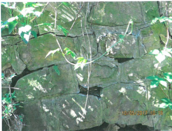
5. Efectul distrugerii bazei timpanului
