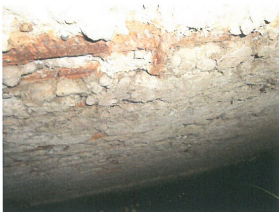
7. Intrados degradat dală de beton
