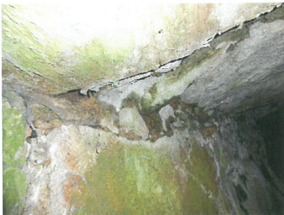
9. Vedere rostului dintre dalele din piatră - degradări
