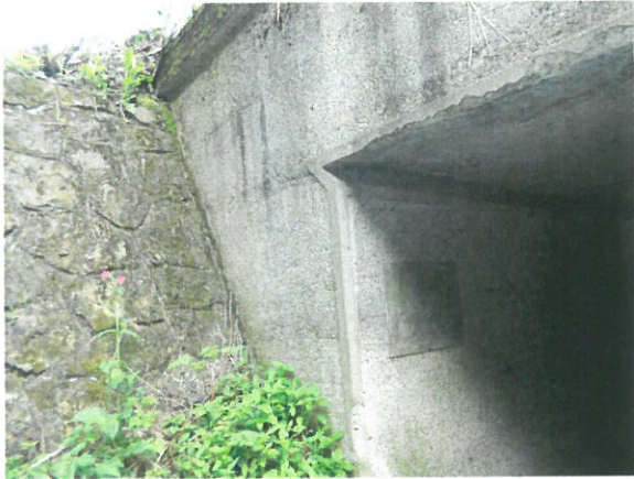
7. Vedere culee Cluj și dală – degradări (ciobituri muchii, crăpături, segregări beton dală, etc.)
