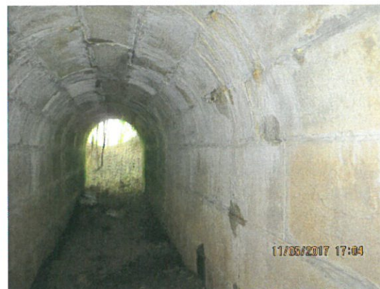
10. Vedere interior podeț boltit infiltrații de apă
