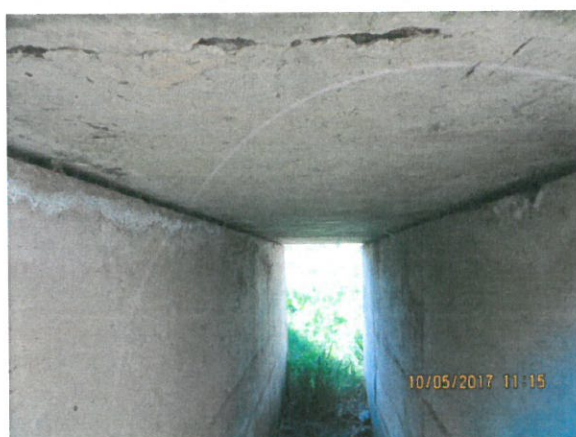
5. Vedere intrados dală – degradări (segregări beton, armatură descoperită, crăpături pe suprafața betonului), și elevație culei – degradări (ciobituri muchie, carbonatări, segregări beton)
