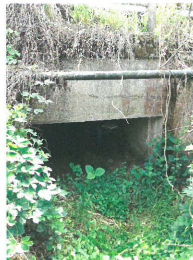
3. Pozare conduite în aval
