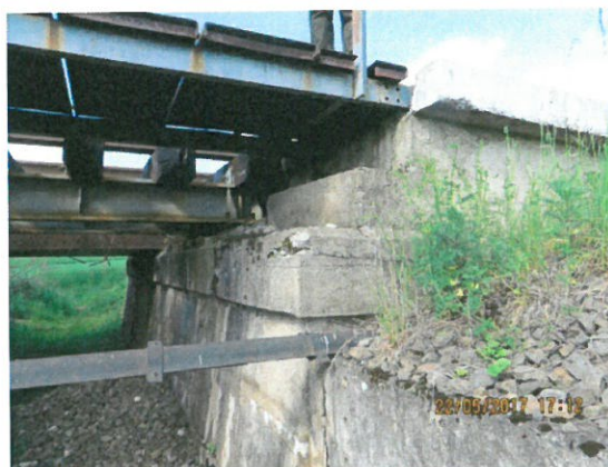
10. Vedere culee degradată aval
