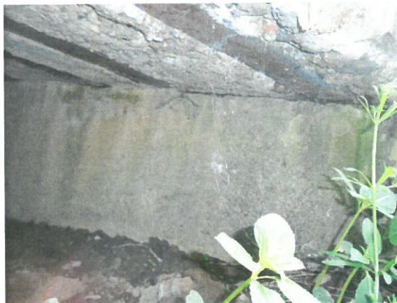
8. Vedere rezemare culee Cluj – degradări (șini descoperite și ruginite, infiltrație apă, pete de rugină, carbonatări, etc.)
