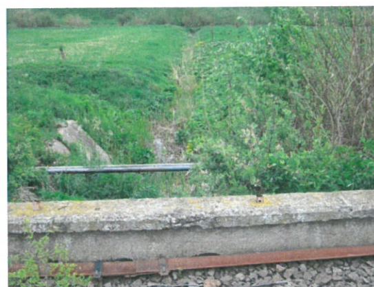
8.Pozare cabluri in albia amonte
