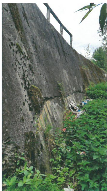
11.Degradări ale suprafeței betonului zidului de sprijin fir I, culee Mera
