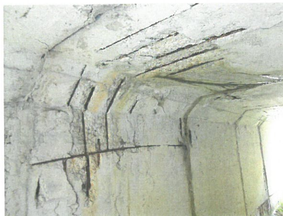
8. Vedere podeț interior – degradări (armături descoperite, infiltrație apă, pete de rugină, carbonatări)
