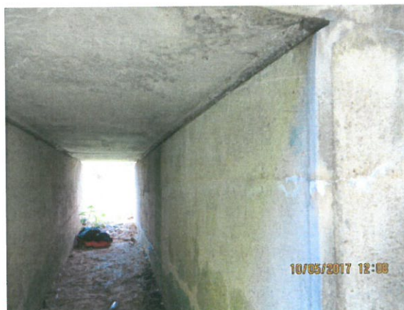
4. Vedere intrados dală, și elevație culee Oradea – degradări (carbonatări, crăpături pe suprafața betonului)
