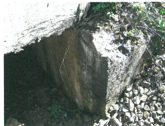
12. Degradarea banchetei cuzineților podeț fir II
