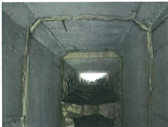
9. Degradarea materialului de umplere a rosturilor dintre cadrele prefabricate
