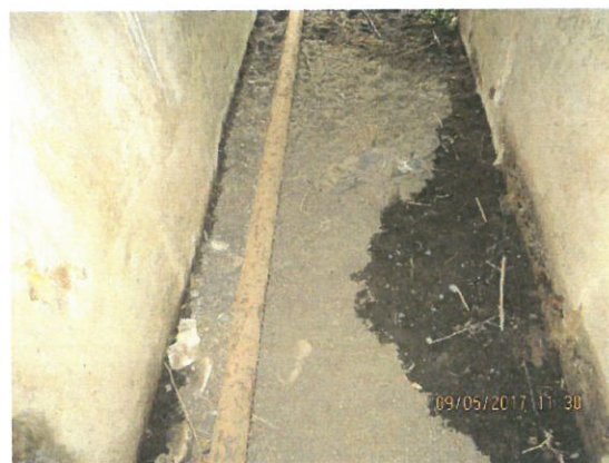
5. Vedere infiltrații apă interior podeț
