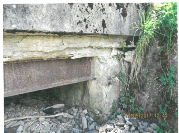
6. Vedere banchetă rezemare culee Cluj (amonte) - degradări
