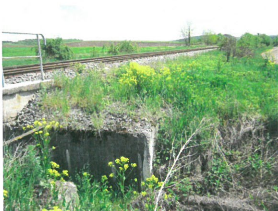
11. Vedere ziduri de sprijin degradat
