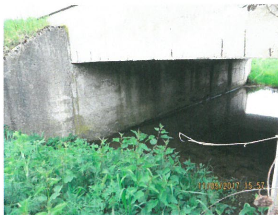
8. Infiltrații Culee stânga din amonte
