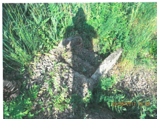
5. Vedere scară de acces din amonte degradată
