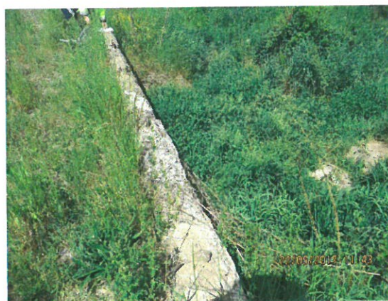
4. Vedere timpan degradat amonte
