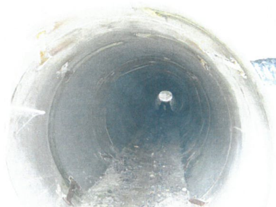
9. Tub din beton armat
