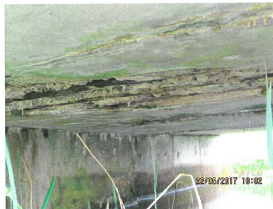
12.Vedere interior corodat podeț dinspre aval
