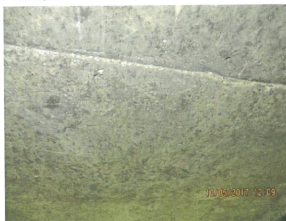
6. Vedere intrados dală – degradări (crăpături pe suprafața betonului)
