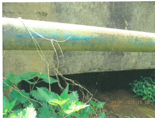
2. Vedere aval podeț (degradări beton în timpan)
