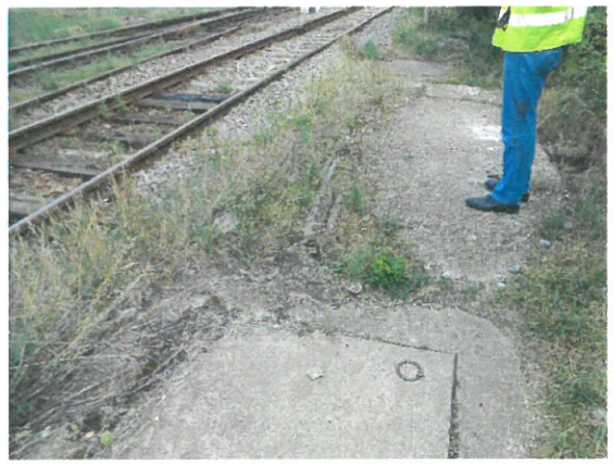
6. Vedere cămine de serviciu
