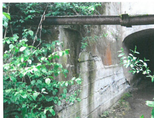
6. Vedere aripa aval degradată
