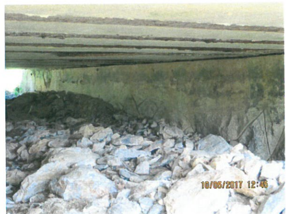
4. Vedere intrados dală, si elevație culee Cluj - degradări
