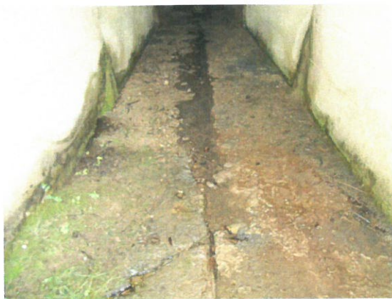
6. Pereu din beton degradat
