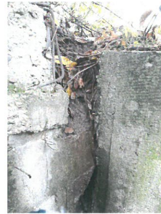
8. Degradări ale betonului aripii dreapta aval la partea superioară la intersecția cu timpanul
