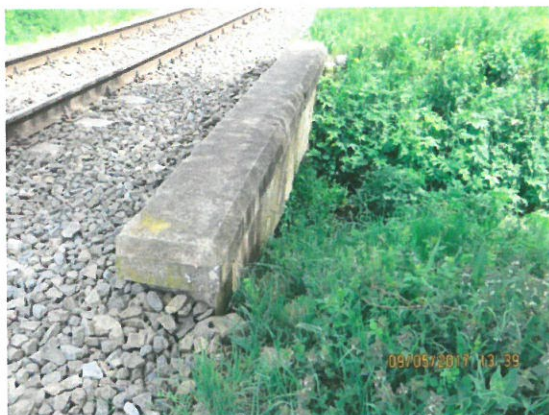
3. Vedere înălțime liberă amonte podeț (infiltrații apă)
