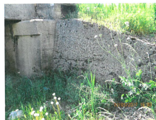
6.Vedere aripă degradată amonte
