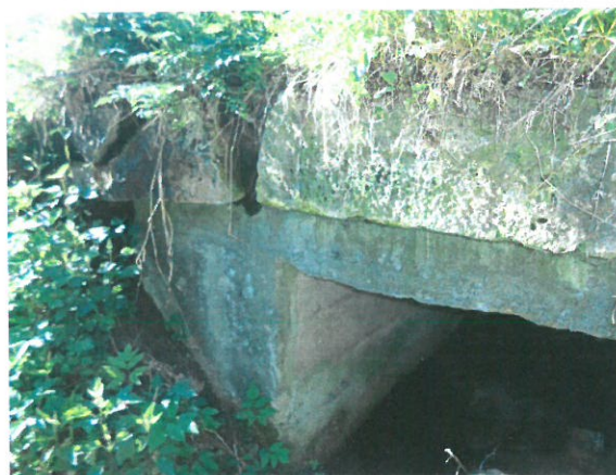
6. Vedere racordare cu terasamentul (dinspre amonte) cu degradări (desprindere molon) – spre Oradea
