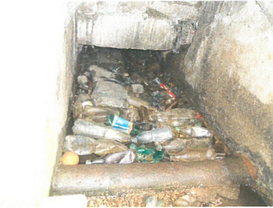
7. Vedere albie de la intradosul dalei din amonte de podețul dalat de pe firul II
