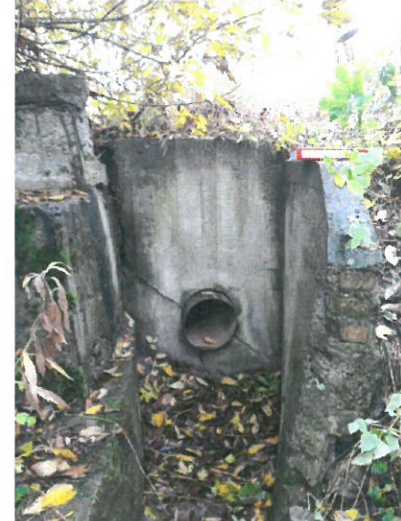
10. Degradări ale betonului aripii stânga aval
