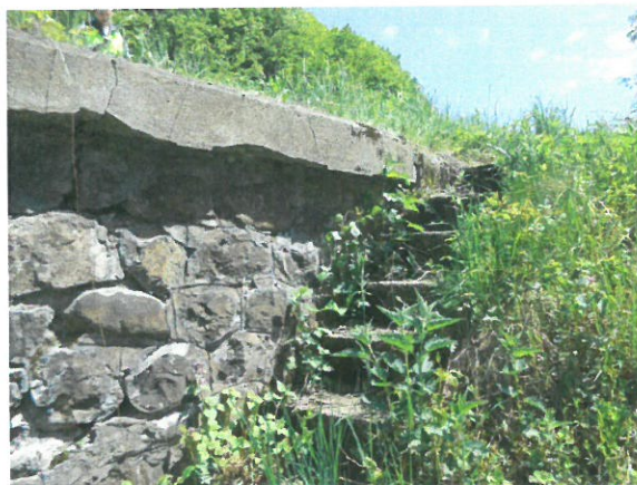
8. Vedere racordare cu terasamentul și scară (dinspre aval) – culeea Cluj – degradări (crăpături beton coronament, etc.)
