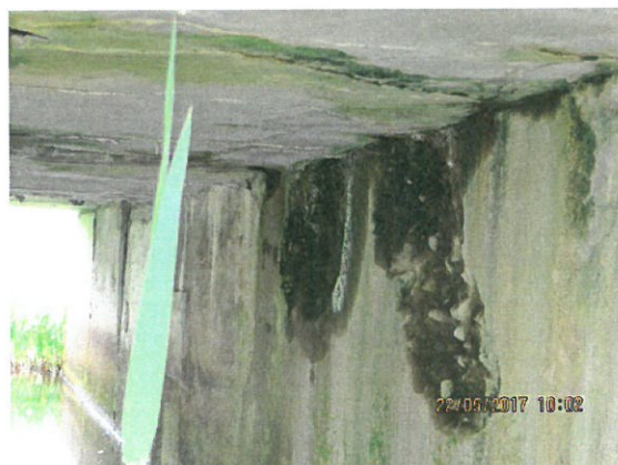
11.Vedere interior corodat podeț dinspre aval
