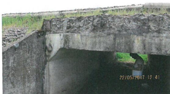
5. Vedere timpan degradat amonte
