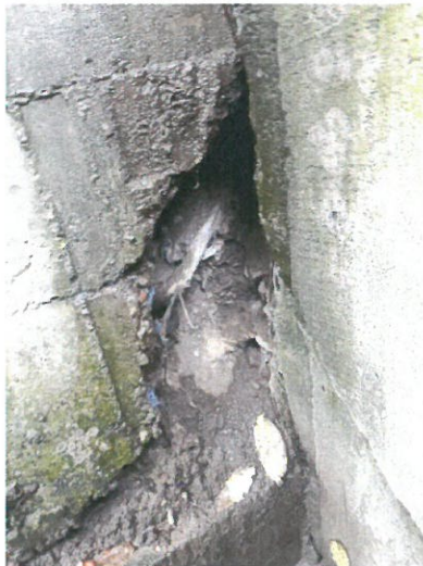
9. Degradări ale betonului aripii dreapta aval la partea inferioară la intersecția cu timpanul
