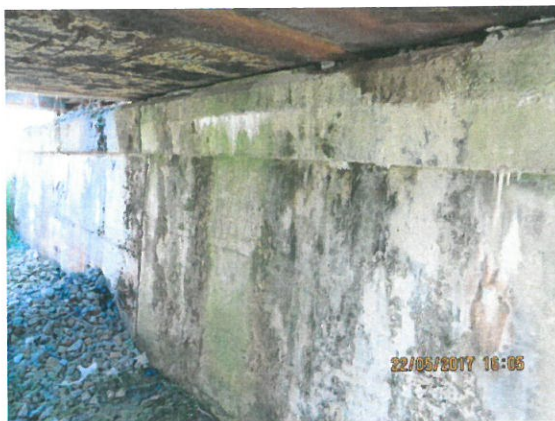
7.Vedere culee degradată podeț dalat
