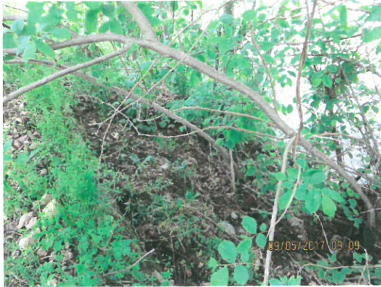
1. Vedere podet colmatat
