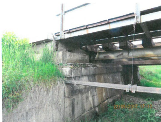
11. Vedere culee degradată aval
