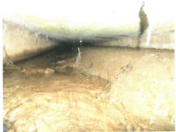
10. Vedere interior podeț dinspre aval - colmatare
