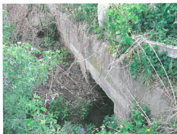
5.Vedere timpan și parapet degradat aval
