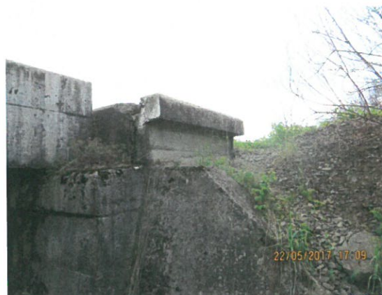
6.Vedere zid întors degradat amonte
