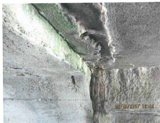
8. Vedere interior cadru C3 corodat
