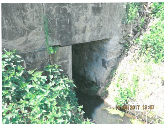
7. Vedere culee Oradea, din amonte, cu degradarea zidăriei din piatră, în zona albiei
