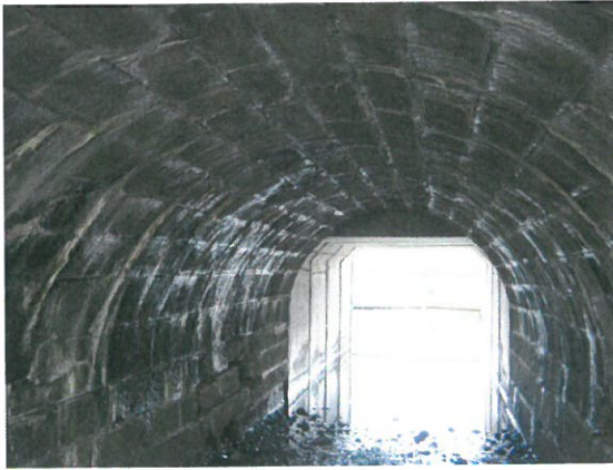
7.Vedere interior podeț boltit cu infiltrații de apă
