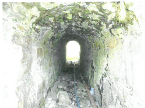
6. Vedere interior podet dinspre amonte- degradări (moloane sparte, carbonatări, infiltrații, colmatare, etc.)
