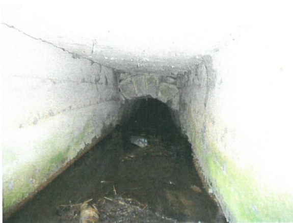
7. Vedere interior podeț dinspre amonte - degradări (carbonatări, segregări, eroziune la bază, etc)
