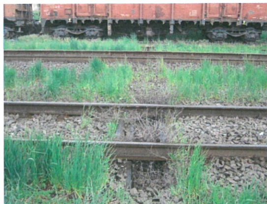
4. Vedere prindere șină neconformă
