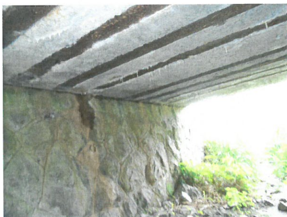
7. Vedere intrados dală, si elevație culee Cluj - degradări
