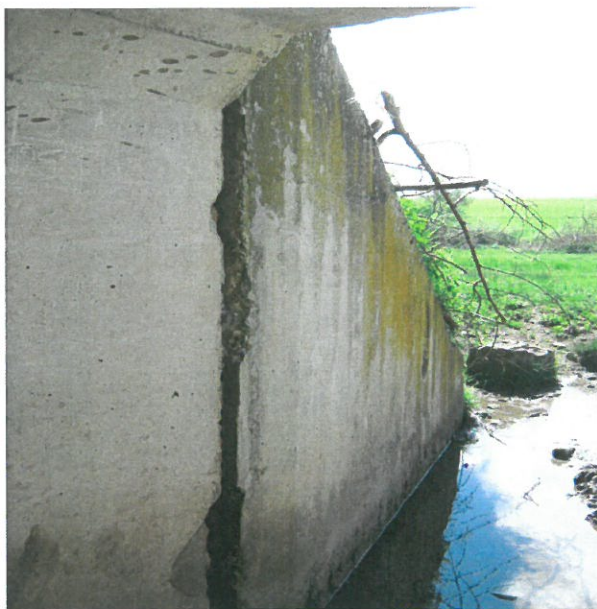
7. Vedere aripă aval ușor degradată
