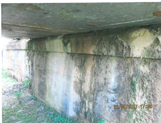
7. Vedere infiltrații de apă interior podeț dalat
