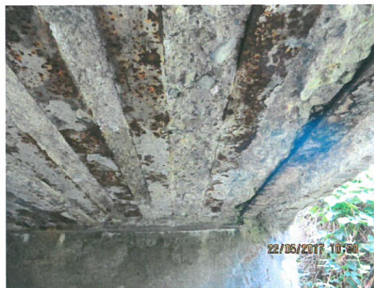
12. Vedere intrados dală din beton degradată
