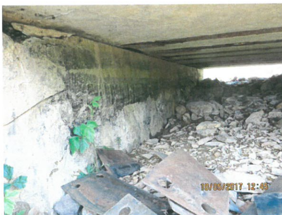
5. Vedere intrados dală, si elevație culee Oradea - degradări
