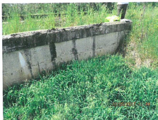
5. Vedere dală degradată amonte
