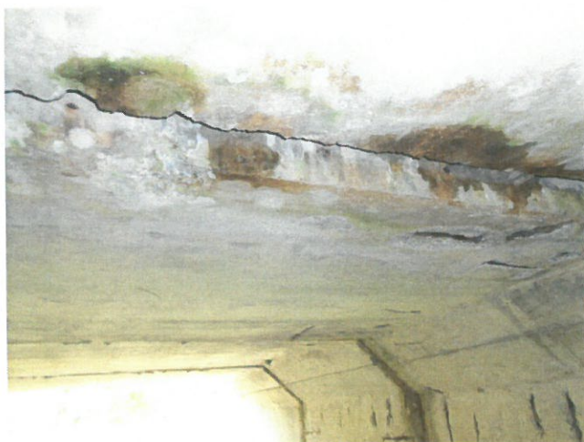
9. Detaliu infiltrații rost cadre tip C3 la intrados
