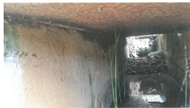
11. Pozare conducte între timpanul aval și drumul din vecinătate
