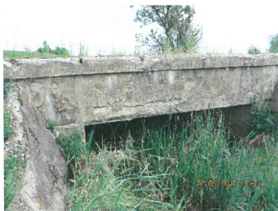
9. Vedere elevație degradată aval
