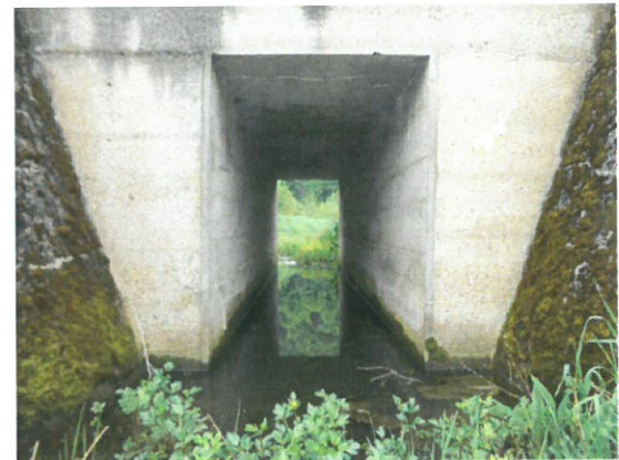
4. Vedere intrados și stagnare apă interior podet
