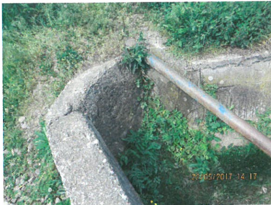
3. Vedere timpan degradat amonte
