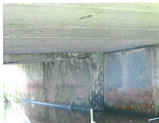
6.Vedere infiltrații de apă în interiorul podețului
