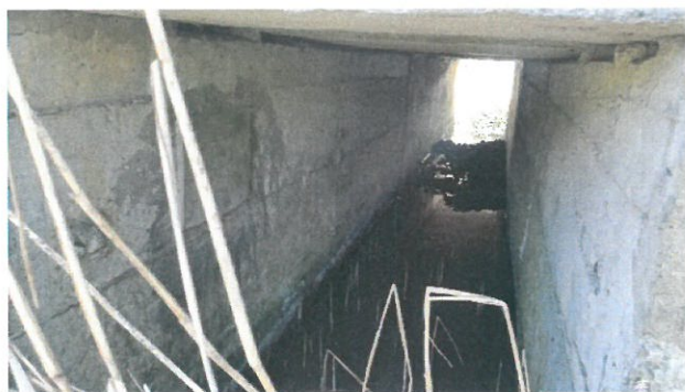
10. Degradări ale elevației culeelor
