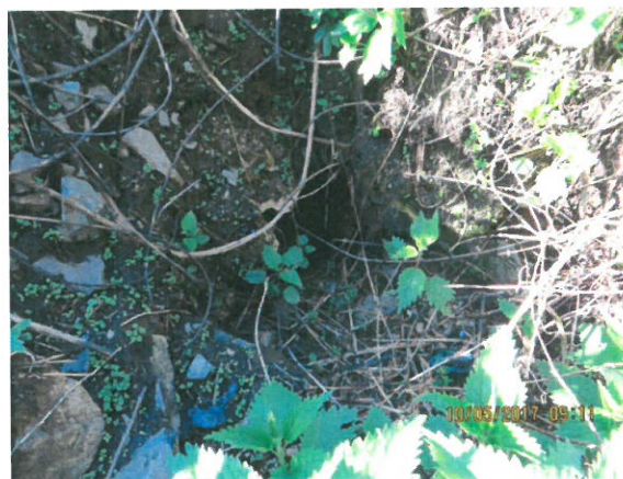
6. Vedere detaliu podet din amonte - degradări (timpan distrus, zid de sprijin pentru albie distrus, colmatare albie și podet)
