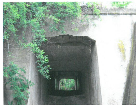
6. Vedere timpan aval și tronson monolit degradat
