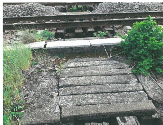
12. Pozare cabluri între firele I și II
