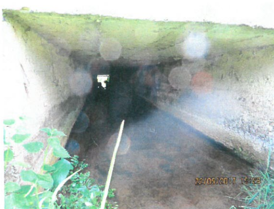
5. Vedere elevație culee degradată dinspre amonte
