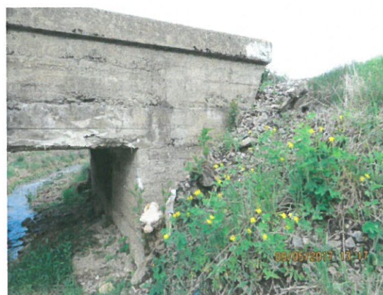
2. Vedere racordări distruse
