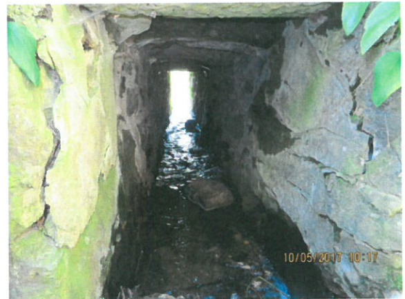
6. Vedere interior podet din amonte - degradări (dale măcinate, elevații erodate de apa curgătoare la bază, moloane desprinse prezente în albie, zidărie deplasată, prezența infiltrațiilor)
