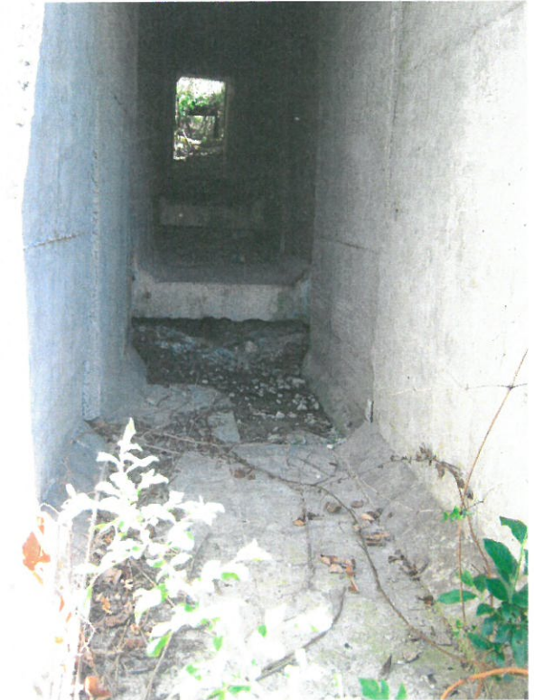
8. Degradare beton dintre cadrele prefabricate dispuse la înălțimi diferite
