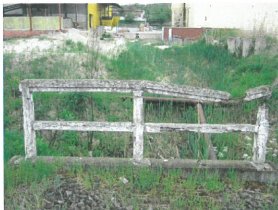
3.Vedere albie amonte și timpan degradat
