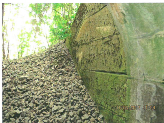
9. Vedere intrare colmatată în podeț dinspre aval
