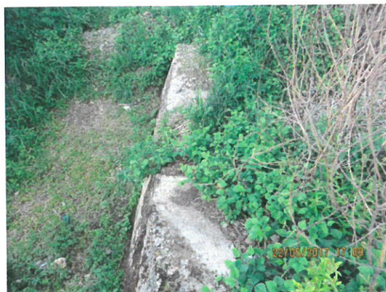
5. Vedere aripă degradată din amonte
