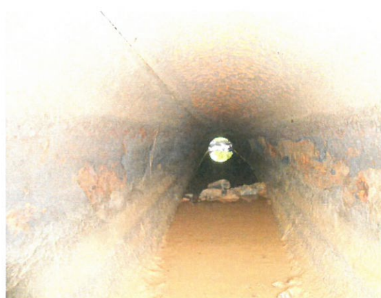
11. Colmatarea și coroziunea podețului tubular
