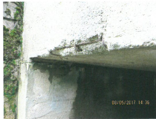
4. Degradare strat de acoperire beton
