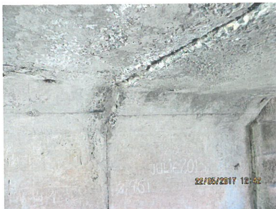
7. Vedere interior cadru C3 corodat
