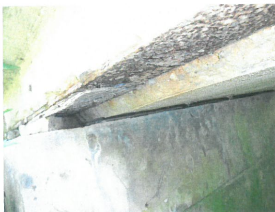
8. Vedere banchetă culee Cluj amonte si grindă metalică marginală – degradări (grindă metalică marginală descoperită și corodată, crăpături beton, carbonatări etc.)
