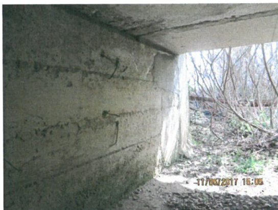
11. Ieșire din podeț – aval tecă cu cabluri
