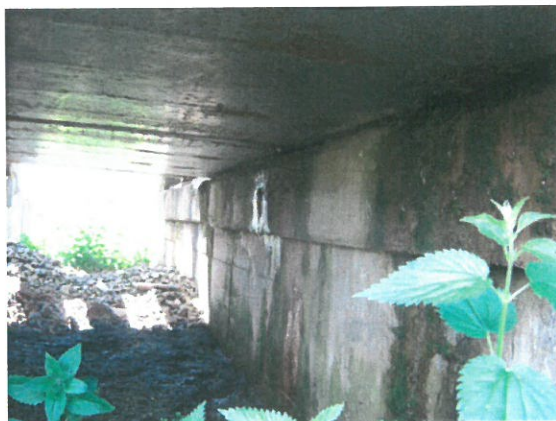
7. Vedere infiltrații de apă interior podeț dalat
