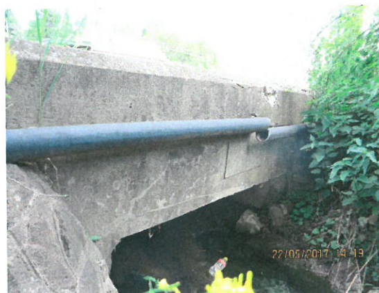
8. Vedere timpan degradat aval
