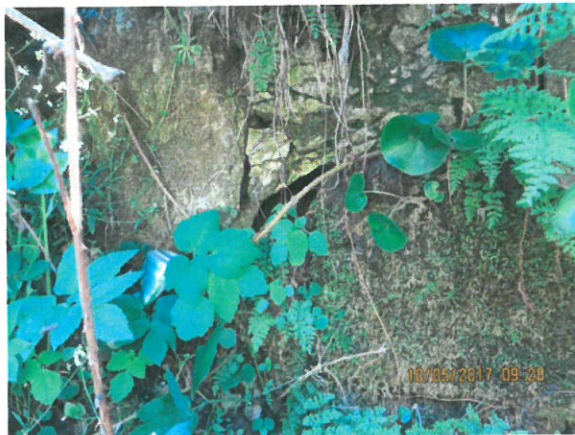
7. Vedere culee Oradea (amonte); moloane degradate timpan
