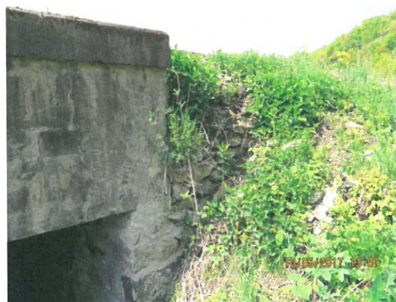
6.Vedere zid întors si sfert de con (degradate), culee Oradea, amonte
