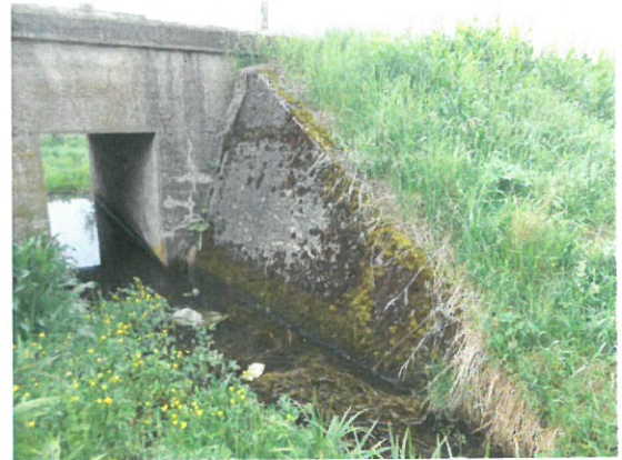
2. Vedere aval podet (degradări beton în timpan)
