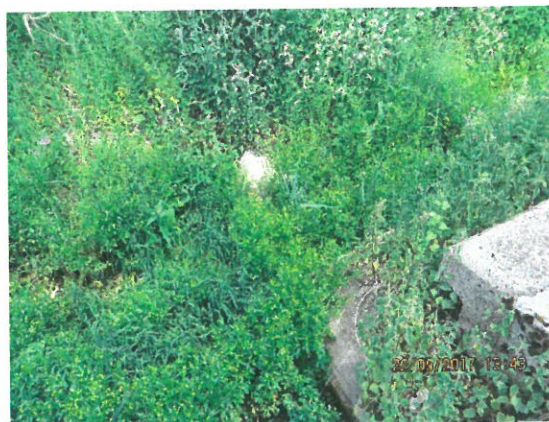
8. Vedere aripă degradată și acoperită de vegetație aval
