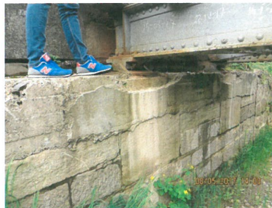
4. Vedere degradari beton infrastructura
