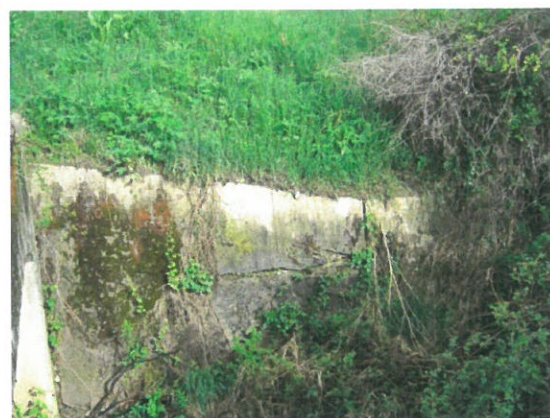
5. Vedere aripa amonte degradată
