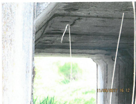
8. Degradări ale betonului la rosturi
