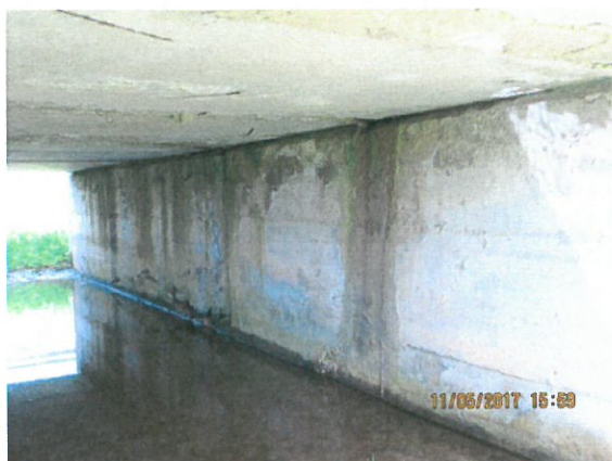
9. Detaliu beton degradat culee dreapta din aval
