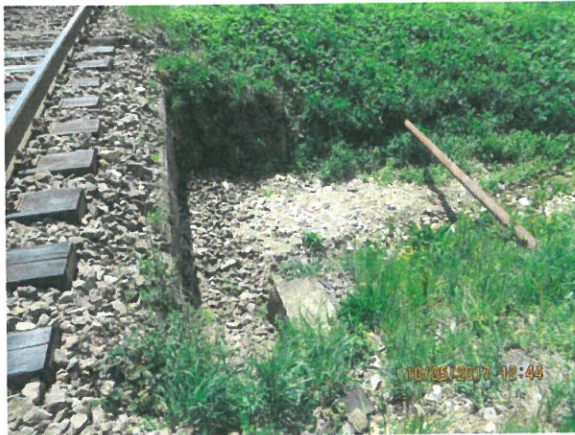
7. Aripă aval culee Cluj – degradări; conductă
