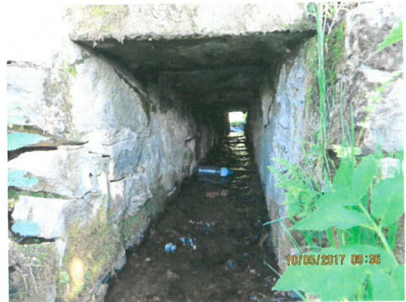
10. Vedere interior podeț din aval; culei degradate (moloane deplasate)
