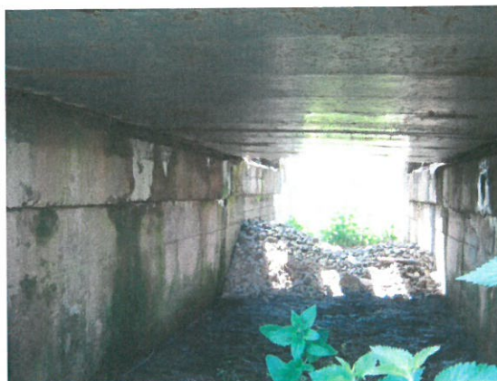
8. Vedere interior podeț colmatat
