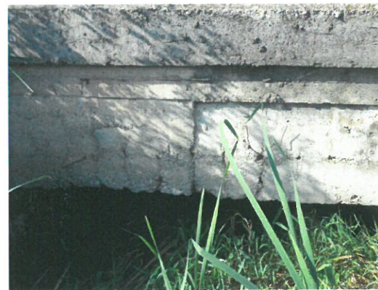
12. Vedere dală timpan degradată
