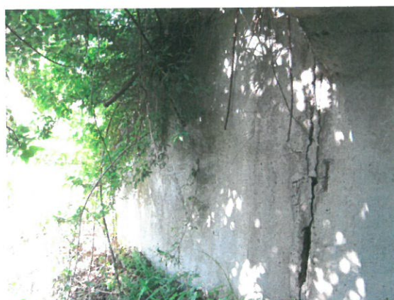
11. Vedere aripă ușor degradată aval
