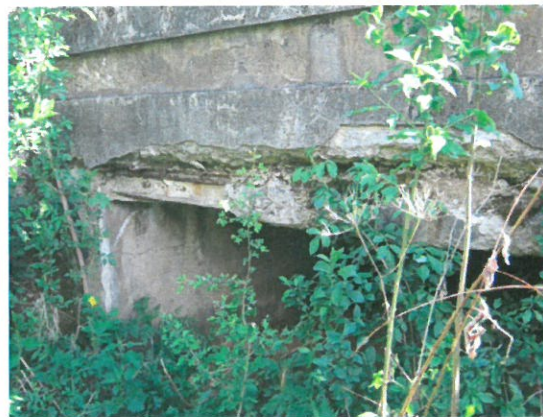
4. Vedere dală marginală amonte degradată
