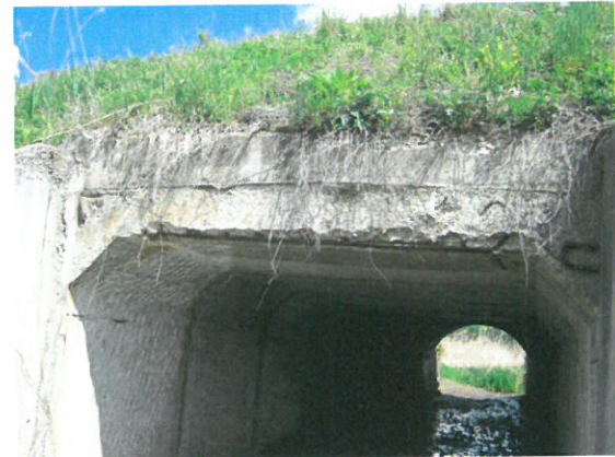
10.Vedere timpan degradat aval
