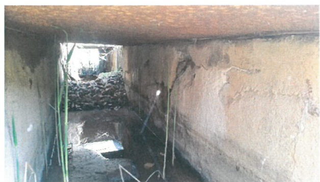
10. Degradări ale elevației culeei Cluj Napoca
