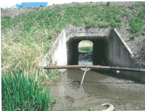
11.Vedere elevație degradată aval
