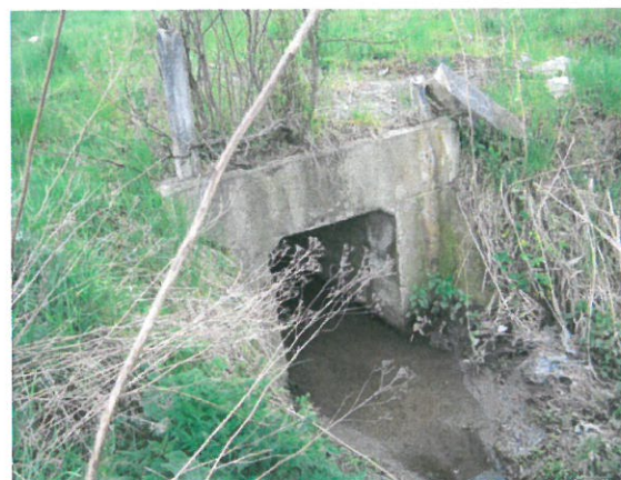
6. Vedere timpan și parapet amonte degradat
