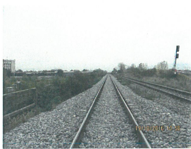
2. Calea și tipul traverselor pe Firul II
