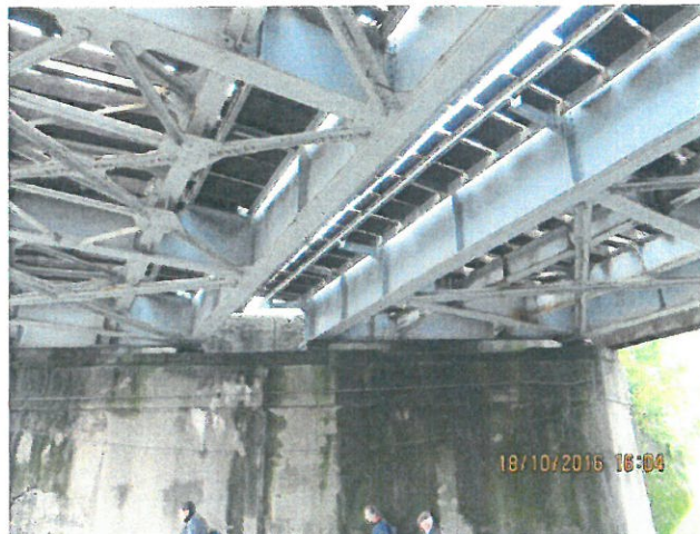
10. Vedere intrados tablier firele I și II. Degradări culee
