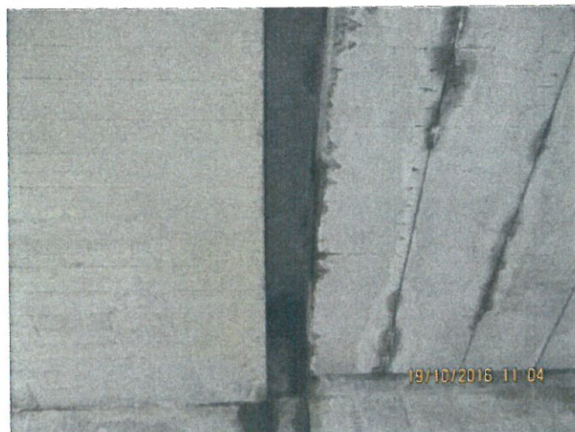
15. Vedere intrados tablier culeea Cluj. Infiltrații în zona rostului între tabliere
