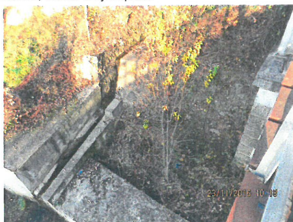
17. Zid de sprijin și șanț de colectare în Amonte, Culee Oradea
