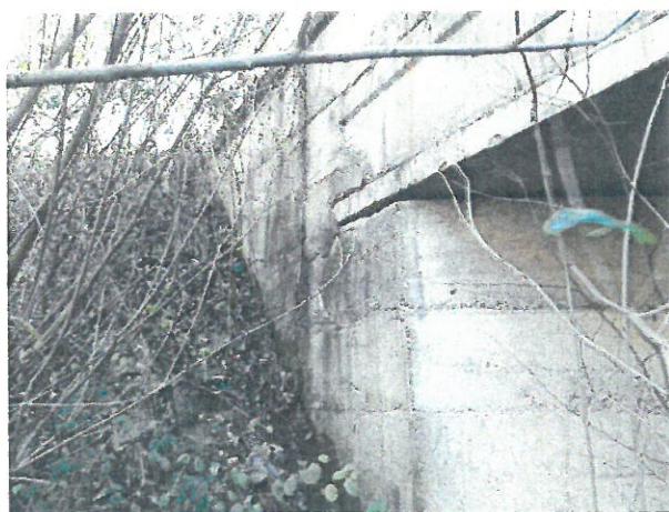
11.Taluz pereiat Culee Cluj Napoca, în Amonte
