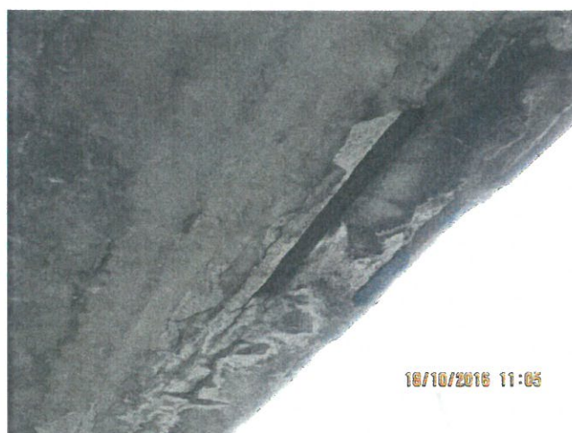
17. Vedere intrados tablier fir I. Degradări.
