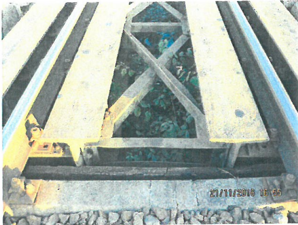
13. Cadru transversal de capăt și contravântuire superioară, Culeea Oradea, deformat
