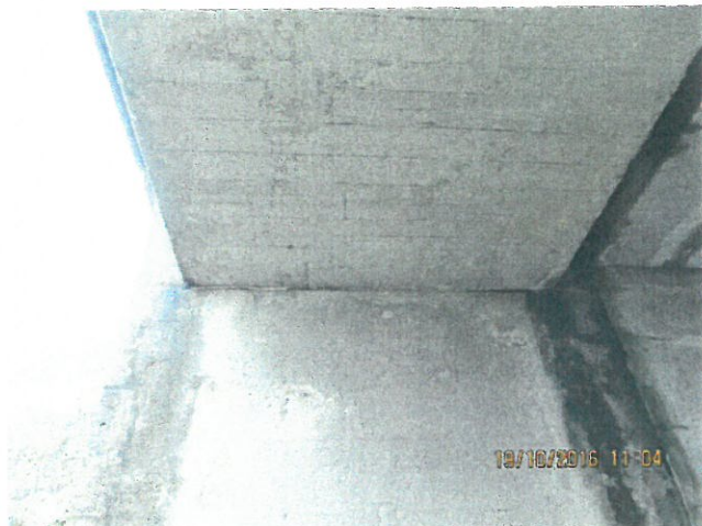
13. Vedere intrados dală culeea Cluj (firul I). Infiltrații în zona rostului între tabliere
