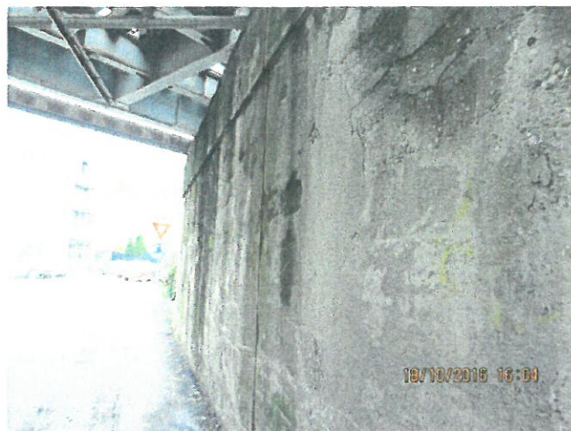
7. Degradări culee Cluj fir II
