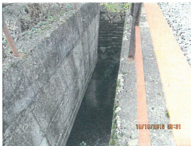
6. Parapet metalic firul II amonte. Spațiu între tablielele existente
