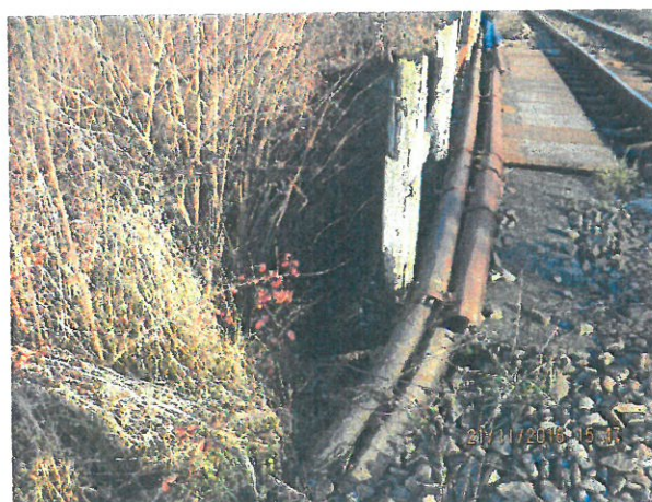
12. Parapet de beton pe zidul întors al culeei Oradea degradat
