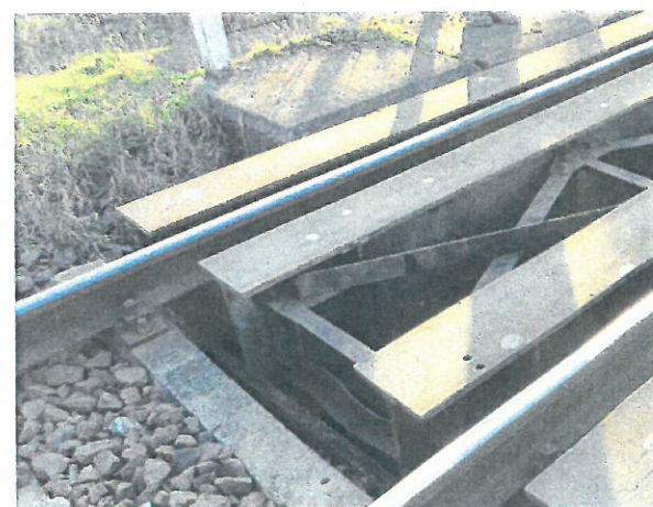
12.Cadru transversal de capăt, Culeea Cluj Napoca, deformat
