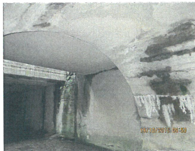
12. Vedere boltă Oradea. Infiltrații intrados boltă. Infiltrații intrados dală
