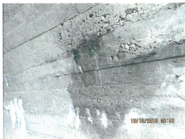
9. Infiltrații intrados boltă. Vedere Oradea.
