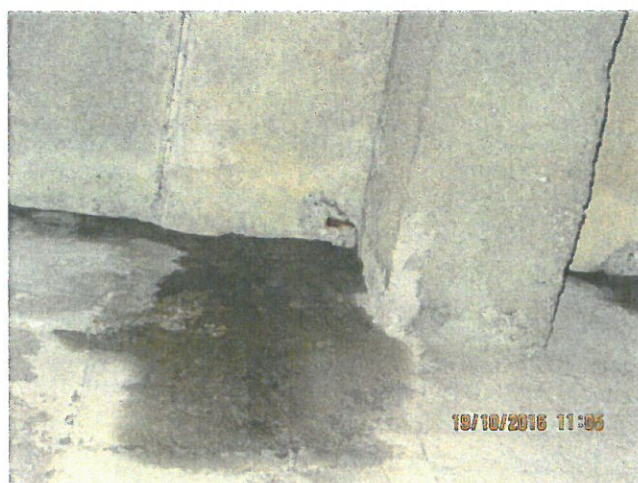
21. Infiltrații elevație culee Cluj, la intradosul grinzilor
