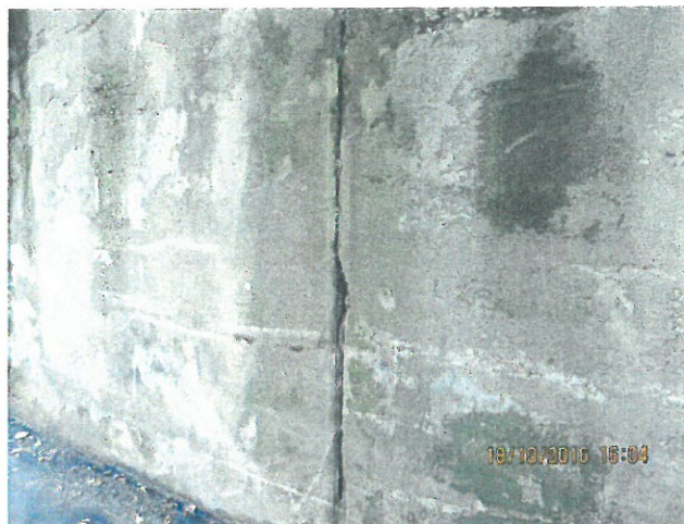
8. Degradări culee Cluj in zona rostului
