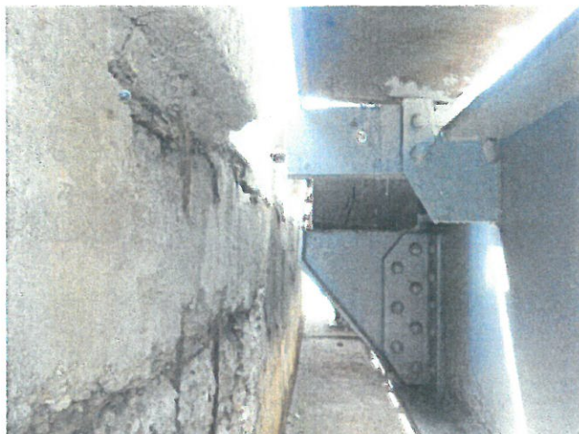
9. Bancheta culee Cluj fir I. Armătura la vedere
