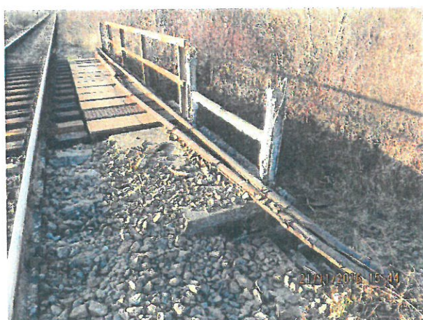
11. Parapet de beton pe zidul întors al culeei Cluj Napoca degradat
