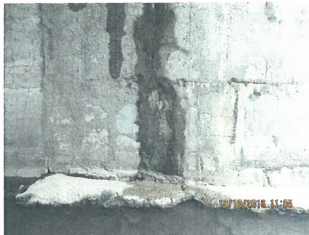
20. Infiltratii elevație culee Cluj
