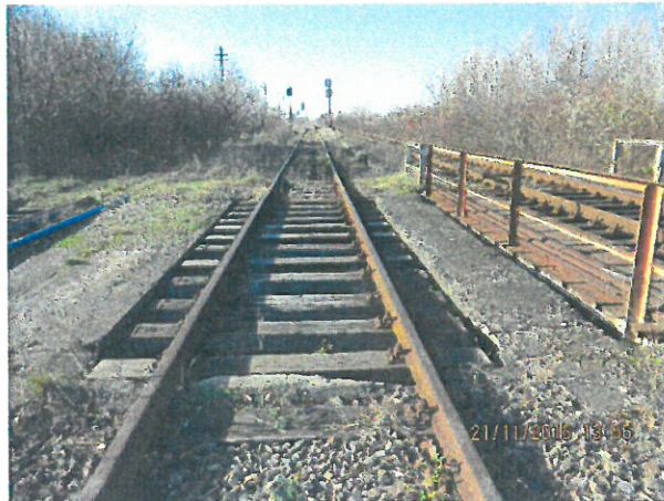
3.Calea și tipul traverselor, pe Firul II
