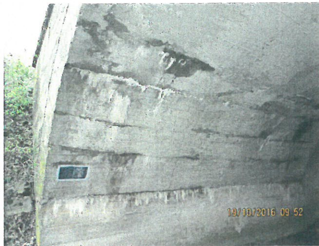
8. Infiltrații intrados boltă. Vedere Cluj.
