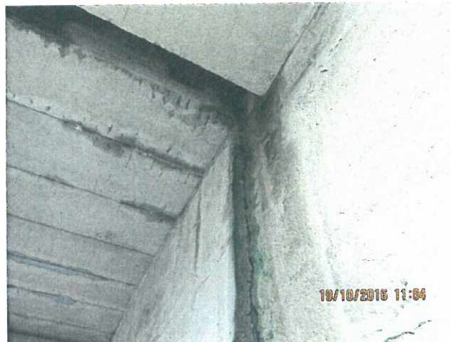
14. Vedere intrados tabliere culeea Oradea. Infiltrații în zona rostului între tabliere
