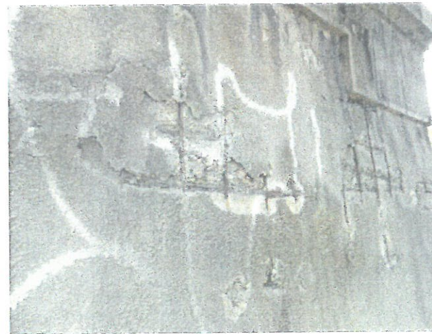
18. Vedere pilă. Degradare pilă. Armătură la vedere
