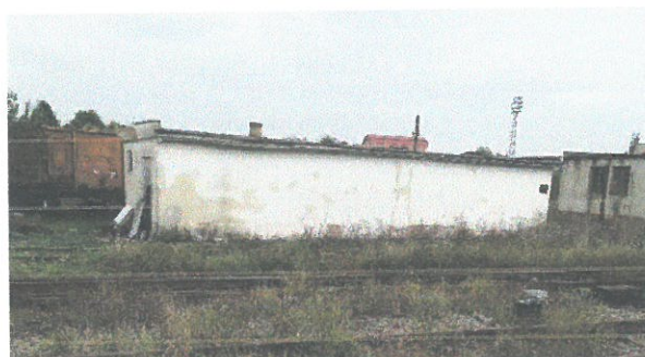
Infiltrații, pete de mucegai
