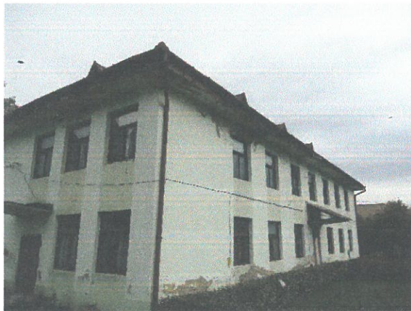
Tencuieli cu infiltrații
