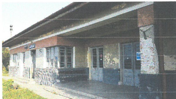
Crăpături ale tencuielii, exfolieri
