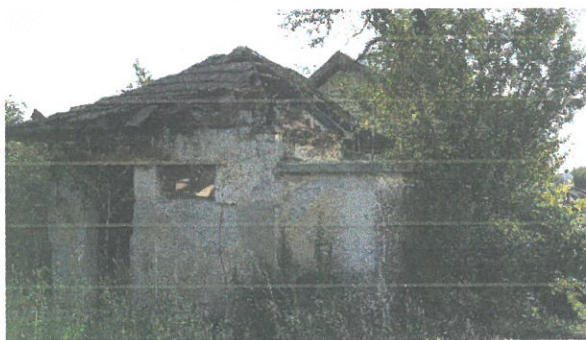
Crăpături ale tencuielii, desprinderi acoperiș, exfolieri
