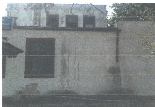
Crăpături ale tencuielii, exfolieri
