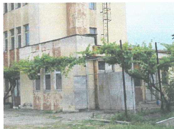
Exfolieri, desprinderi ale tencuiei exterioare
