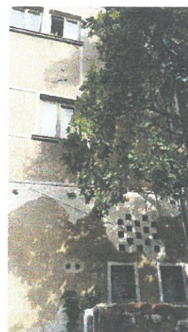
Crăpături ale tencuielii, exfolieri
