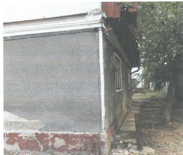
Crăpături ale tencuielii, exfolieri
