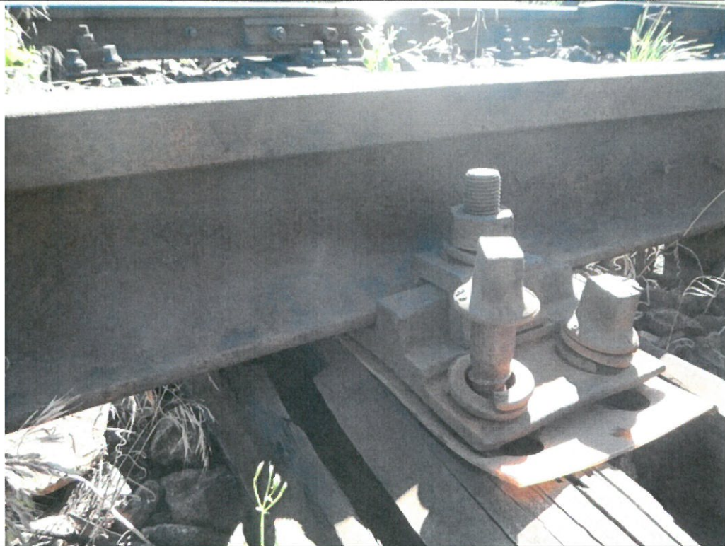
Tirfoane ieșite din dibluri, placă de polietilenă deplasată, traversă degradată
