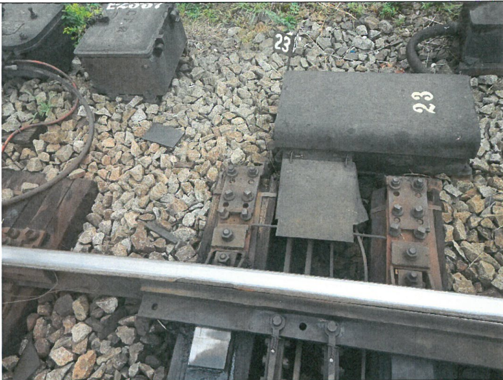
Exfoliere pe suprafața de rulare în zona aparatului de cale
