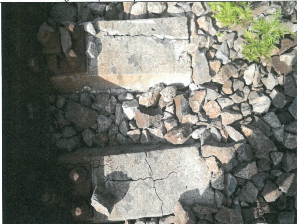
Traverse de beton degradate pe capete
