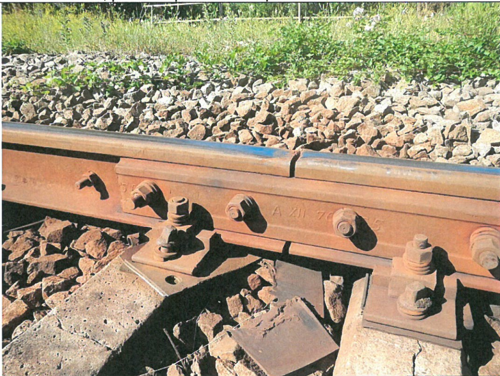
Tirfon cu inel resort inactiv, placă de polietilenă deplasată
