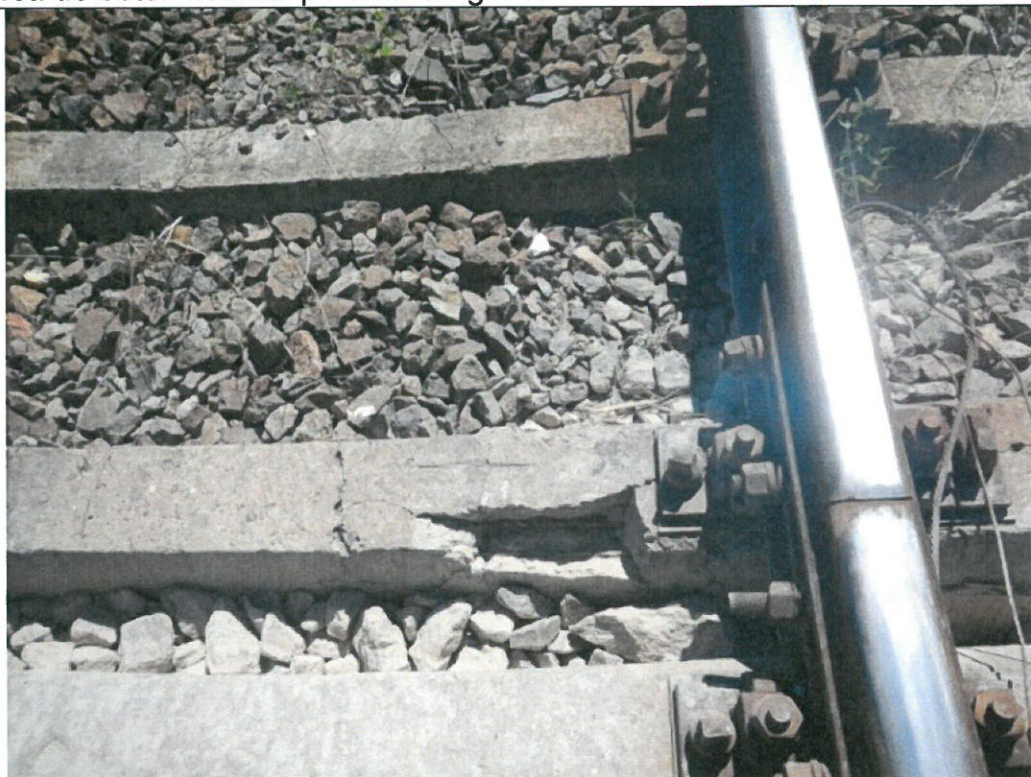
Traversă de beton fisurată transversal și degradată pe zona prinderii
