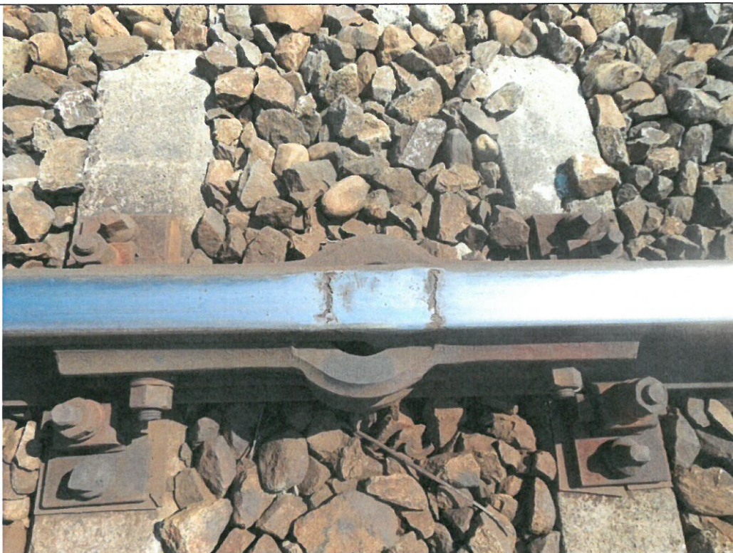
Sudură defectuoasă. Degradarea șinei în dreptul sudurii.
