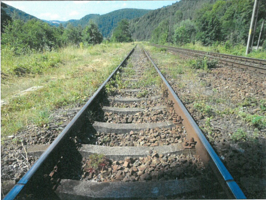
Piatră spartă insuficientă
