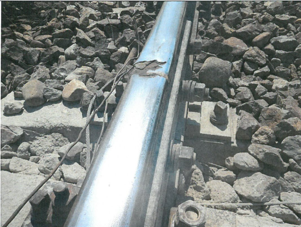
Desprinderi de material la capătul șinelor de la joantă
