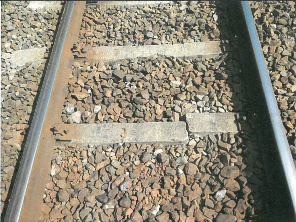
Traversă de beton ruptă transversal
