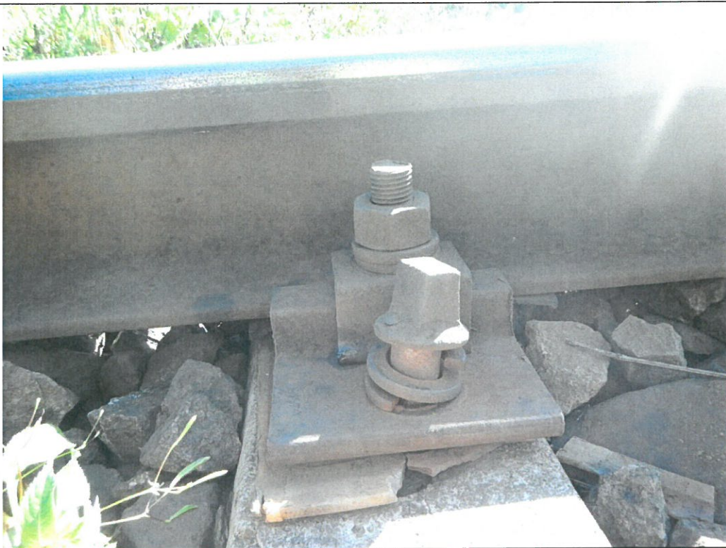
Tirfon ieșit din diblu, placa de polietilenă ruptă
