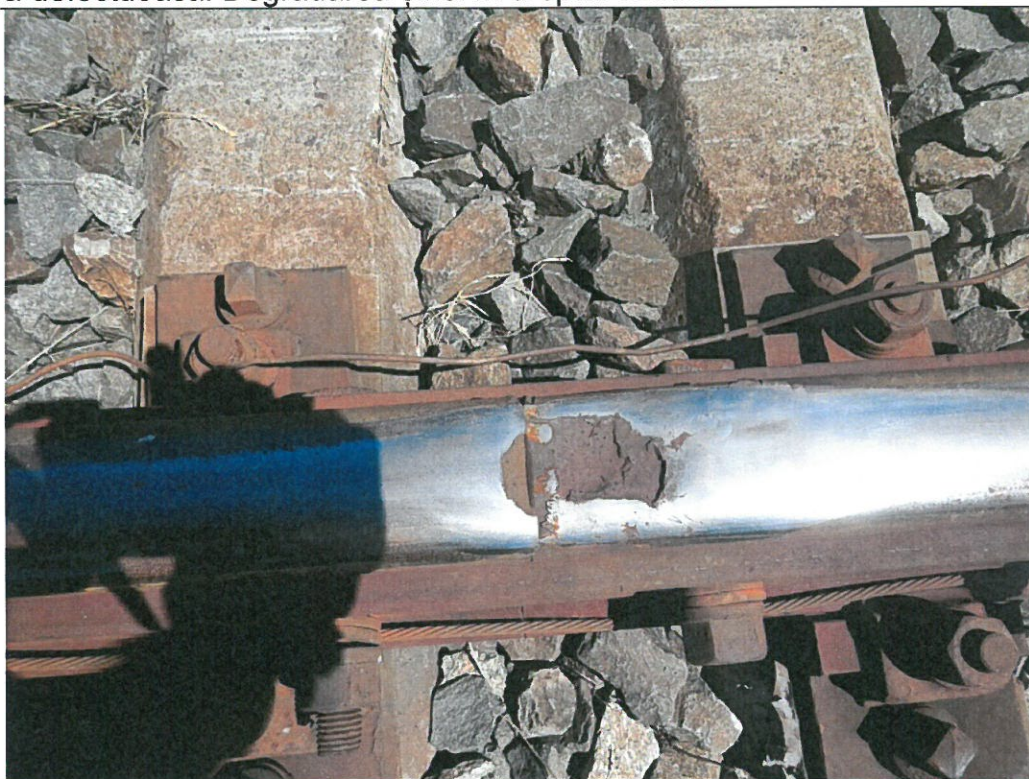
Turtiri și desprinderi de material de pe porțiunea călită de la capătul șinelor
