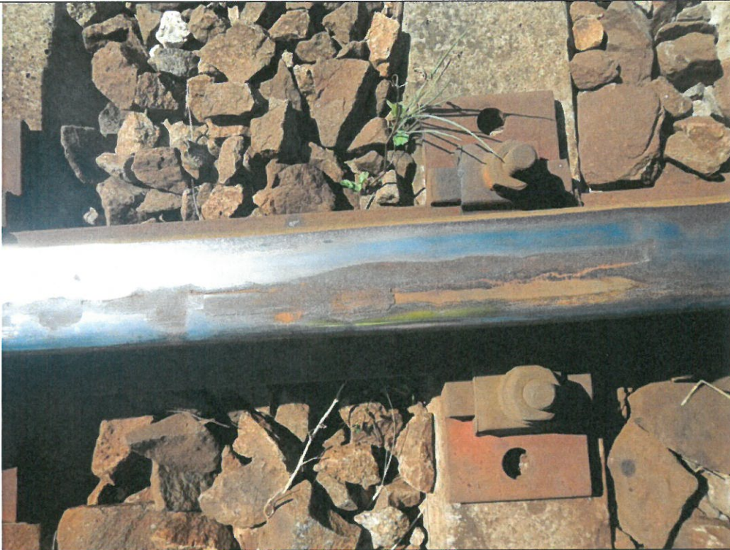
Știrbituri pe muchia de rulare, din cauza rezistenței de contact insuficiente a șinei (oboseala materialului)
