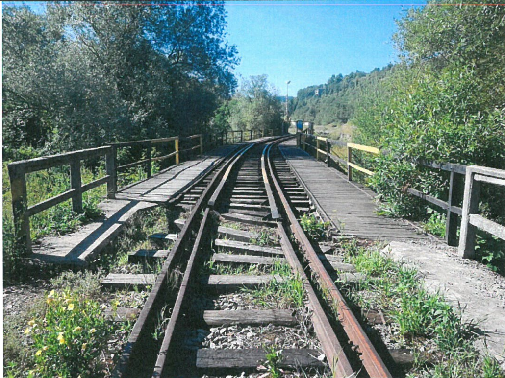
Traverse de lemn pe poduri, crăpate pe toată lungimea
