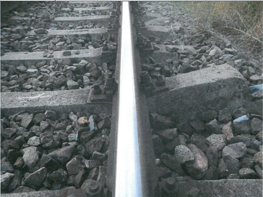
Traversă ruptă în zona prinderii
