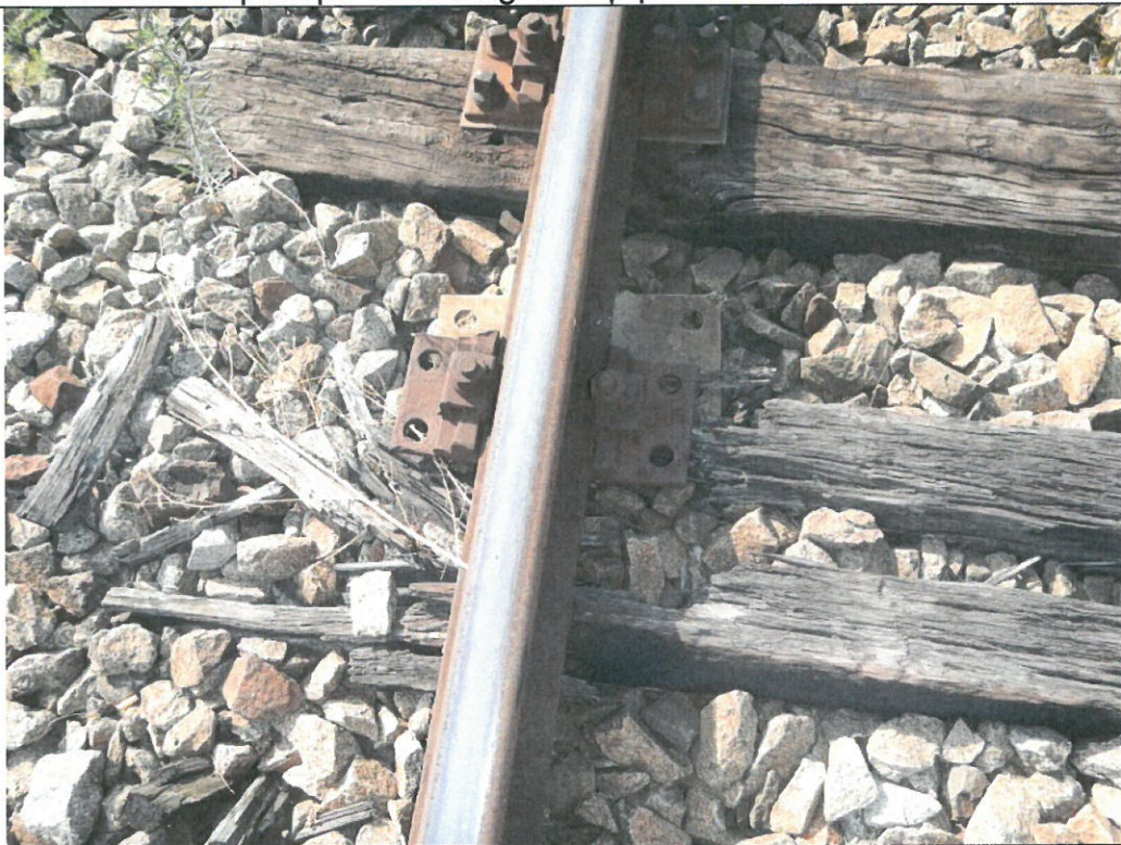
Traversă de lemn ruptă în zona prinderii, prindere incorectă
