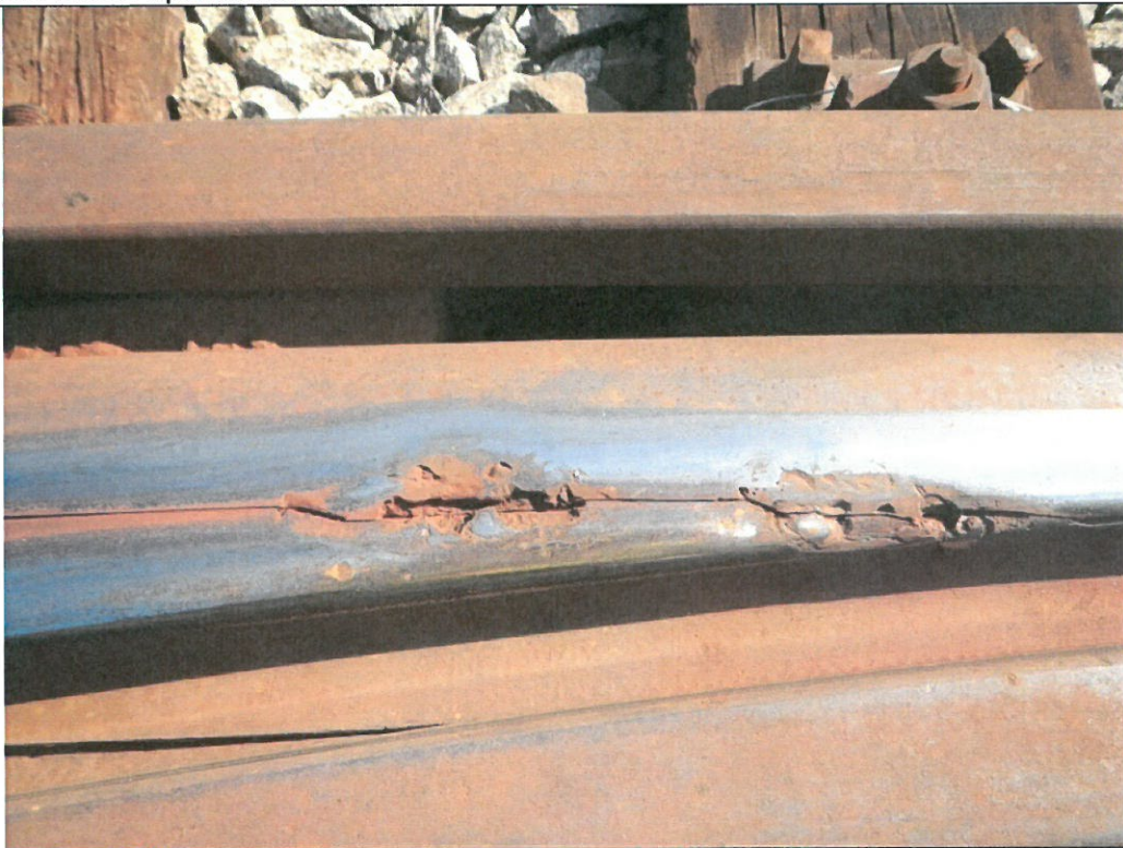
Uzuri ale inimii aparatului de cale
