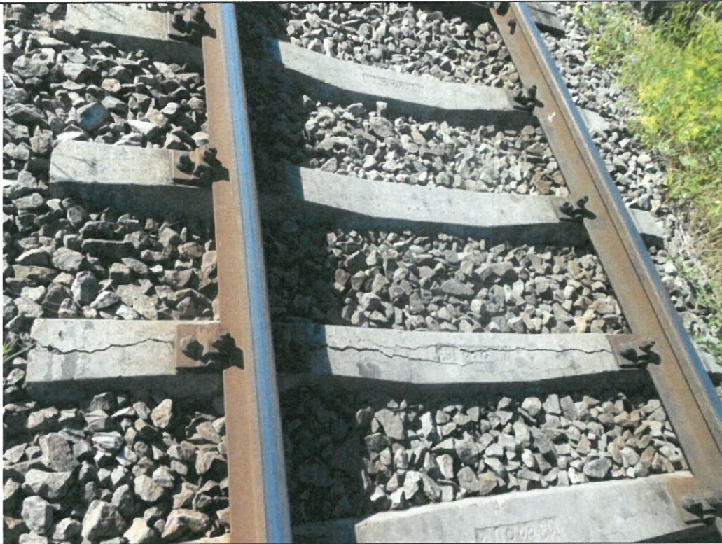
Traversă de beton fisurată pe toată lungimea
