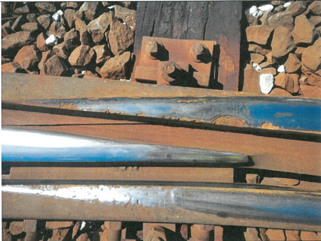
Uzuri ale inimii aparatului de cale
