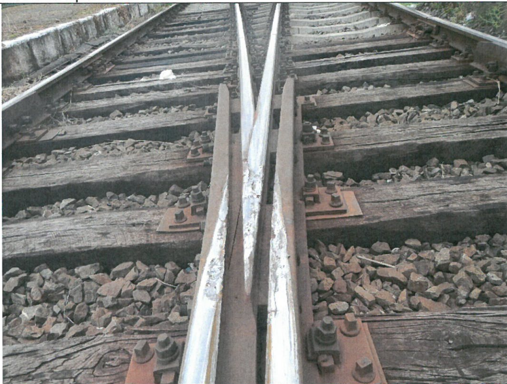
Uzuri ale inimii aparatului de cale
