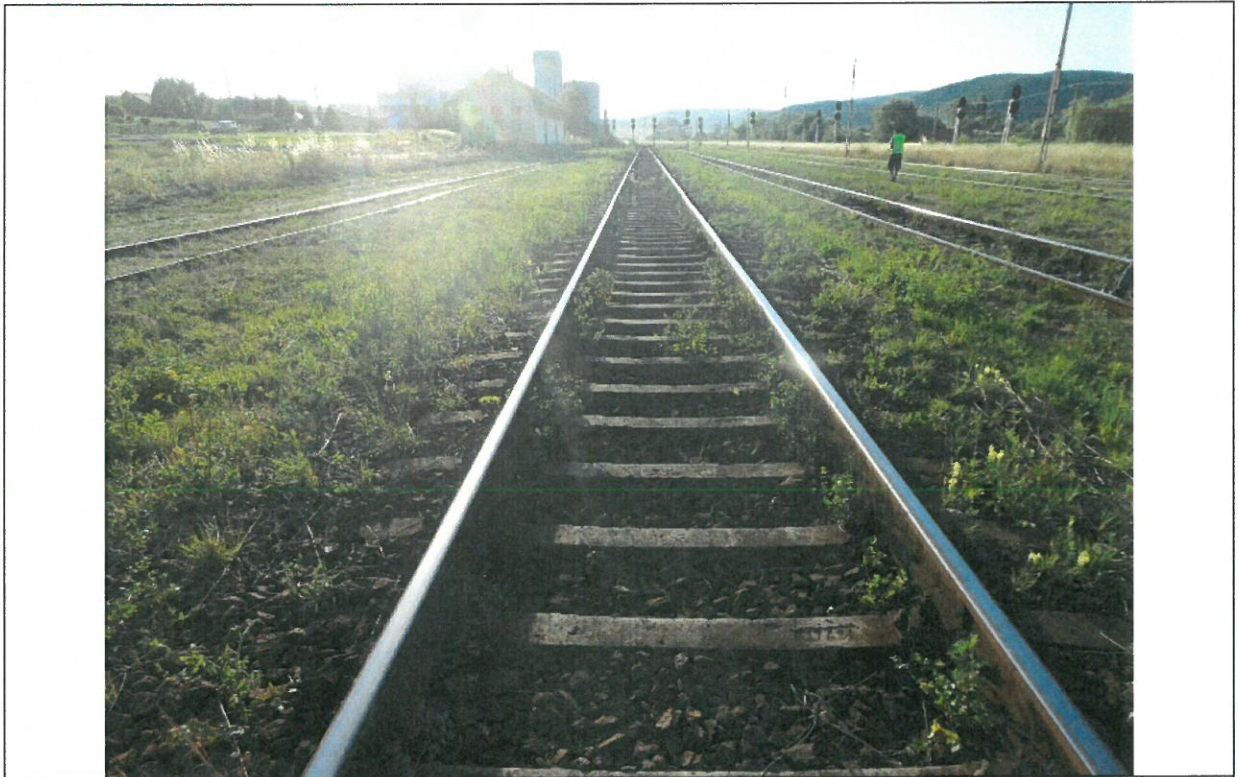
Piatră spartă insuficientă, colmatată cu pământ și vegetație
