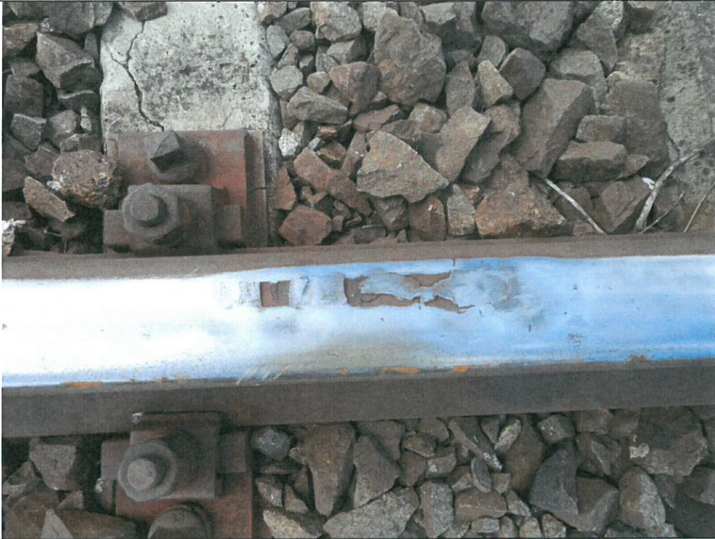
Exfolieri și știrbituri pe suprafața de rulare, din cauza defectelor de fabricație
