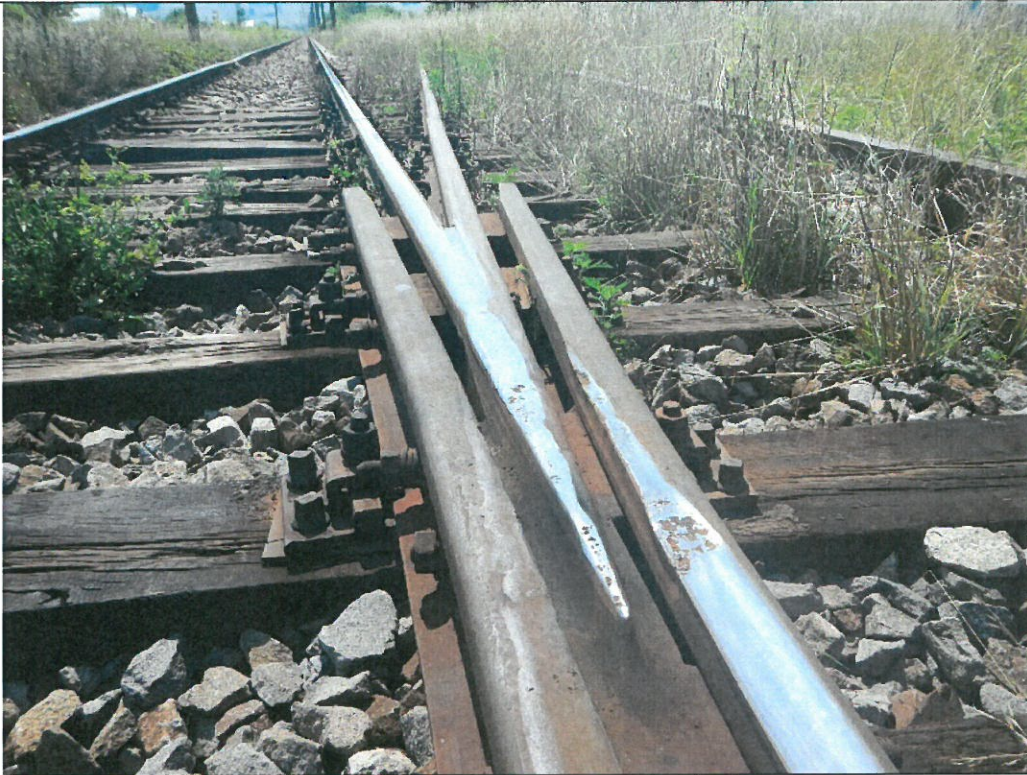
Uzuri ale inimii aparatului de cale
