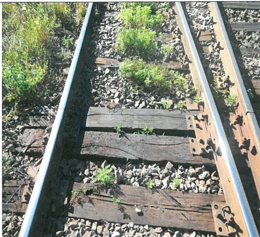
Prindere incorectă a eclisei, lipsă clește și bulon
