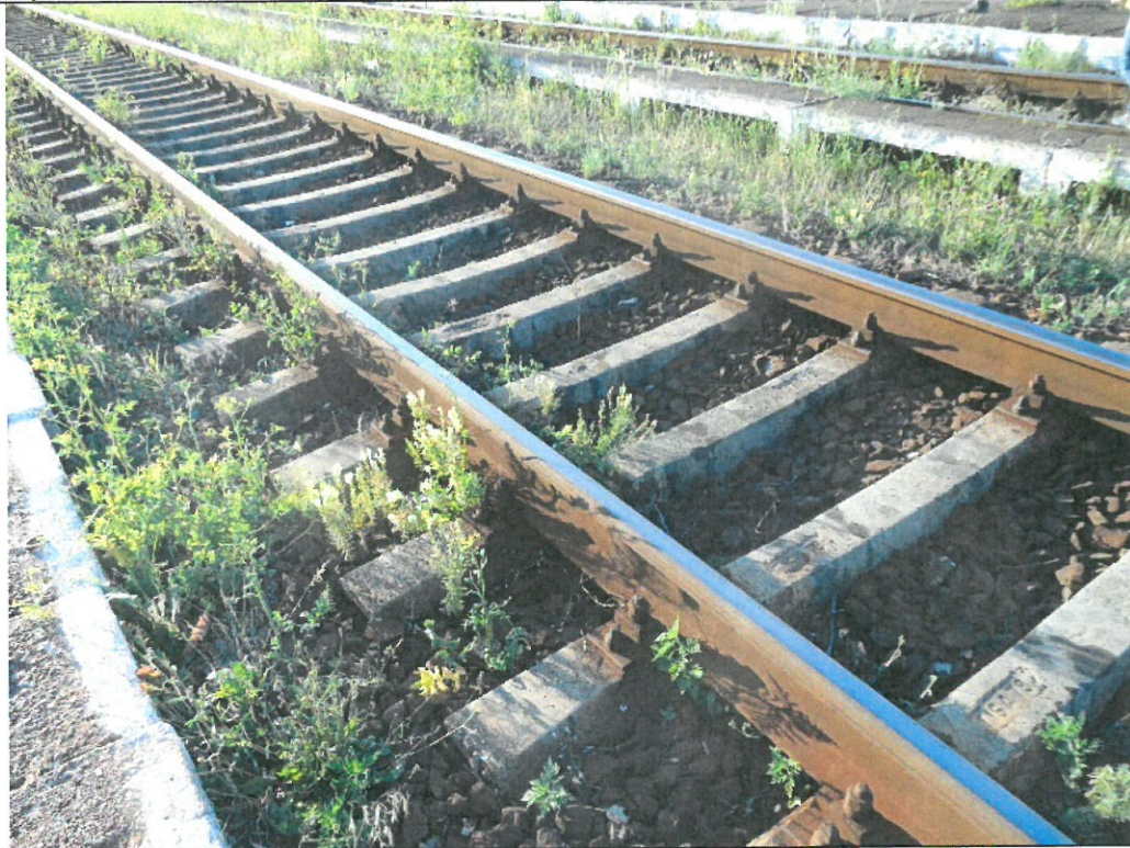
Piatră spartă insuficientă
