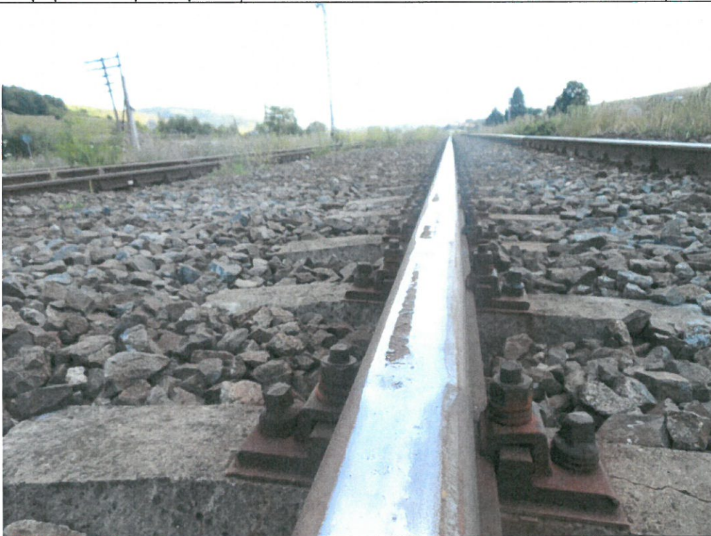
Știrbituri pe muchia de rulare, din cauza rezistenței de contact insuficiente a șinei (oboseala materialului)
