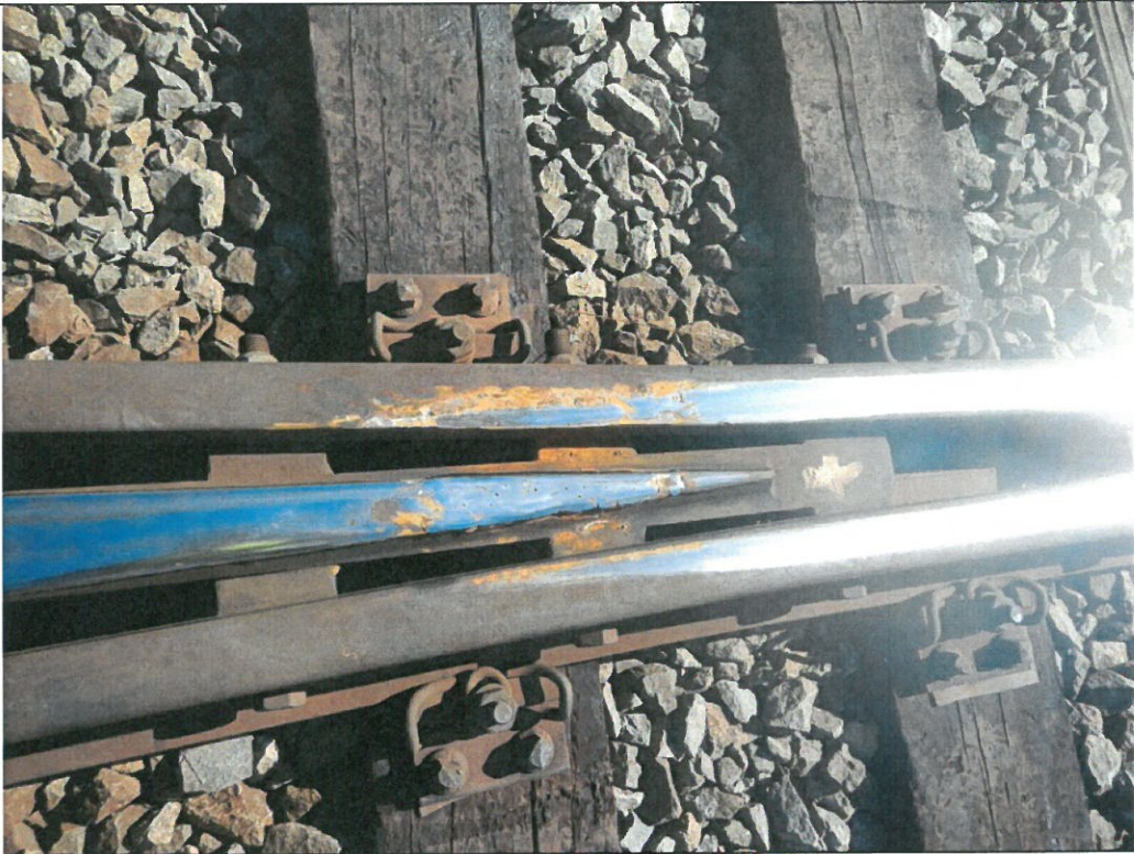
Uzuri ale inimii aparatului de cale
