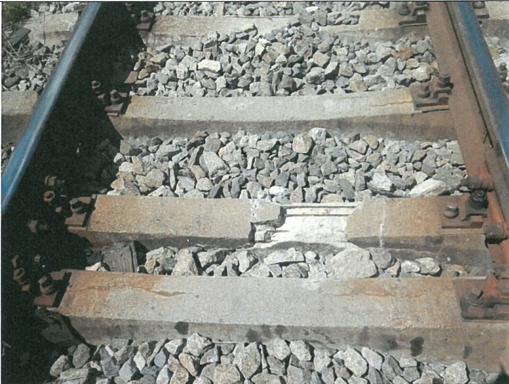
Traversă de beton cu armătura expusă
