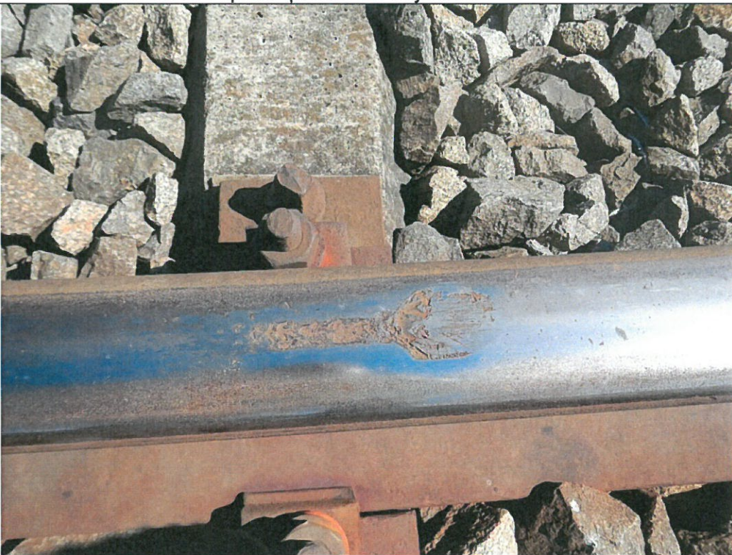
Desprinderi de material
