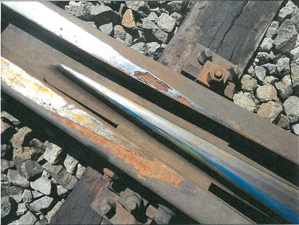
Uzuri ale inimii aparatului de cale
