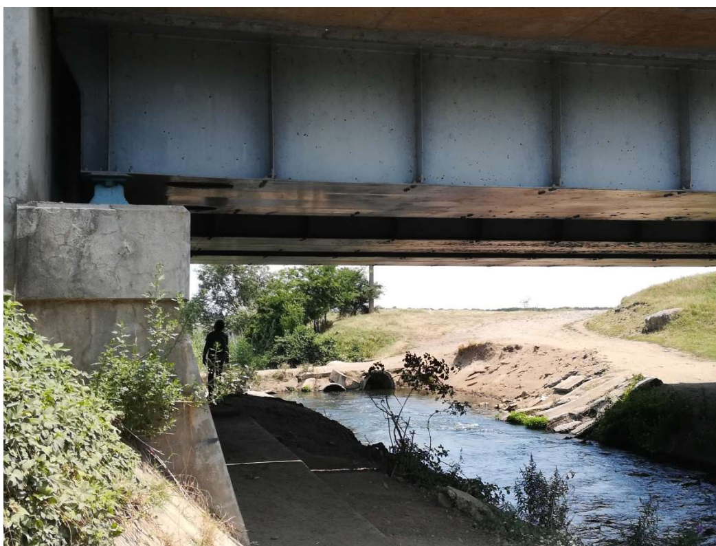
Pod km 12+913 (linia 300)- Deteriorări amenajare/protecție albie
