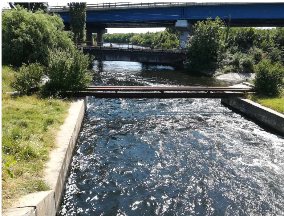
Pod km 2+080 (linia 301K); km 8+672 (linia 700) - Grinzi inimă plină cale sus
