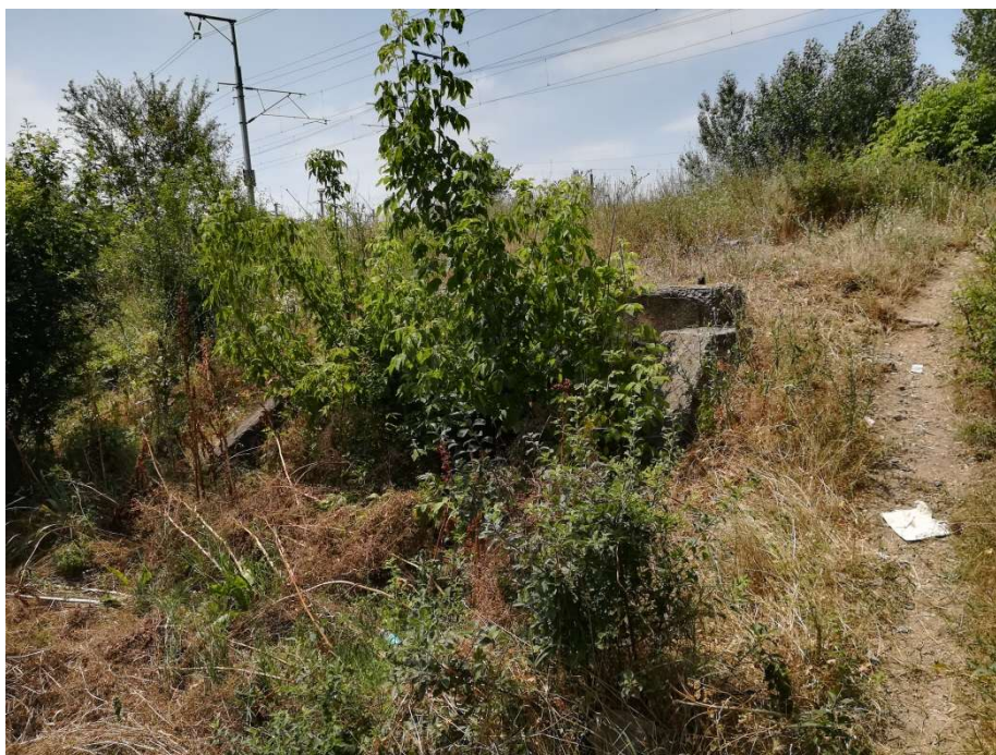
Podet km 11+027 (linia 300) – Albie neamenajată, colmatată
