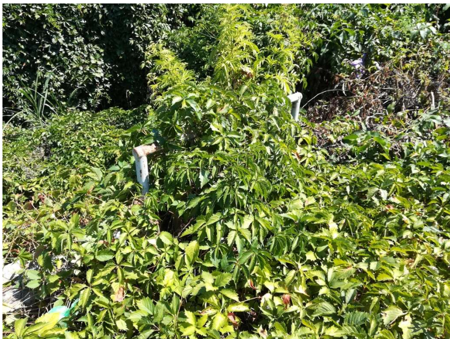
Podet km 4+995 (linia 301Q); km 4+457 (linia 300) – acoperit de vegetație
