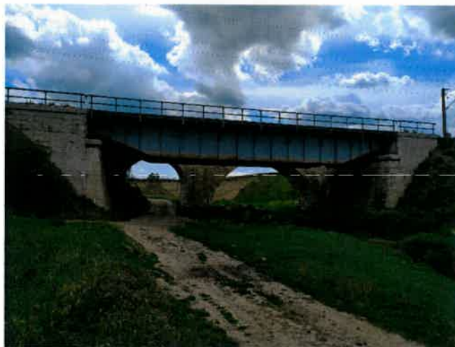
Pod km 185+665 –Grinzi inimă plină cale sus în burtă de pește
