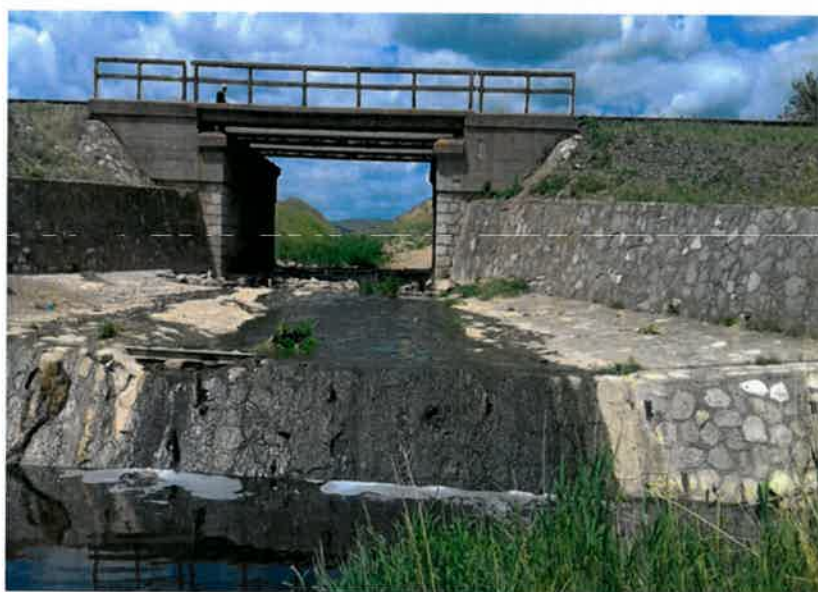
Pod km 88+011– Vedere prag de fund degradat
