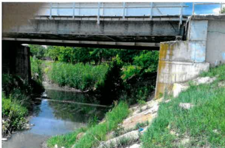
Pod km 94+780 – Pereu degradat
