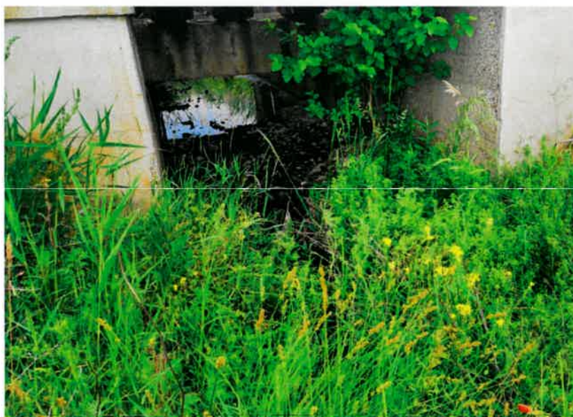
Podet km 105+005 – Podet colmatat cu vegetație, materiale din aluviuni și materiale rezultate din refacția căii
