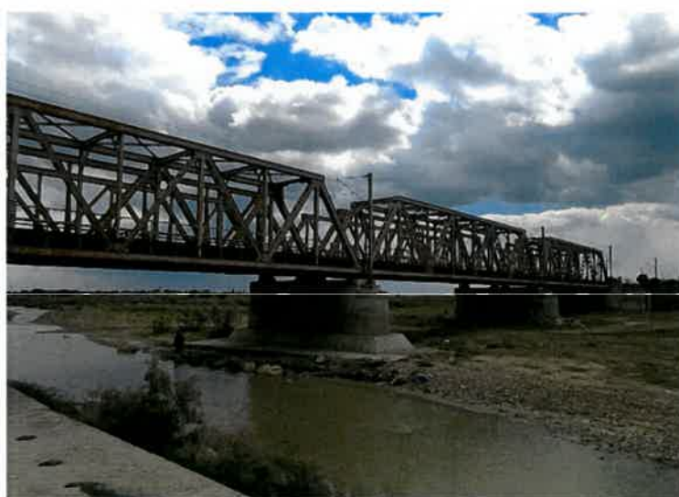
Pod km 159+273- Fenomene de eroziune în albie și expunerea protecției fundației pilei.
