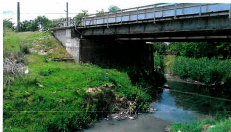
Pod km 94+780 - Grinzi inimă plină cale jos
