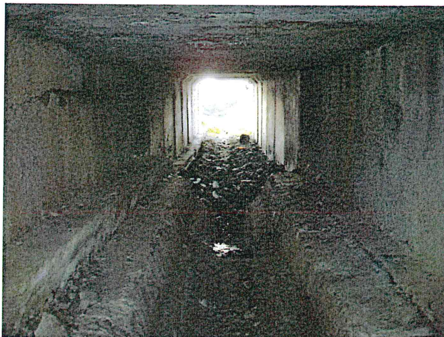
FOTO 2. Vedere interior degradat podeț dalat tronson I
