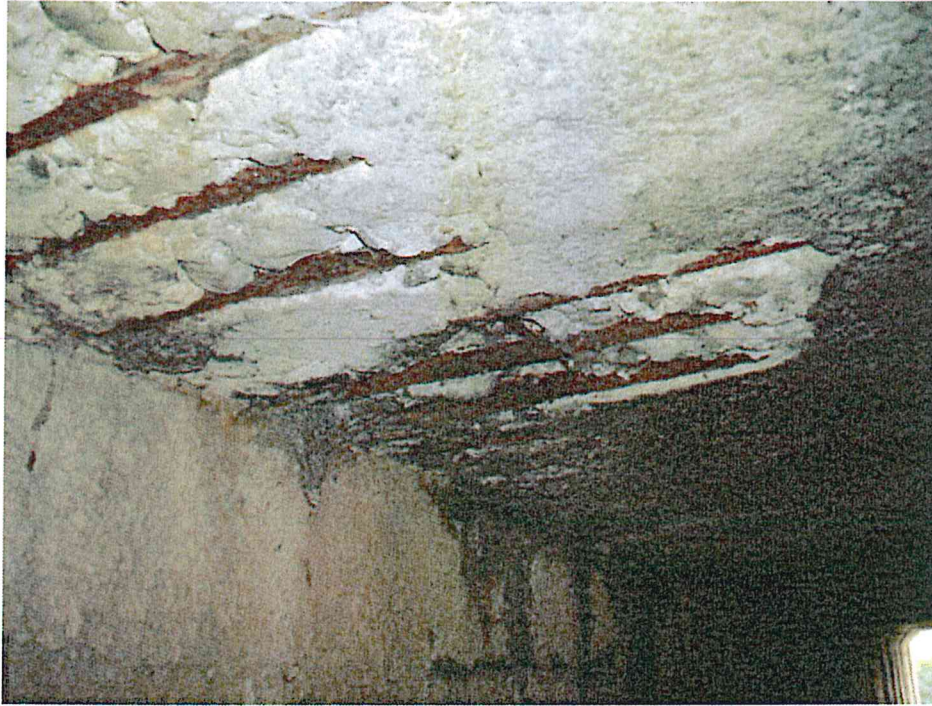
FOTO 3. Intrados podeț dalat tronson I cu degradări majore
