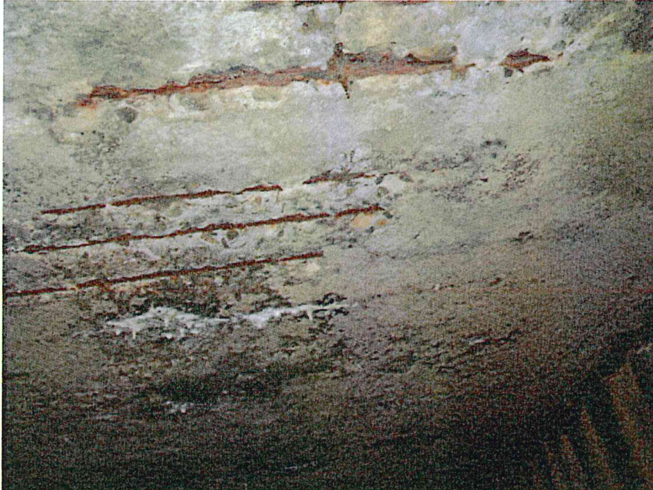
FOTO 4. Armături decopertate, beton degradat, calcifieri pe tronson I
