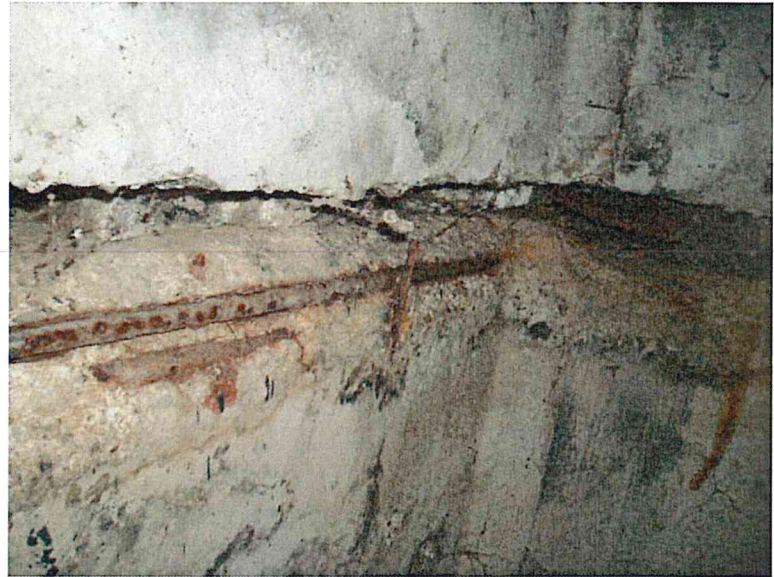
FOTO 4. Armături vizibile la rost
