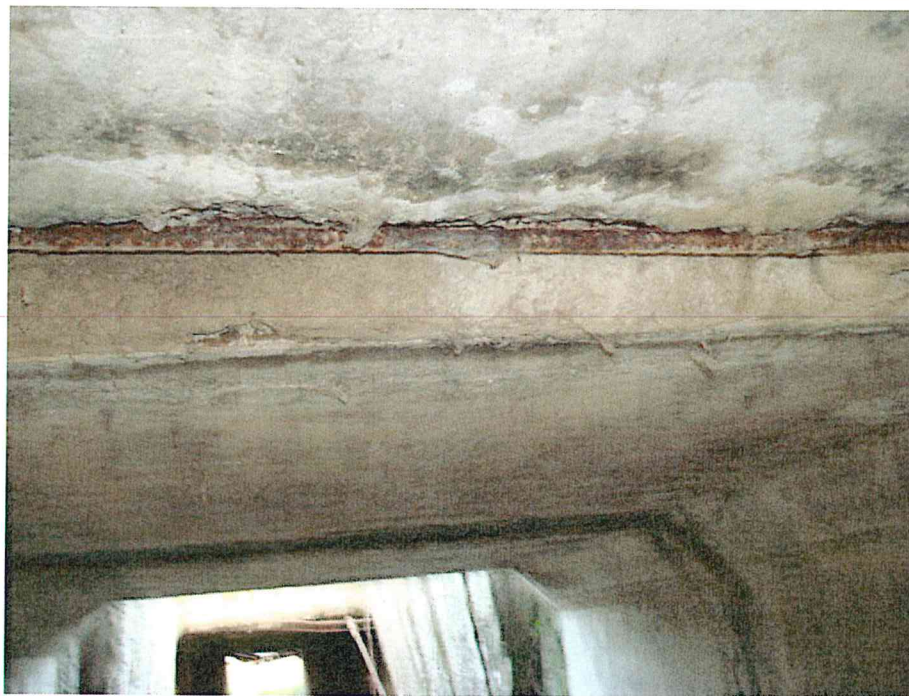
FOTO 8. Armătură la vedere intrados podeț drum
