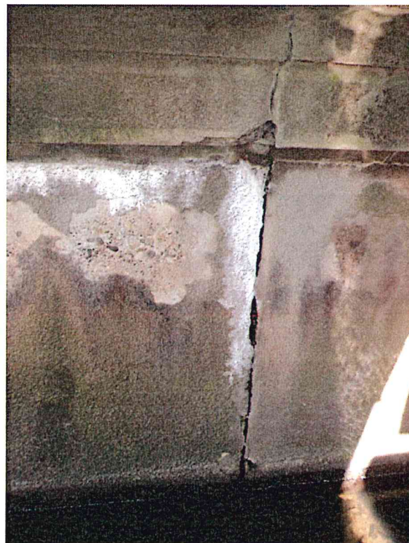
FOTO 5. Defecte ale infrastructurii
