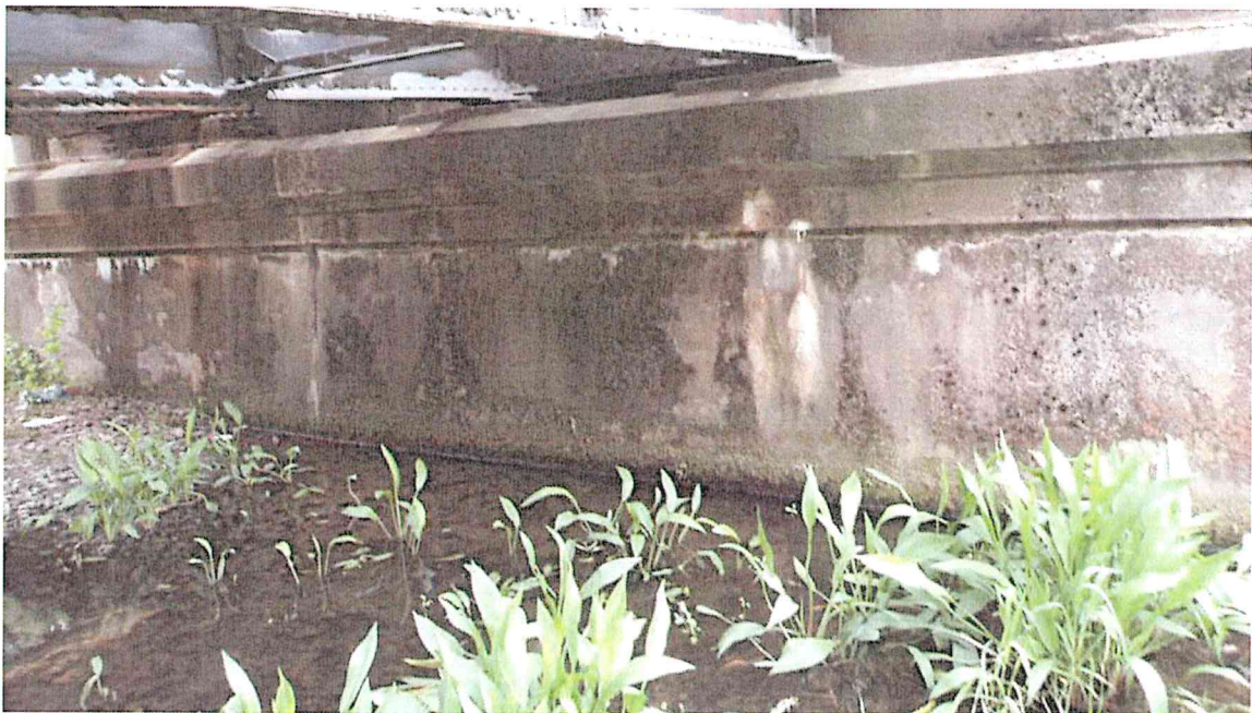
FOTO 7. Defecte ale infrastructurii
