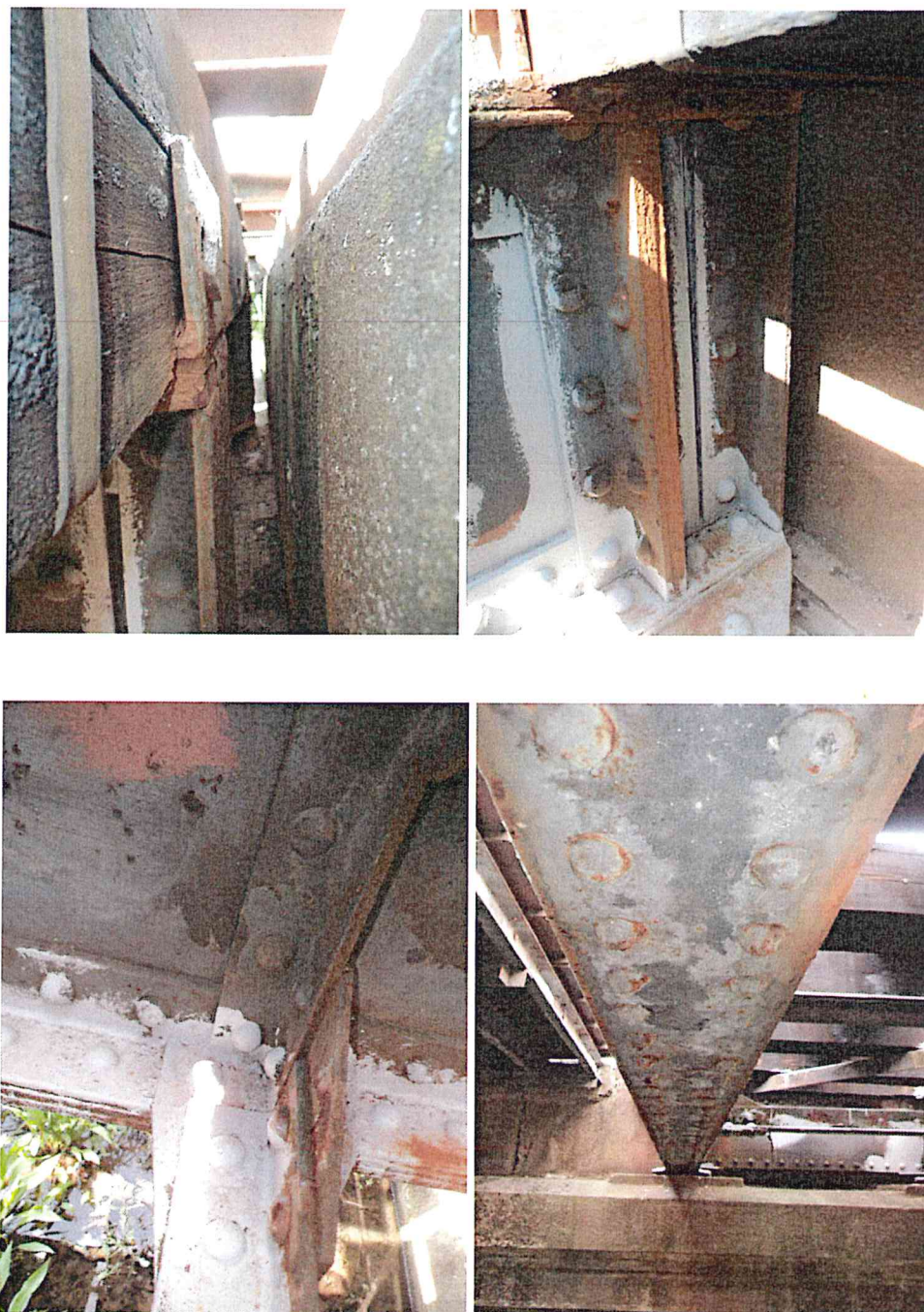
FOTO 3. Defecte ale structurii metalice
