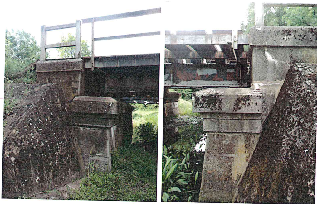
FOTO 8. Defecte ale infrastructurii și racordării cu terasamentul
