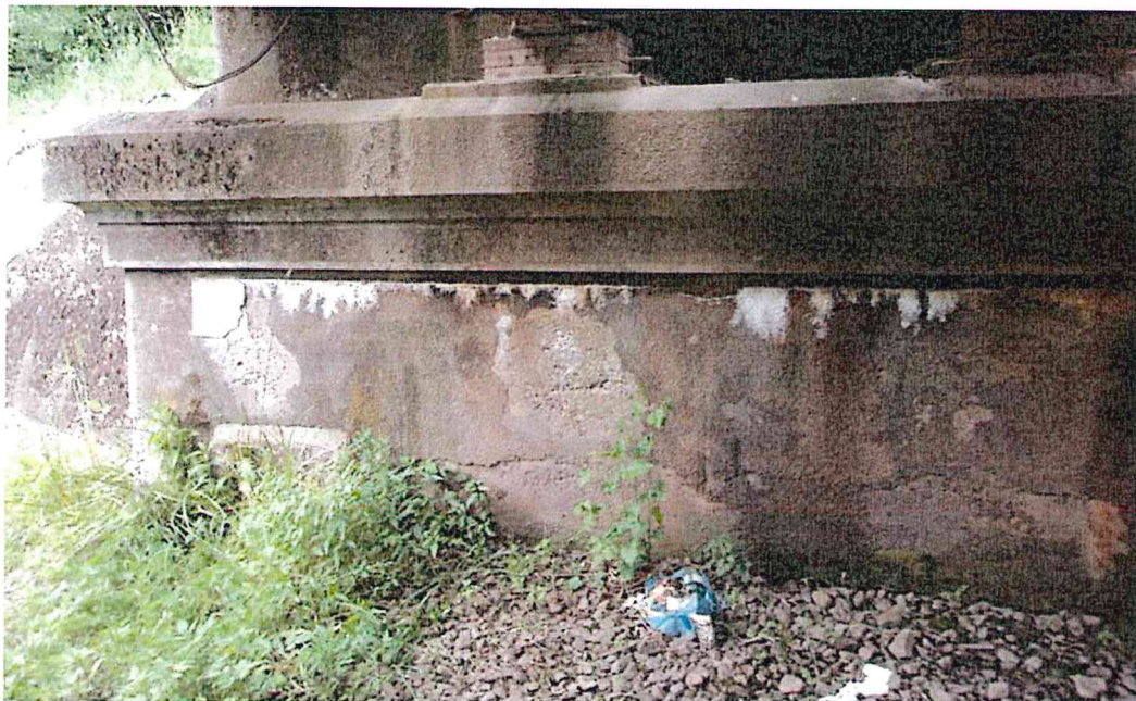
FOTO 6. Defecte ale infrastructurii
