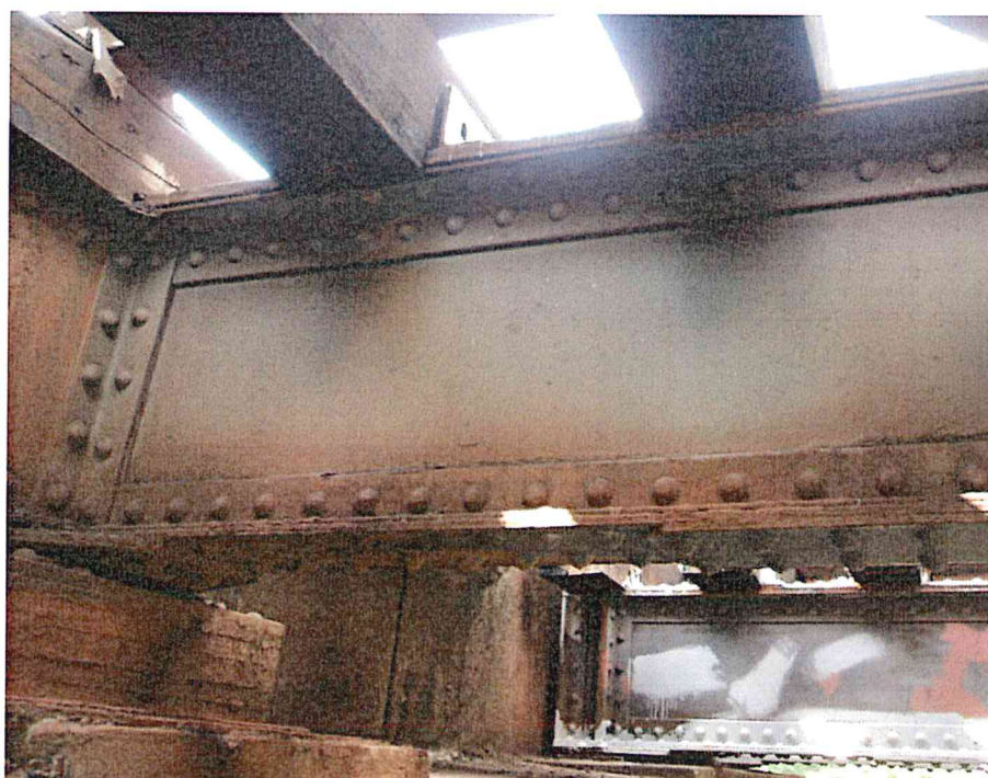
FOTO 4. Defecte ale structurii metalice
