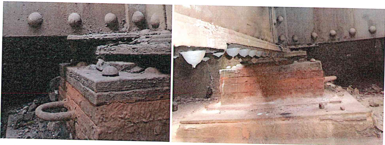
FOTO 9. Defecte ale aparatelor de reazem
