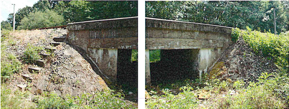
FOTO 4 și 5. Zone cu beton fisurat, infiltrații active, calcifieri la suprastructură și infrastructură
