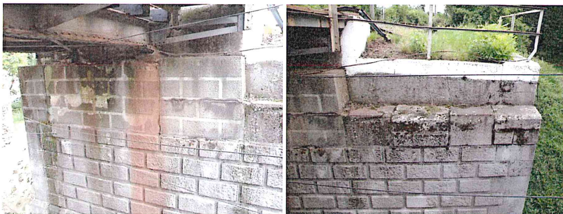
FOTO 11. Defecte ale infrastructurii
