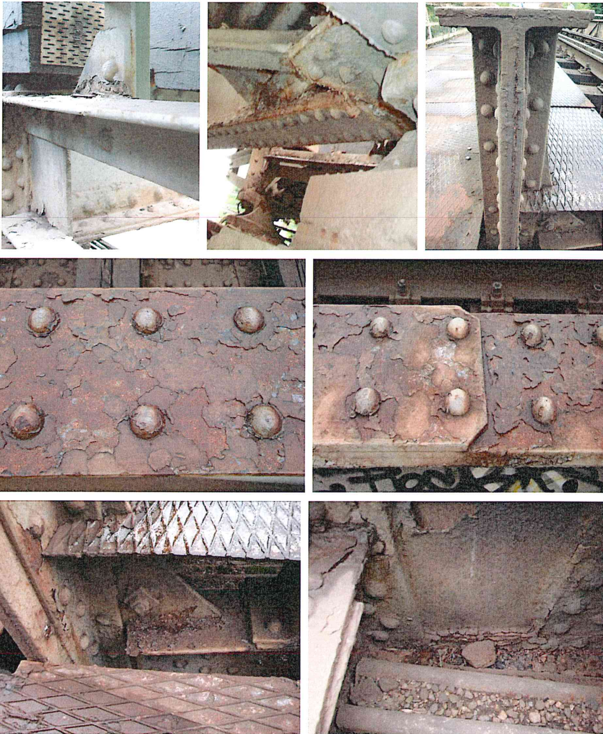
FOTO 6. Defecte ale structurii metalice
