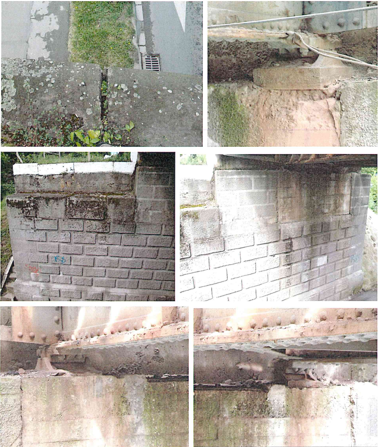
FOTO 12. Defecte ale infrastructurii
