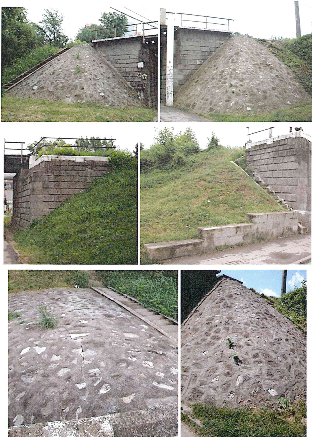
FOTO 15. Vederi ale racordărilor cu terasamentul și defecte constatate
