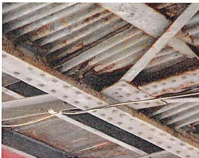
FOTO 10. Defecte ale structurii metalice
