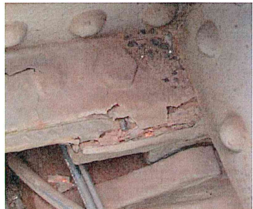
FOTO 4. Defecte ale structurii metalice
