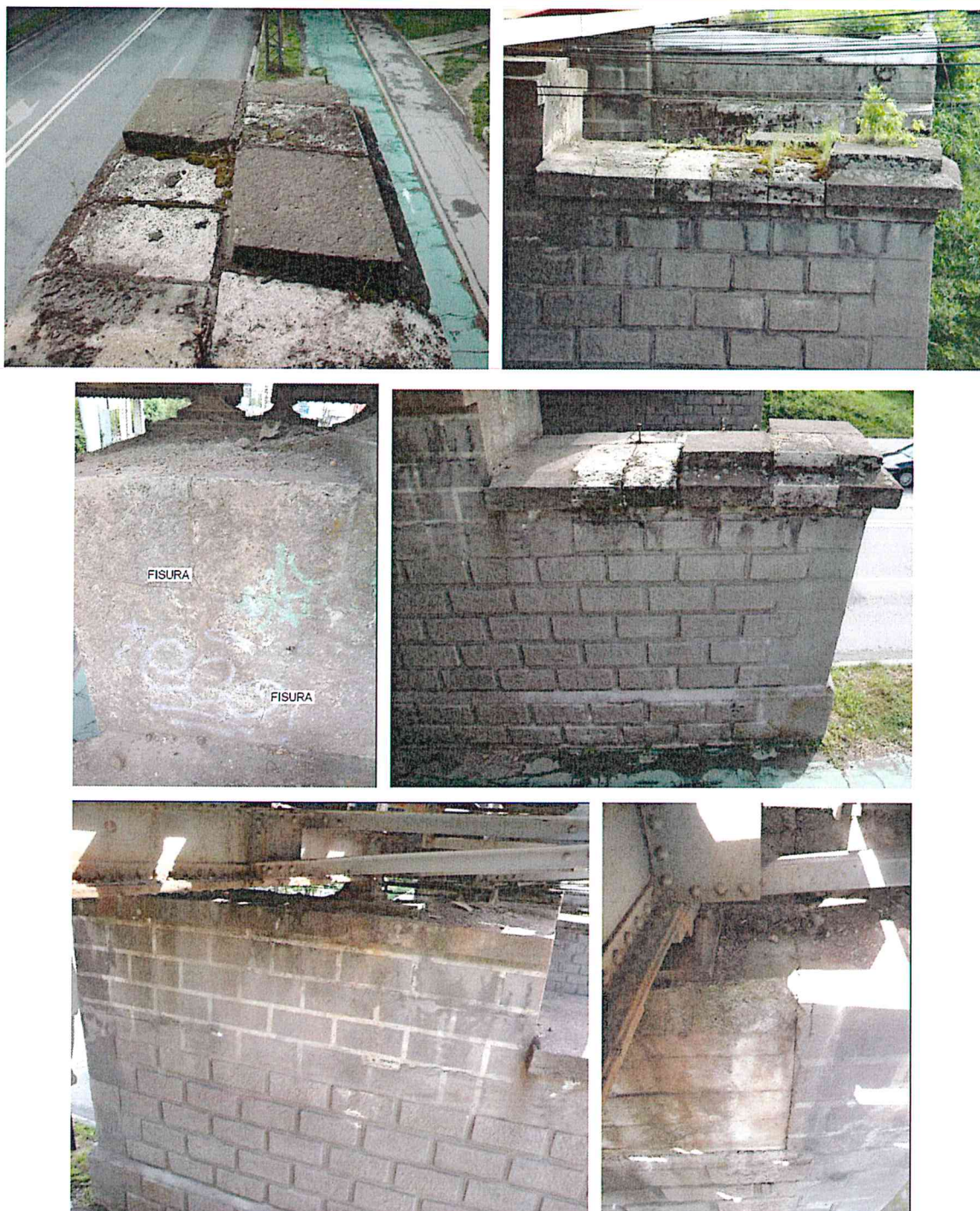
FOTO 13. Defecte ale infrastructurii
