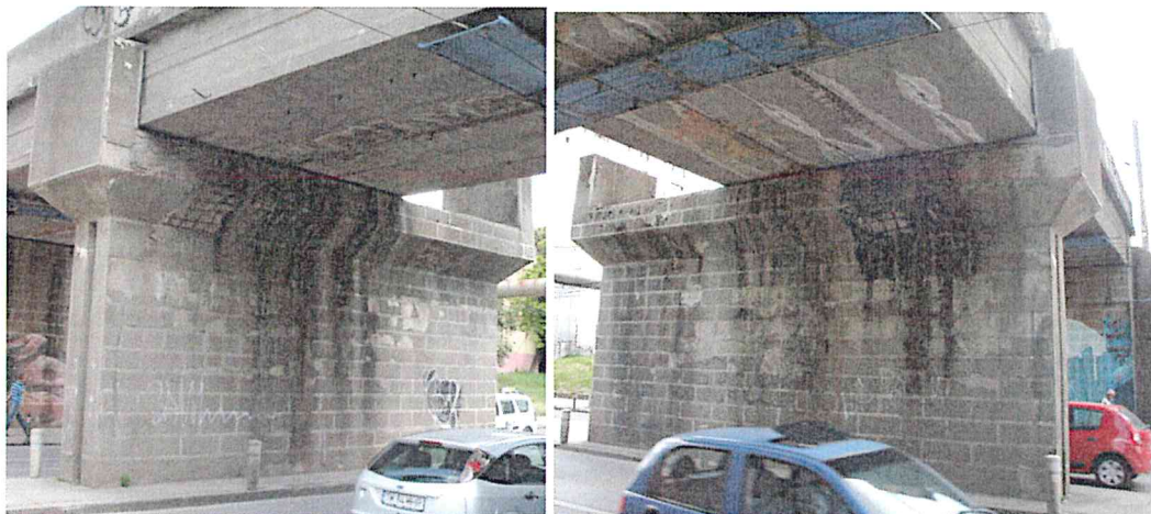
FOTO 8. Defecte ale pilei
