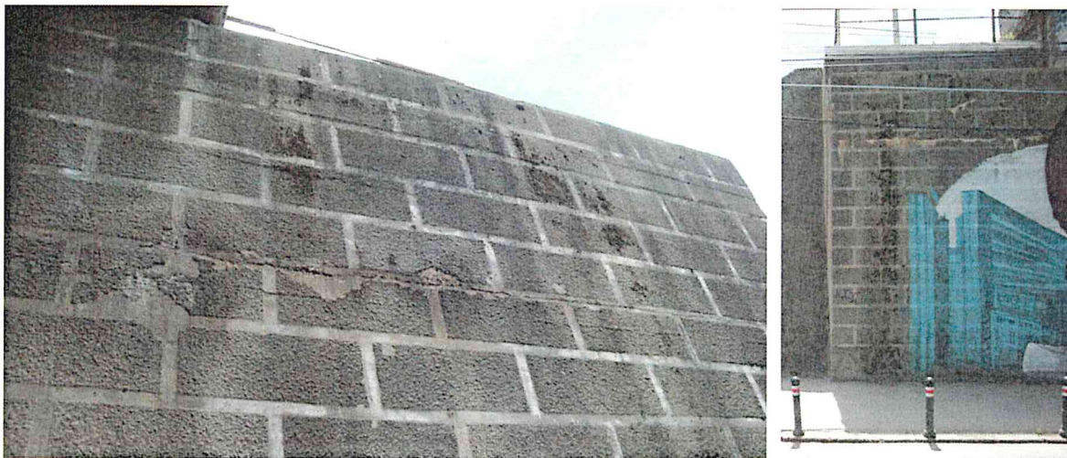
FOTO 7. Defecte ale culeelor
