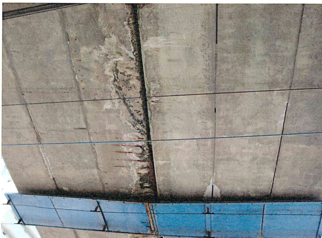
FOTO 4. Infiltrații la suprastructură
