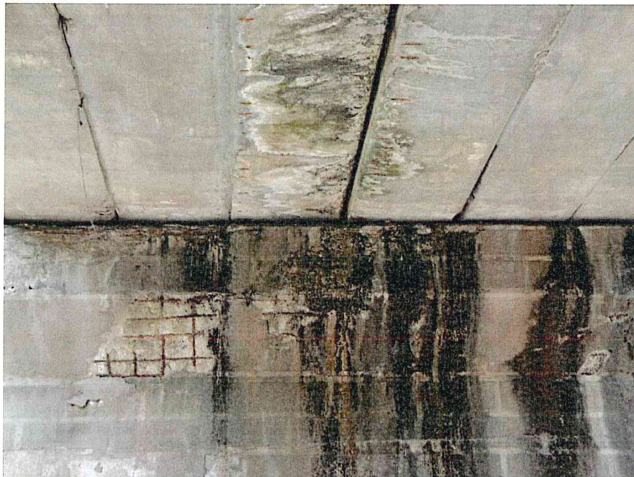
FOTO 6. Infiltrații consistente prin rostul de pe pilă, dintre structuri
