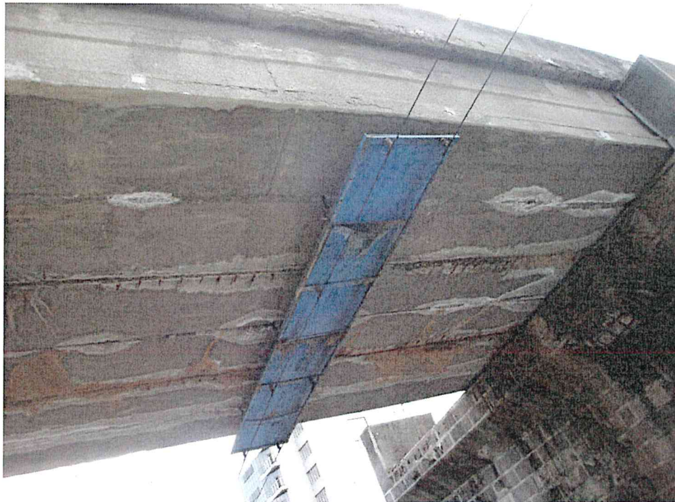
FOTO 5. Infiltrații la suprastructură
