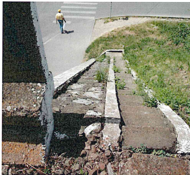
FOTO 10. Defecte ale scărilor de acces pe terasament
