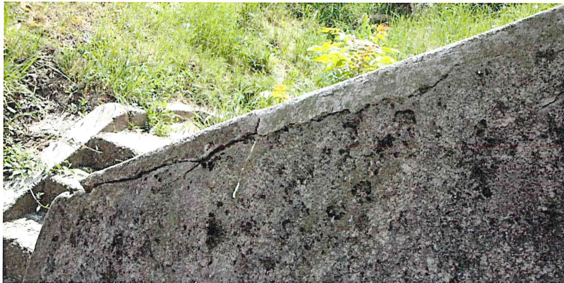
FOTO 9. Racordările cu terasamentul și defecte ale acestora
