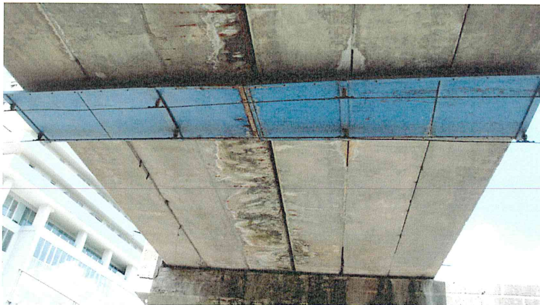
FOTO 3. Suprastructură din 6 fâșii cu goluri. Infiltrații între fâșii
