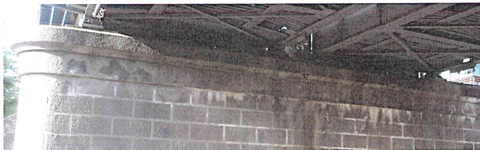
FOTO 12. Defecte ale infrastructurilor
