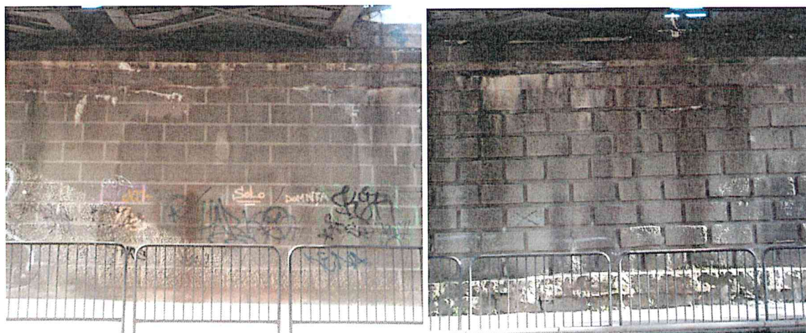
FOTO 11. Defecte ale infrastructurilor
