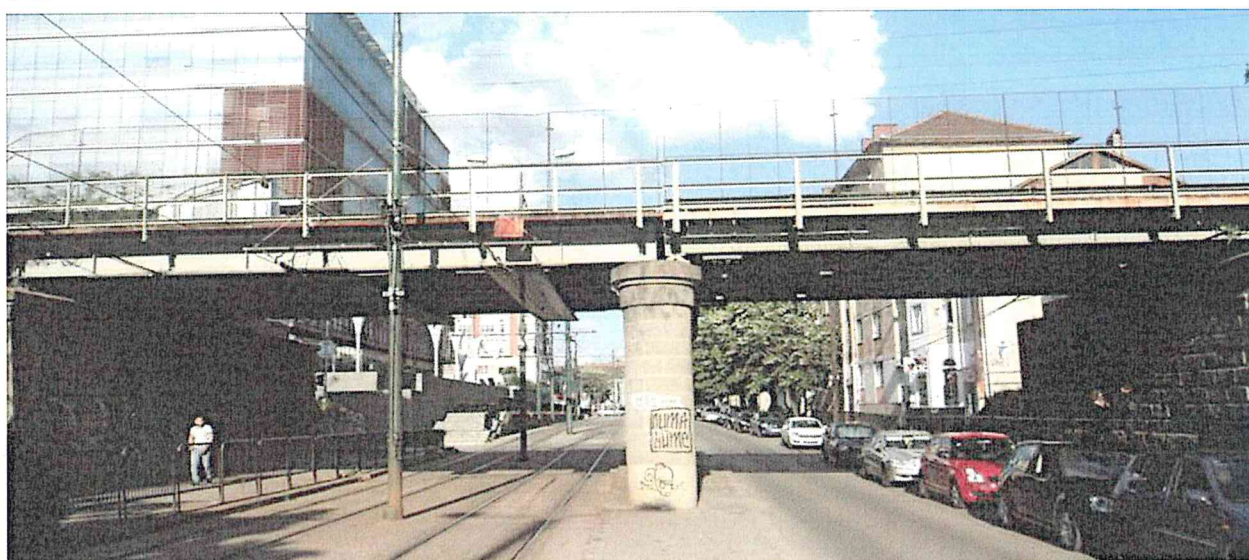
FOTO 10. Defecte ale structurii metalice
