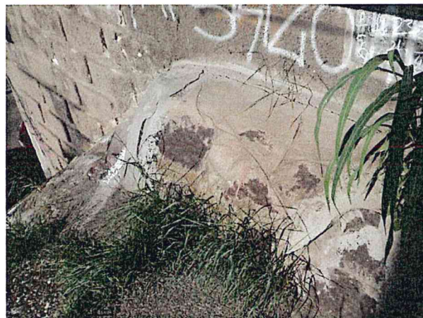
FOTO 13. Racordările cu terasamentul. Degradări minore
