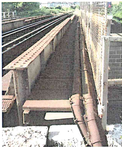
FOTO 4. Rețele de cabluri pe zona podului
