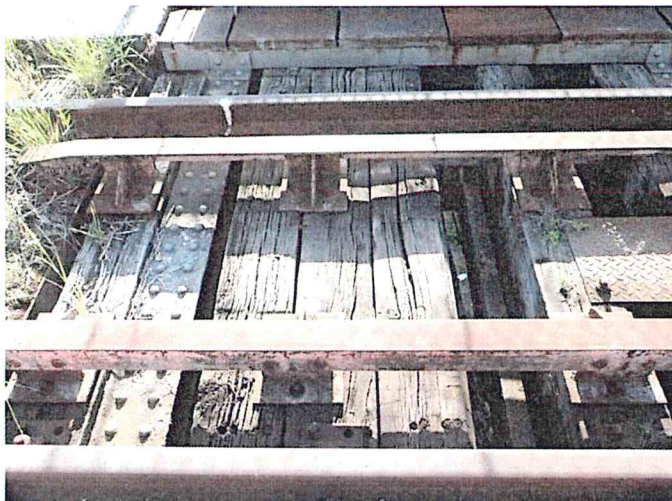
FOTO 3. Defecte ale căii pe pod
