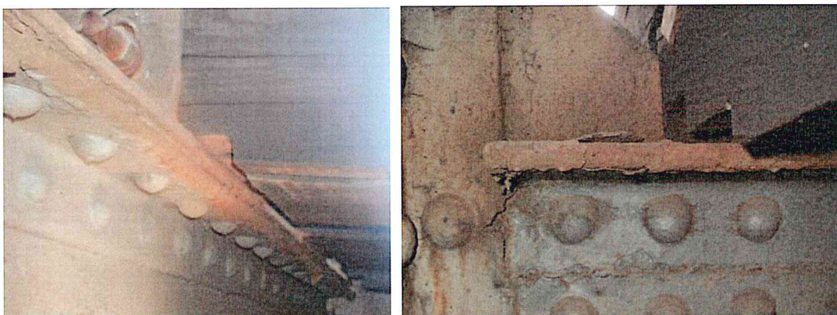
FOTO 7. Defecte ale structurii metalice (zone afectate de coroziune)
