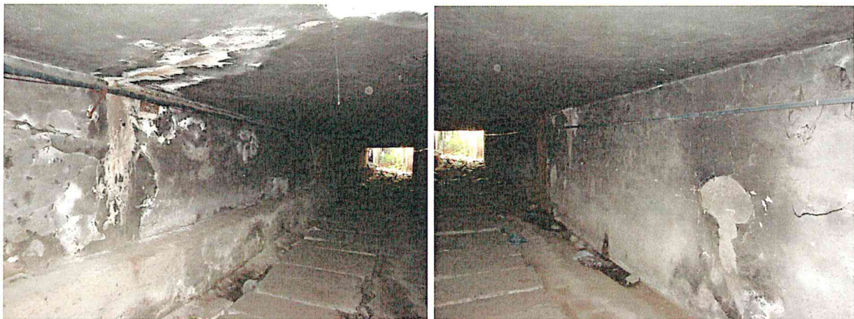
FOTO 6 și 7. Infiltrații, calcifieri, tencuială căzută interior podeț
