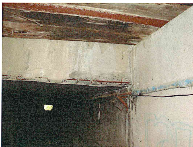
FOTO 9. Degradări dală podeţ
