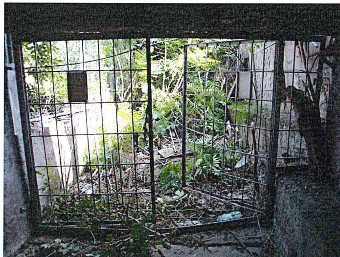
FOTO 3. Ieșire dezafectată podeț cf
