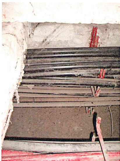
FOTO 11. Cabluri interior podeţ
