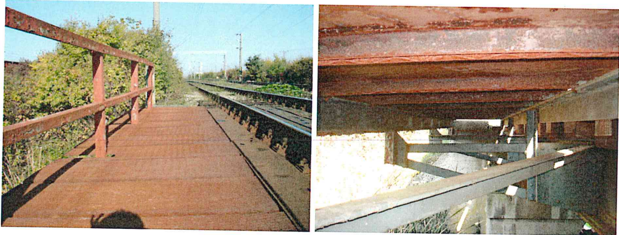
FOTO 8. Elemente de trotuar cu zone corodate
