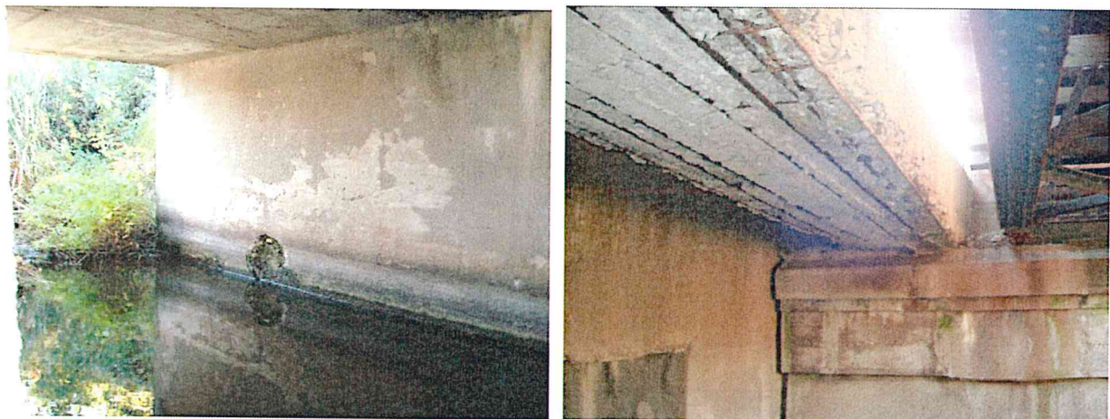
FOTO 2. Degradări ale structurii podeţului dalat
