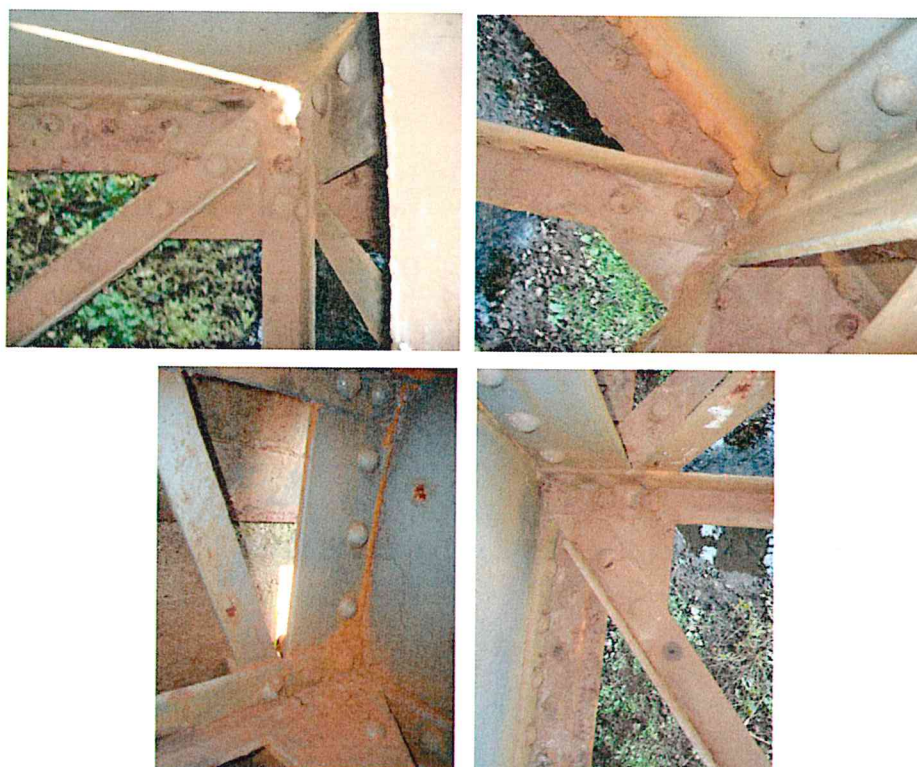
FOTO 7. Zone corodate la elementele contravânturilor
