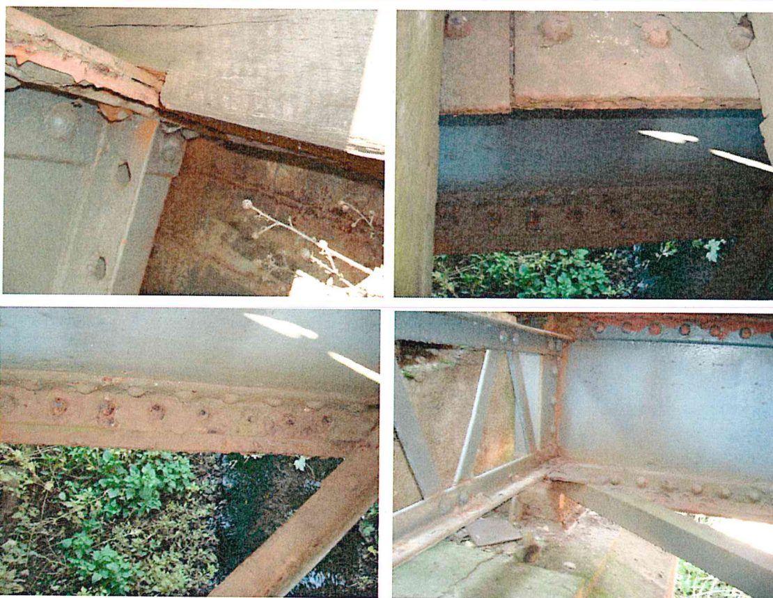
FOTO 6. Zone corodate la elementele grinzilor principale
