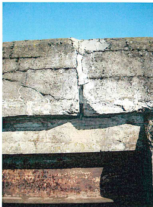
FOTO 5. Dală și timpan degradate
