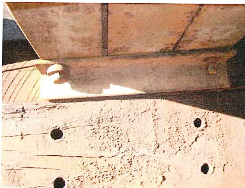
FOTO 4. Material metalic corodat
