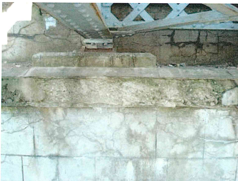
FOTO 6. Banchetă cuzineți cu beton degradat și infiltrații
