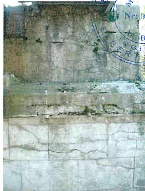
FOTO 3. Banchetă cuzineții degradată
