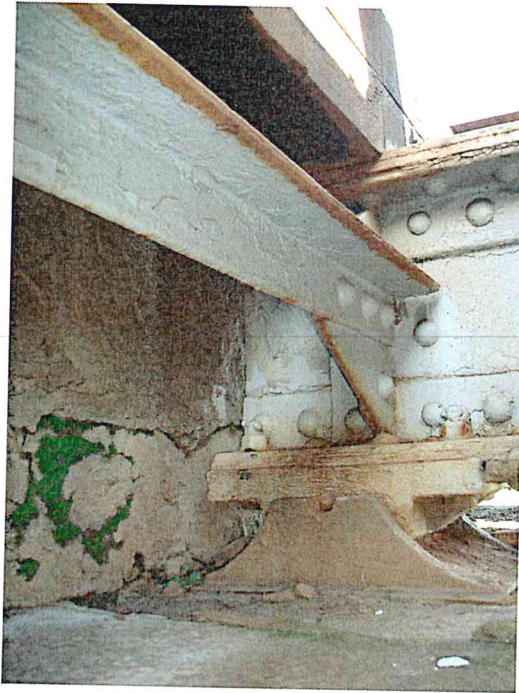
FOTO 10. Aparat reazem degradat
