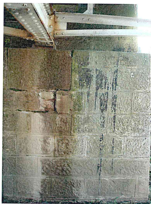
FOTO 6. Infiltrații la culee
