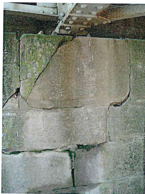
FOTO 5. Banchetă cuzineți degradată
