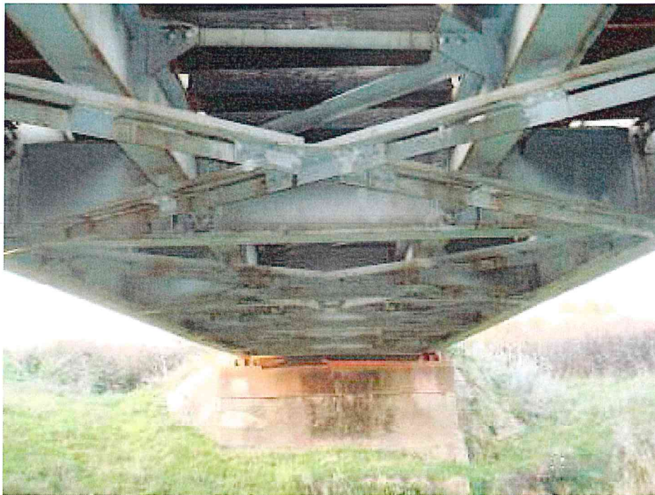
FOTO 3. Vedere contravântuire inferioară pod
