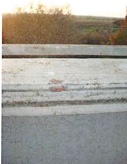
FOTO 6. Talpă grindă corodată
