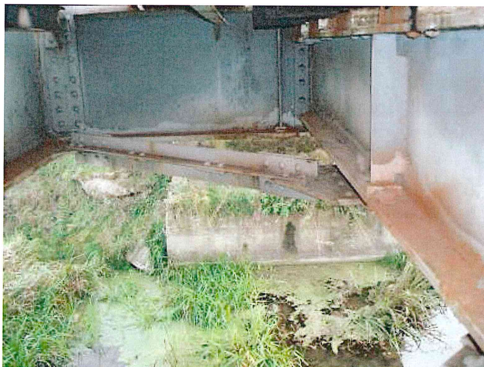
FOTO 7. Vedere suduri degradate
