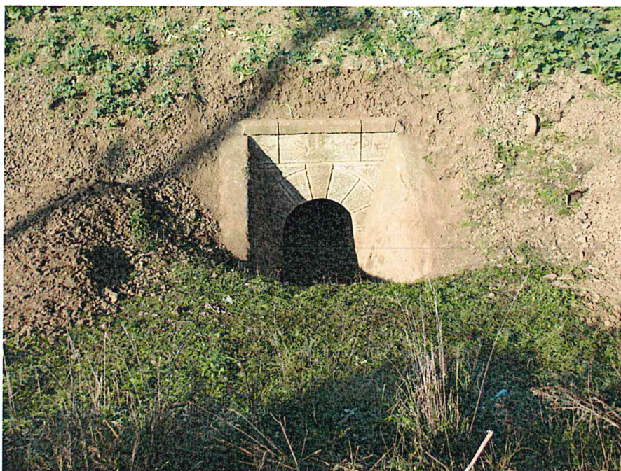
FOTO 1. Vedere dreapta podeț boltit
