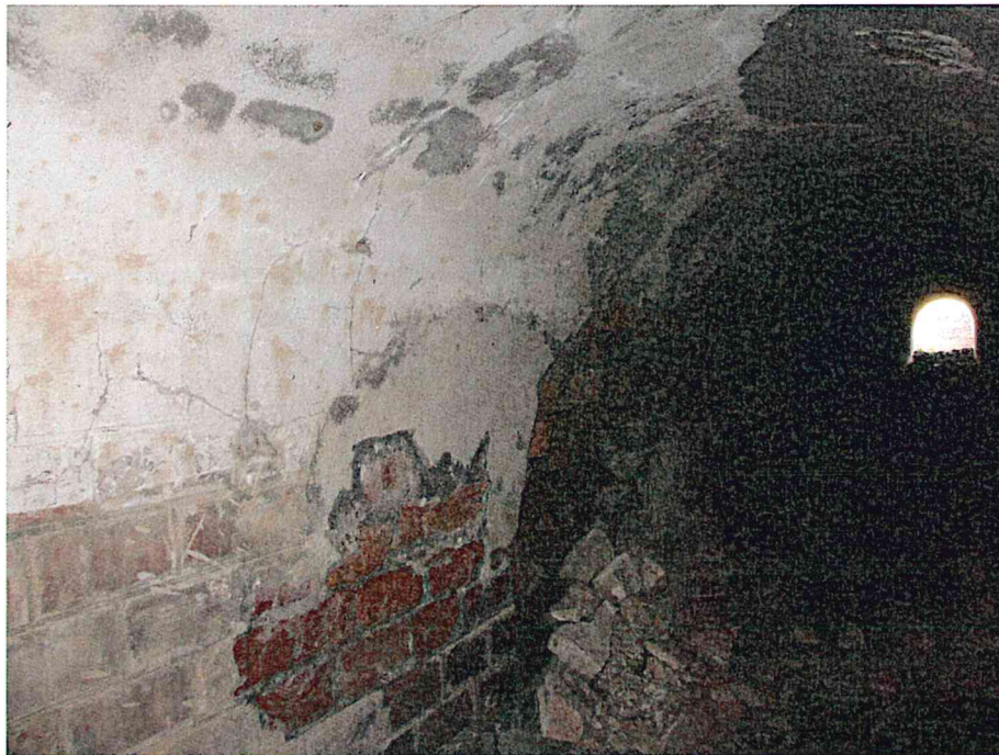
FOTO 4. Boltă cărămidă degradată cu prăbușiri locale
