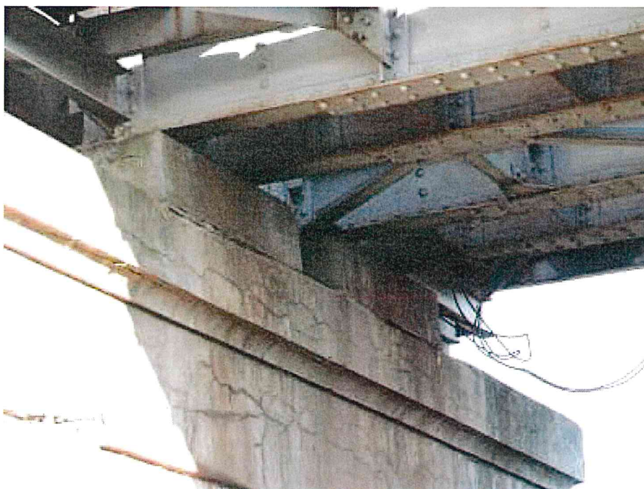
FOTO 6. Banchetă cuzineți cu beton fisurat și infiltrații
