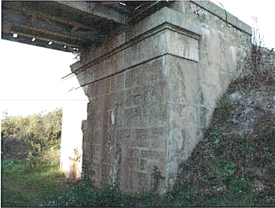
FOTO 3. Culee cu infiltrații și calcifieri
