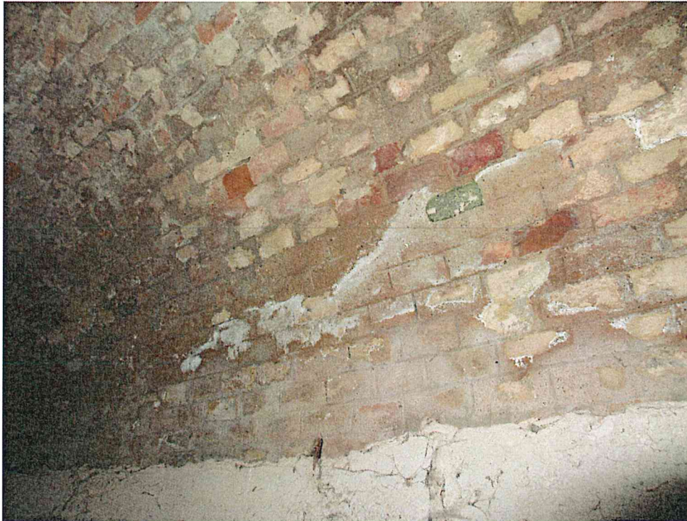
FOTO 3. Boltă cărămidă cu infiltrații și calcifieri
