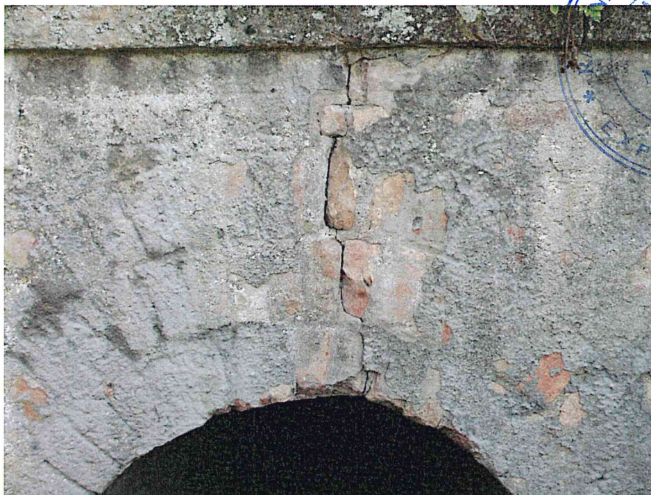
FOTO 6. Timpan aval fisurat
