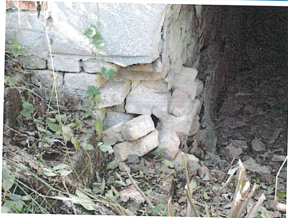
FOTO 5. Prabușire cărămizi din boltă pe partea dreaptă podeț
