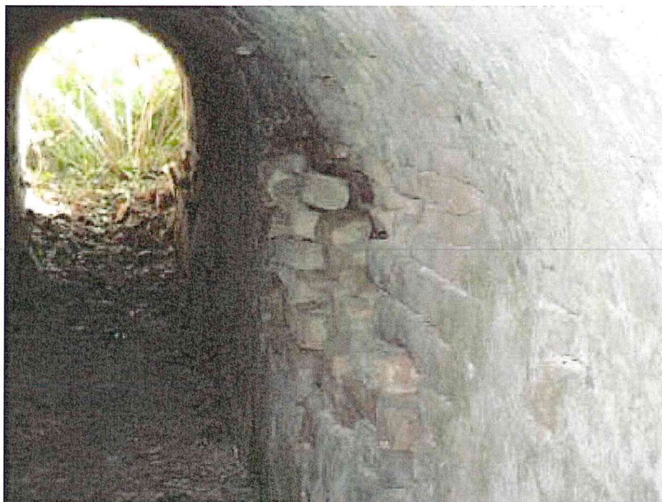
FOTO 3. Prabușiri locale boltă cărămidă
