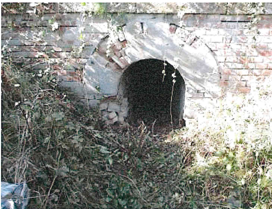
FOTO 4. Vedere dreapta podeț cu timpan degradat
