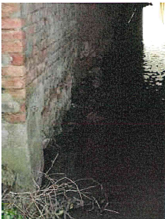
FOTO 6. Zidărie cărămidă deteriorată
