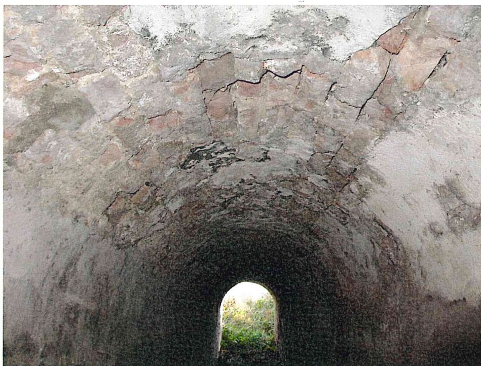
FOTO 4. Intrados degradat boltă
