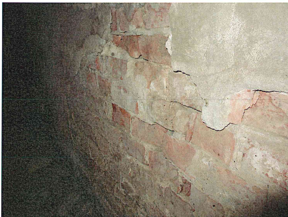
FOTO 3. Pereți laterali boltă degradați
