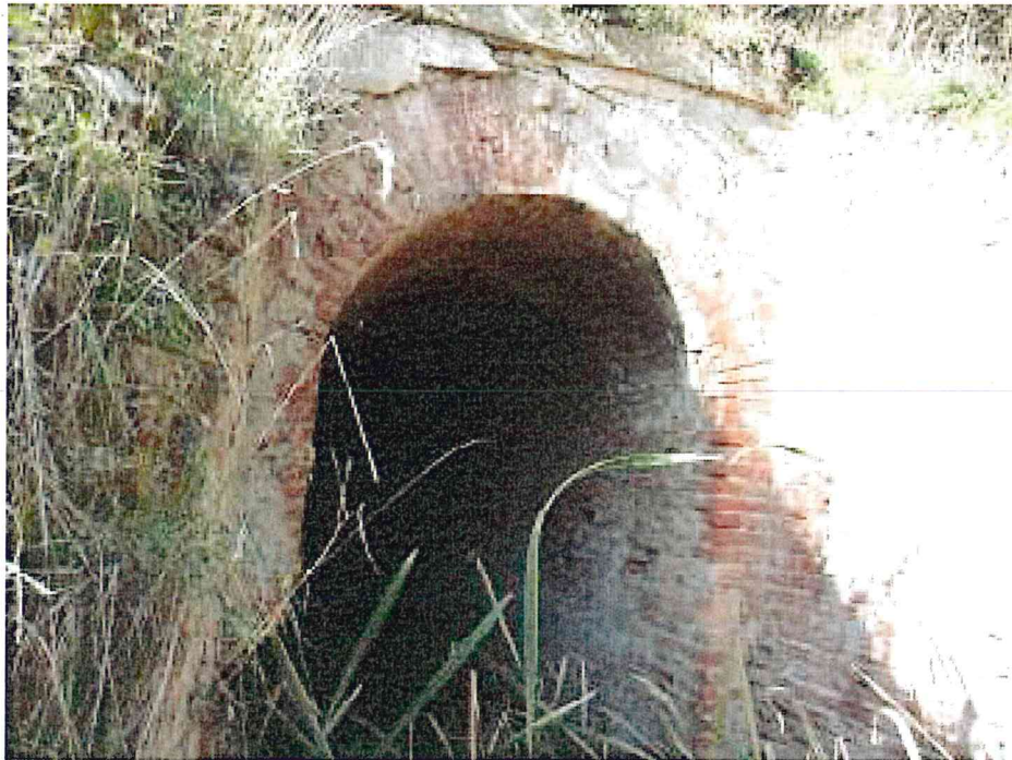
FOTO 3. Tencuială căzută ieşire boltă
