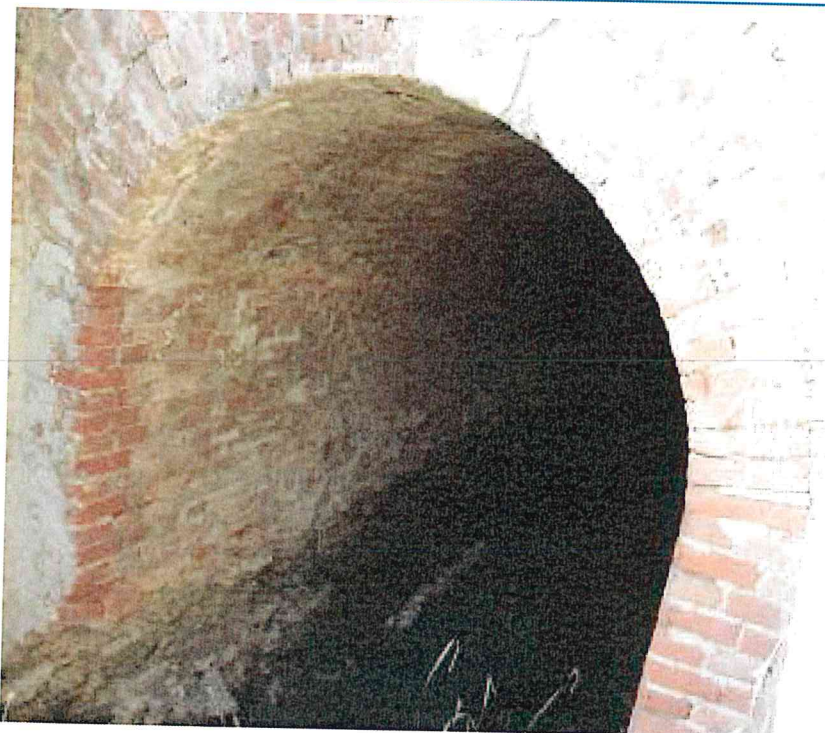
FOTO 5. Degradări majore zonă inferioară boltă
