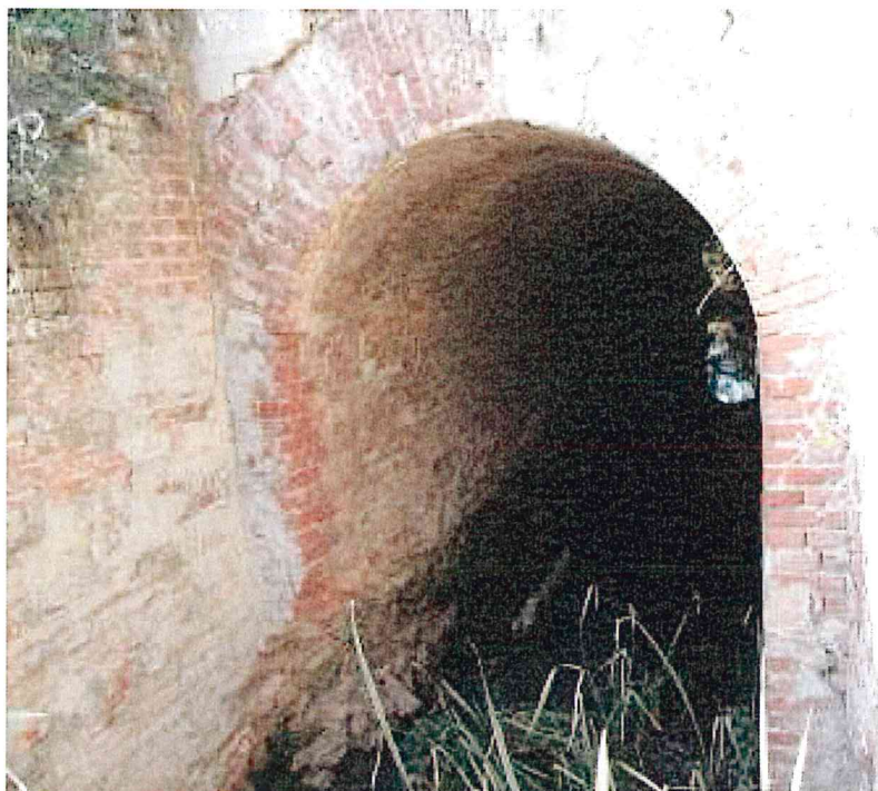
FOTO 4. Degradări boltă și ziduri cărămidă
