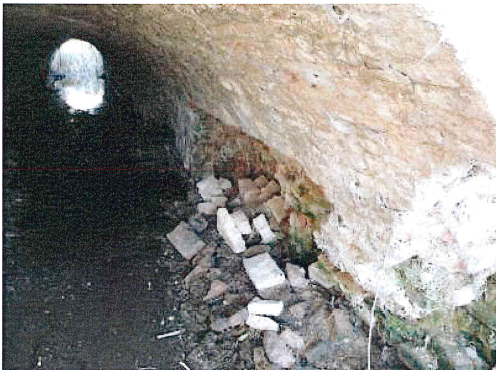
FOTO 4. Prăbuşire cărămidă partea dreapta
