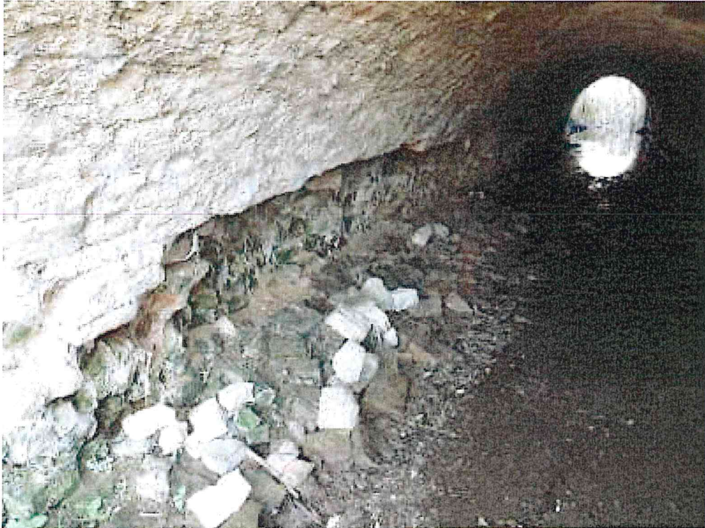
FOTO 3. Prăbuşire cărămidă partea stângă
