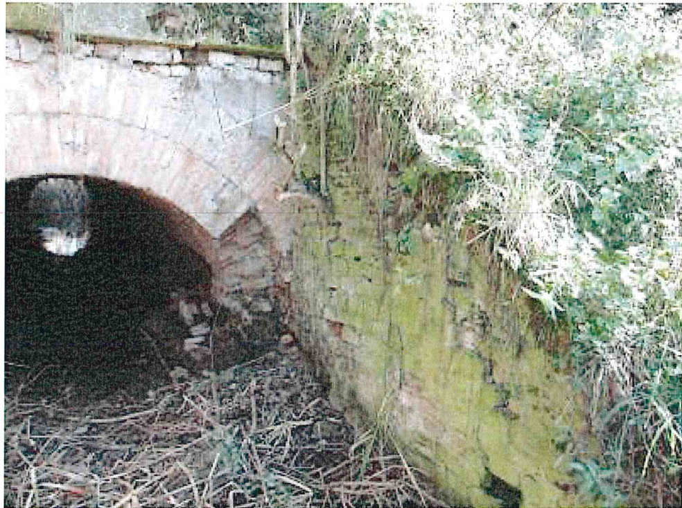
FOTO 5. Prăbușire boltă ieșire dreapta
