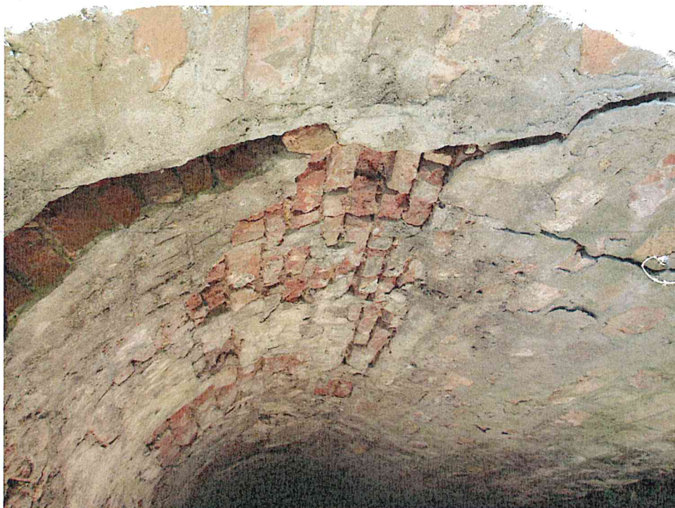
FOTO 5. Degradari intrados bolta
