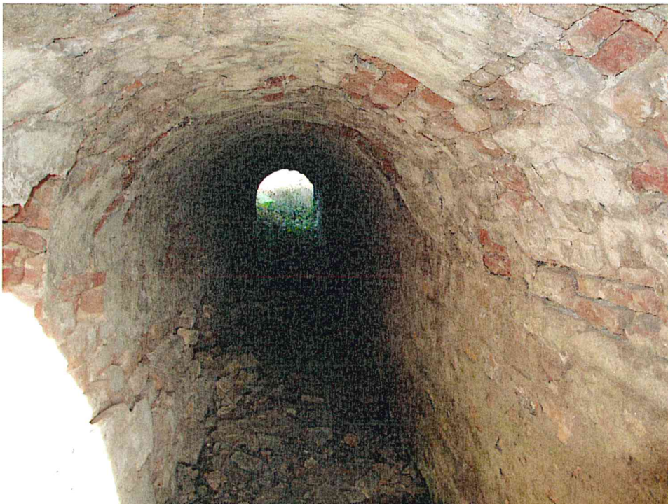
FOTO 4. Degradari bolta si pereu
