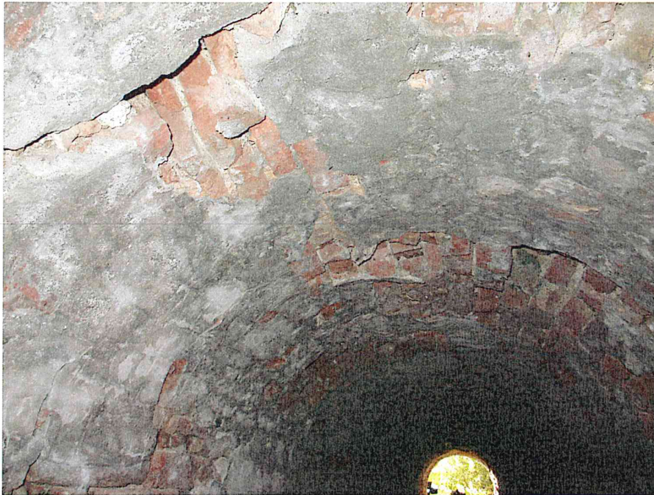
FOTO 3. Tencuiala cazuta bolta, dislocari, infiltratii
