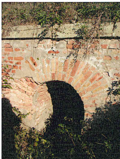
FOTO 6. Vedere stanga podet boltit
