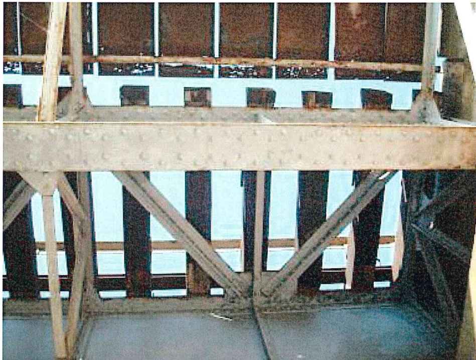
FOTO 12. Consolă trotuar degradată
