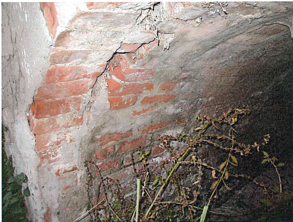
FOTO 2. Timpan dreapta fisurat
