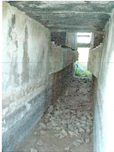
FOTO 5. Degradări beton infrastructură
