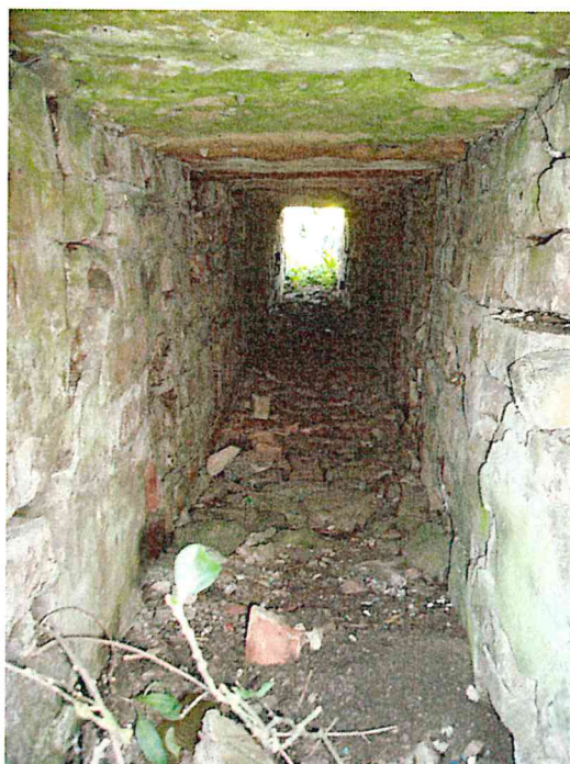
FOTO 2. Interior degradat podeț
