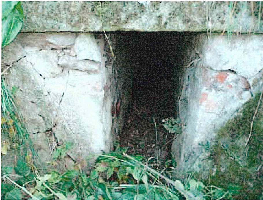
FOTO 5. Pereți degradați podeț dalat
