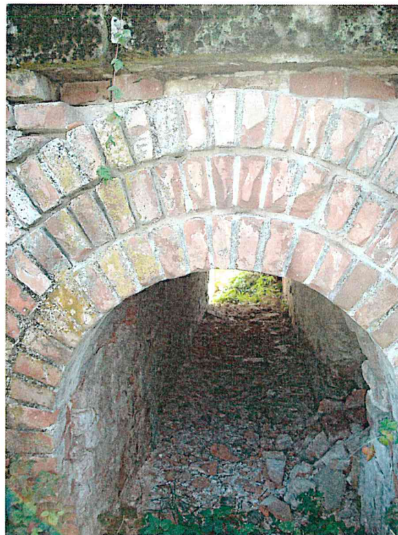
FOTO 2. Boltă prăbușită pe partea dreaptă
