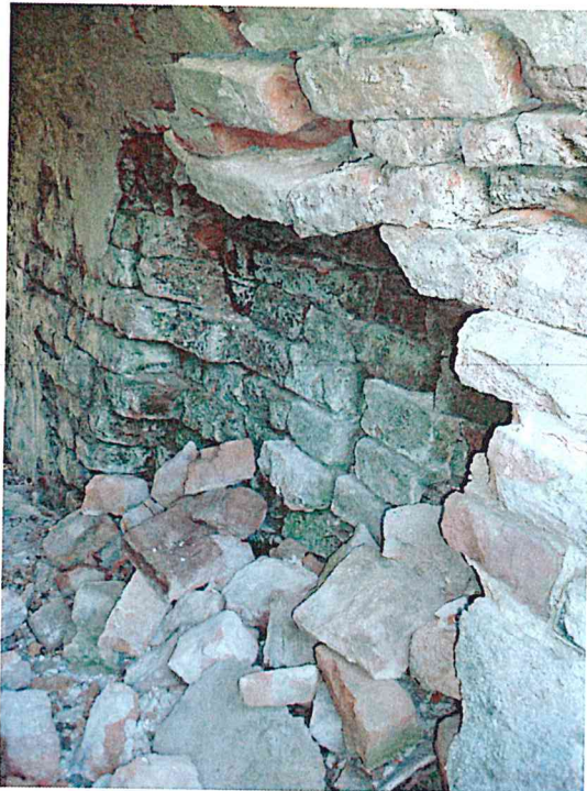
FOTO 3. Perete cărămidă prăbușit
