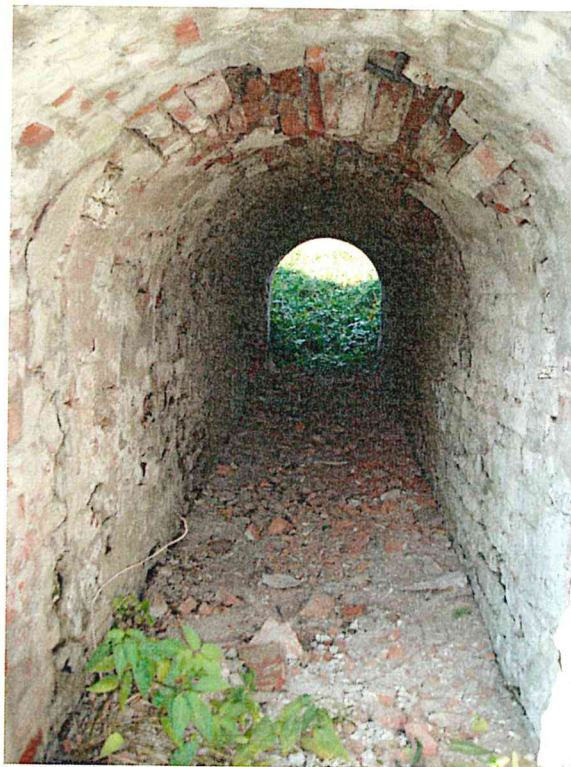
FOTO 5. Boltă și pereu degradate
